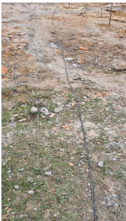
Figura 2 – Fiação passando pela obra
