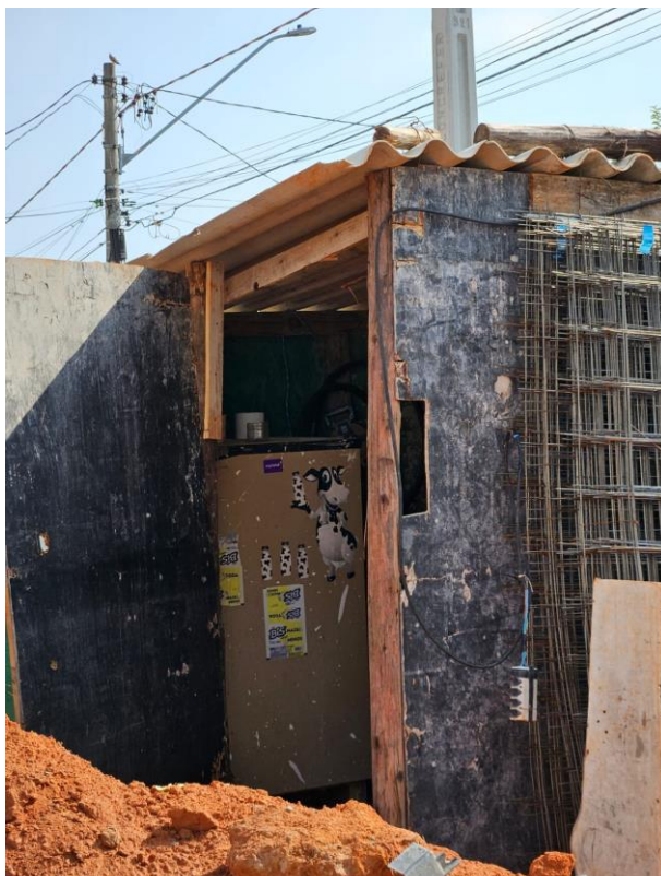
Figura 6 – Instalação elétrica e hidrossanitário
