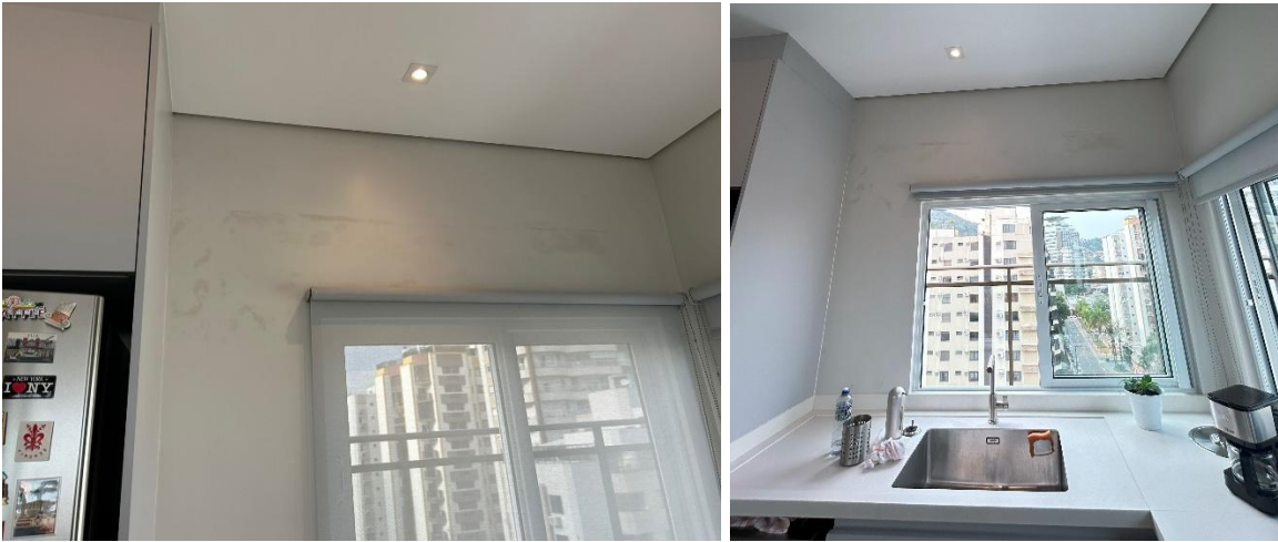
Figura 16: Imagens da Patologia A durante a primeira visita ao apartamento
