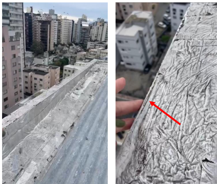
Figura 21: Placa cimentícia por fora da manta impermeabilizante no telhado
