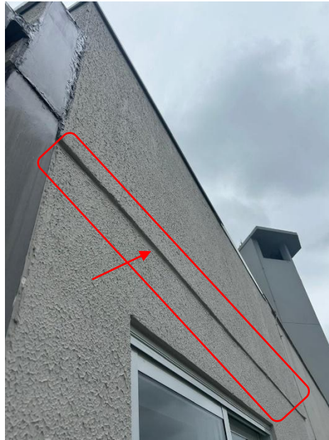
Figura 20: Emenda entre a placa cimentícia e a alvenaria
