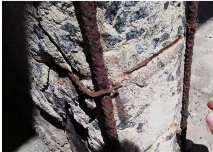
Figura 07 – Corrosão da armadura de um pilar
