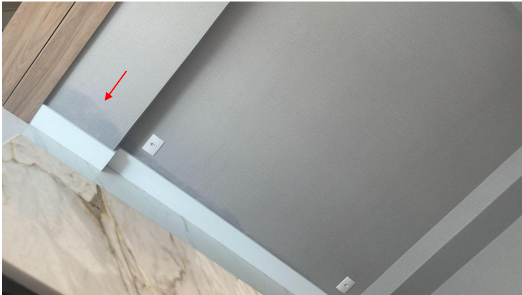
Figura 31: Parede da clínica apresentando umidade ascendente
