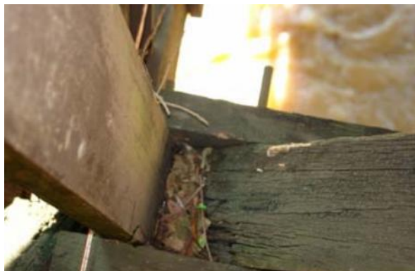
Figura 08 – Biodeterioração da madeira por fungos
