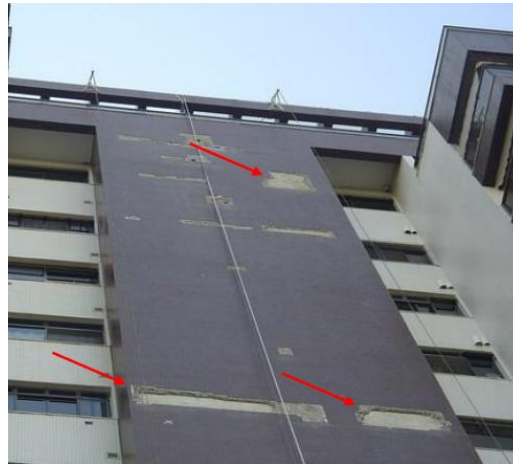
Figura 06 – Deslocamento de pastilhas da fachada de um edifício
