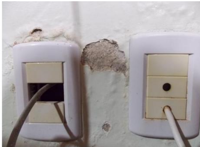
Figura 05 – Formação de bolhas e descamação da pintura devido a umidade
