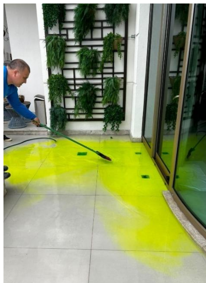
Figura 47: Segundo teste de estanqueidade feito com novo corante UV
