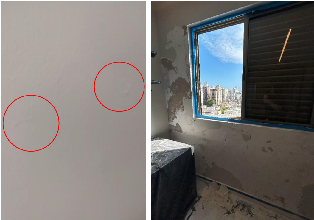
Figura 19: Patologia B localizada no escritório
