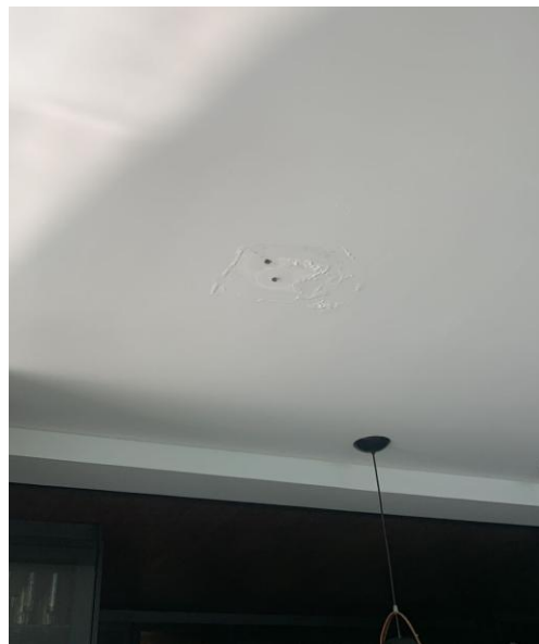
Figura 39: Patologia no apartamento inferior
