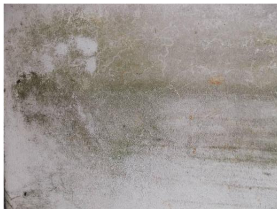
Figura 03 – Desenvolvimento de mofo por conta da umidade
