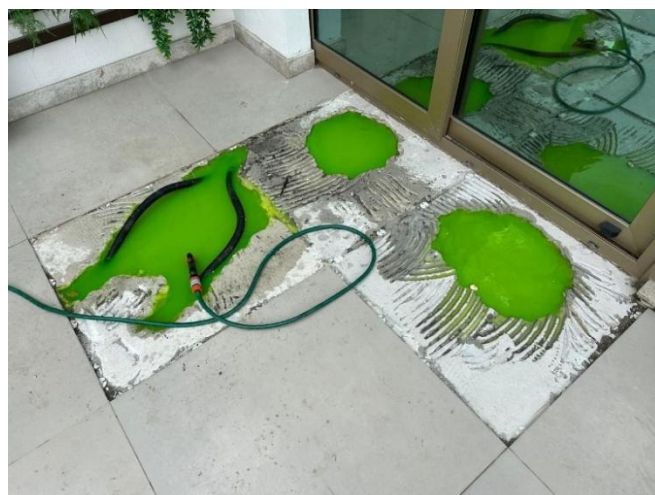
Figura 50: 3º teste de estanqueidade feito com corante UV sobre a nova impermeabilização
