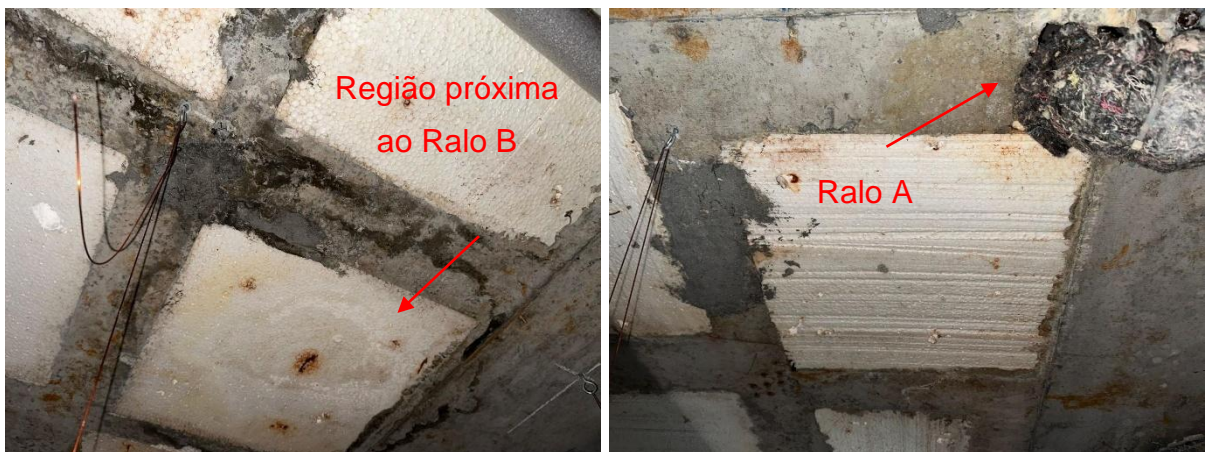
Figura 48: Infiltração persistente em duas localidades próximas ao Ralo A e B
