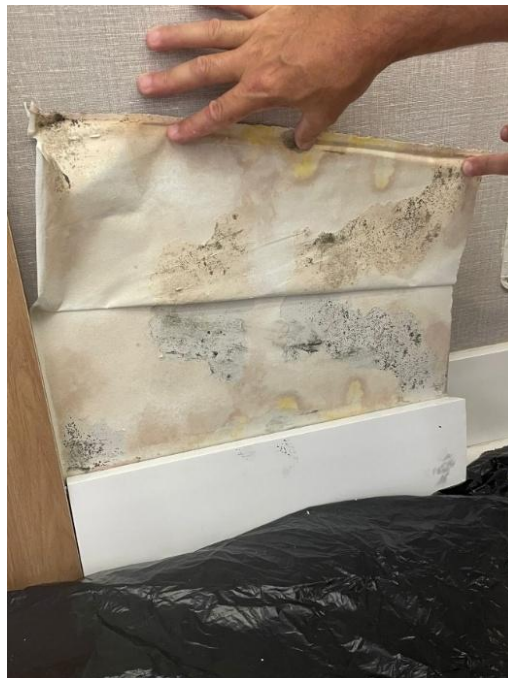
Figura 35: Presença de mofo por trás do papel de parede
