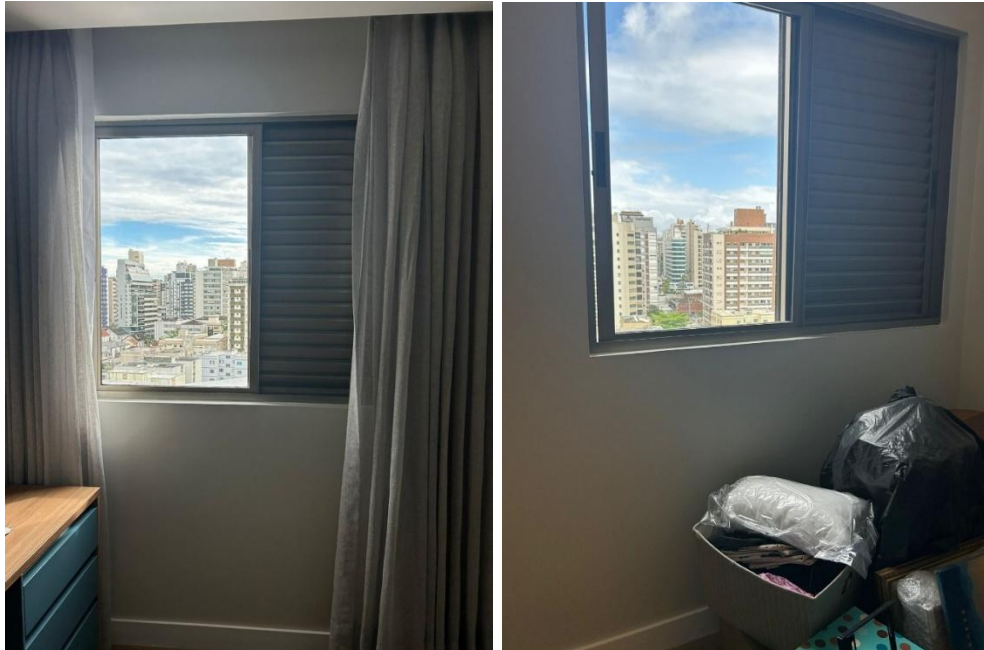
Figura 28: Paredes do escritório e quarto de hóspedes após o monitoramento
