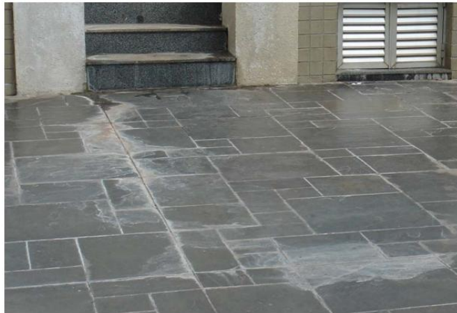
Figura 04 – Eflorescencia no piso cerâmico
