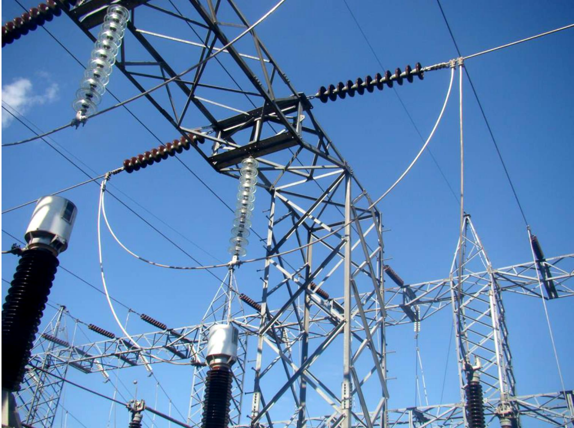
Figura 23 - Instalação modificada dos TPs do barramento principal
