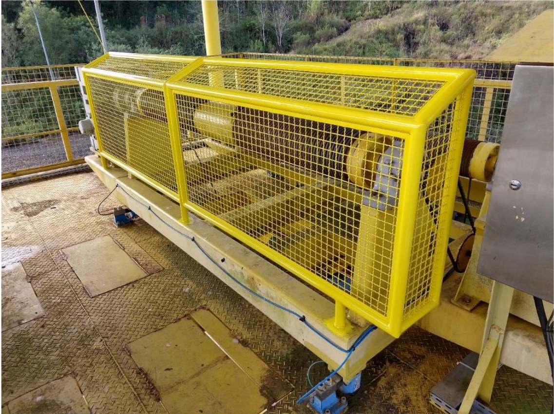
Figura 20 - Proteções das partes móveis da máquina limpa-grades
