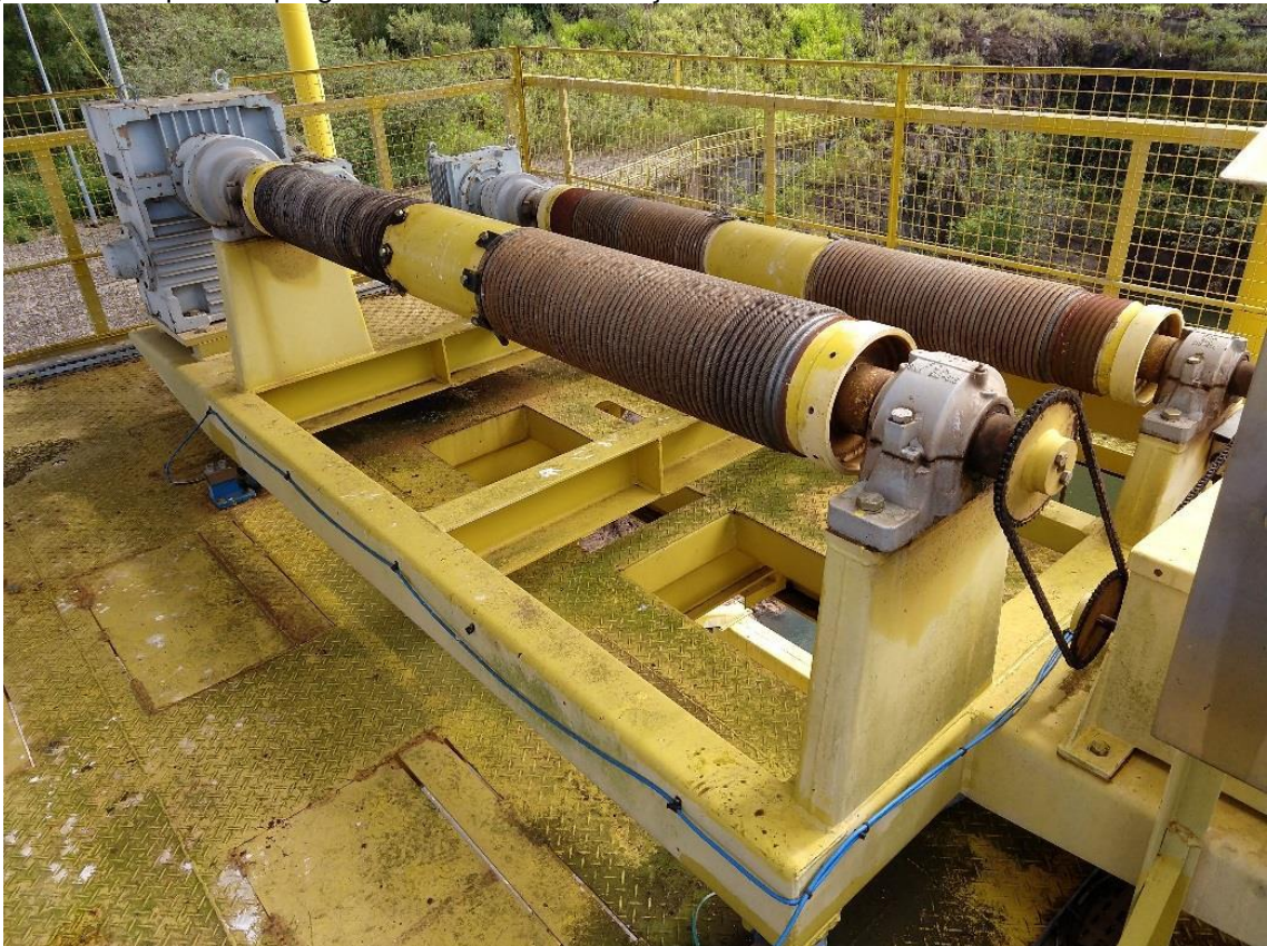
Figura 19 - Máquina limpa-grades antes da modificação
