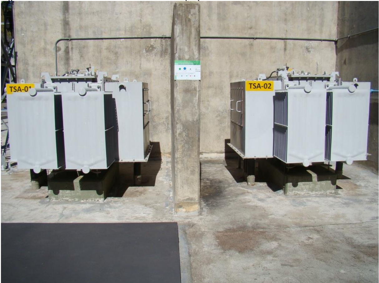
Figura 25 - Transformadores de SA antes da adequação
