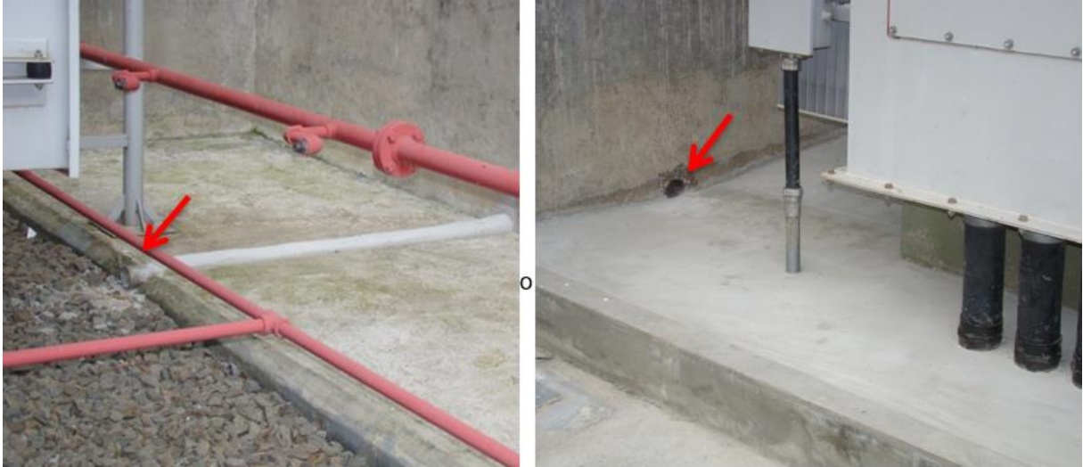
Figura 27 - Tubulação de direcionamento da bacia de contenção
