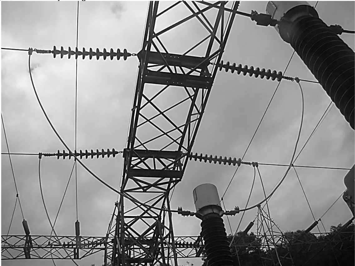
Figura 22 - Instalação original do TP do barramento principal
