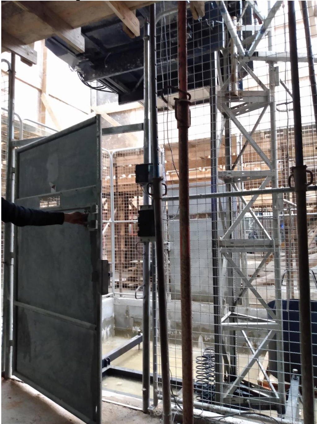
Figura 16 – Vista externa do elevador de carga
