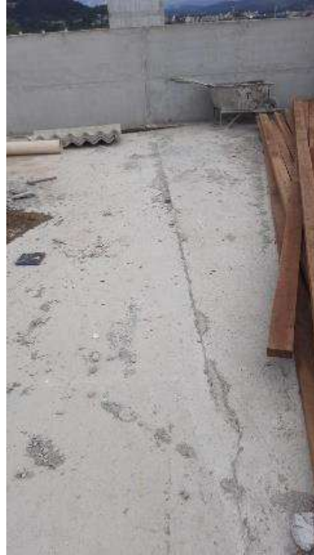
Figura 19 – Junta fria pela emenda entre ciclos de concretagem.
