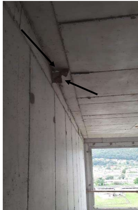
Figura 9 – Rebarba de concreto
