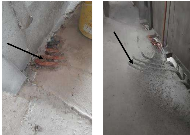
Figura 13 – Eletroduto aparente na laje, item “a” e “b”.
