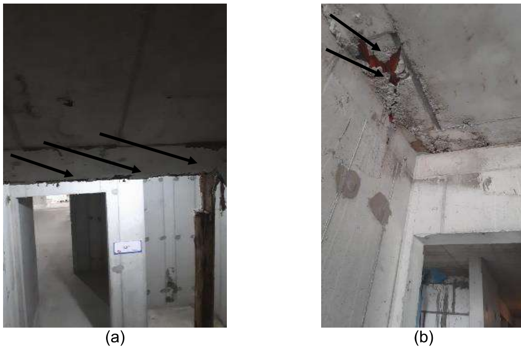
Figura 5 – Defeito superficial encontro de teto e parede: a) “bicheira” na escada e b) “bicheira” no encontro de laje e parede.
