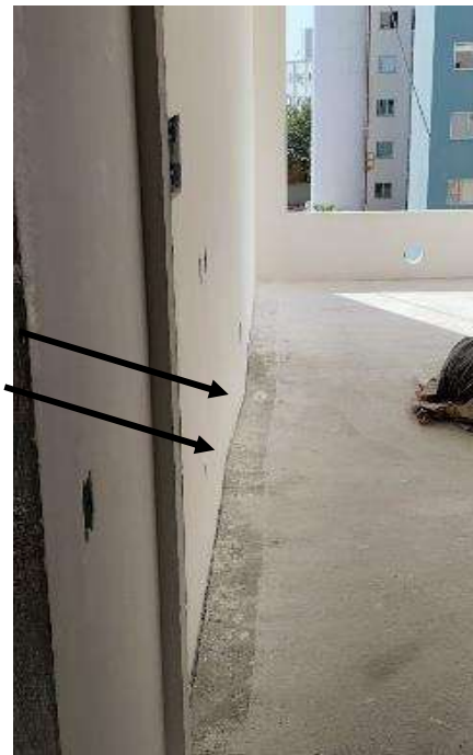
Figura 22 - Parede com deformação.
