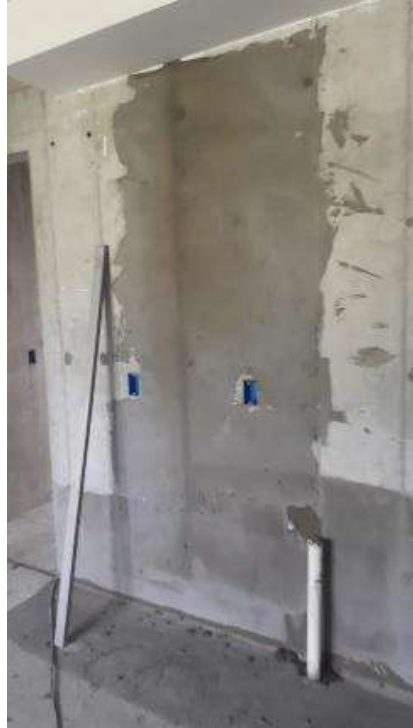
Figura 27 – Parede fora de alinhamento.
