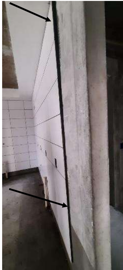
Figura 26 – Parede fora de prumo.
