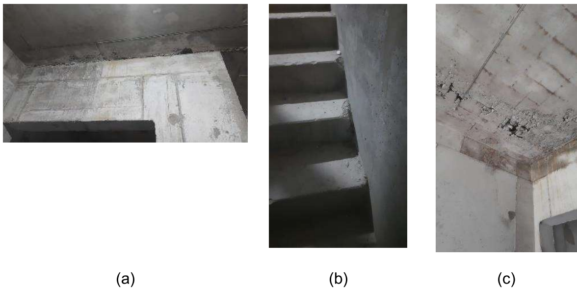
Figura 6 – Defeitos superficiais: a) “bicheira” no encontro laje e parede, b) “bicheira” no degrau da escada, c) “bicheira” no teto.
