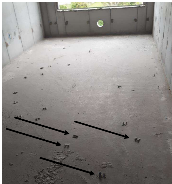
Figura 8 - Espaçadores aparentes na laje.
