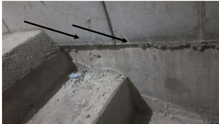
Figura 20 - Desalinhamento das paredes entre pavimentos.
