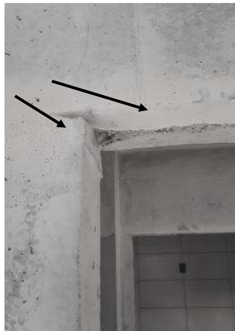
Figura 21 – Vão de uma porta com altura inadequada.
