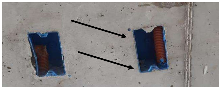
Figura 16 - Caixa de passagem elétrica torta.
