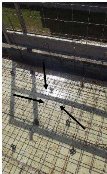
Figura 28 – Defeito na forma da laje verificado antes da concretagem
