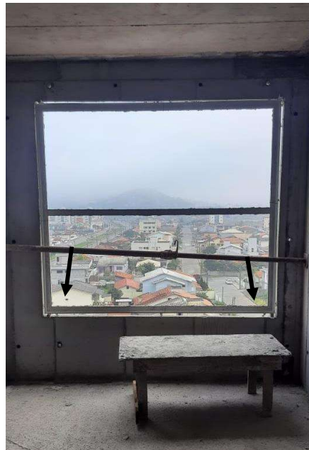
Figura 25 – Vão para a esquadro da janela fora de nível
