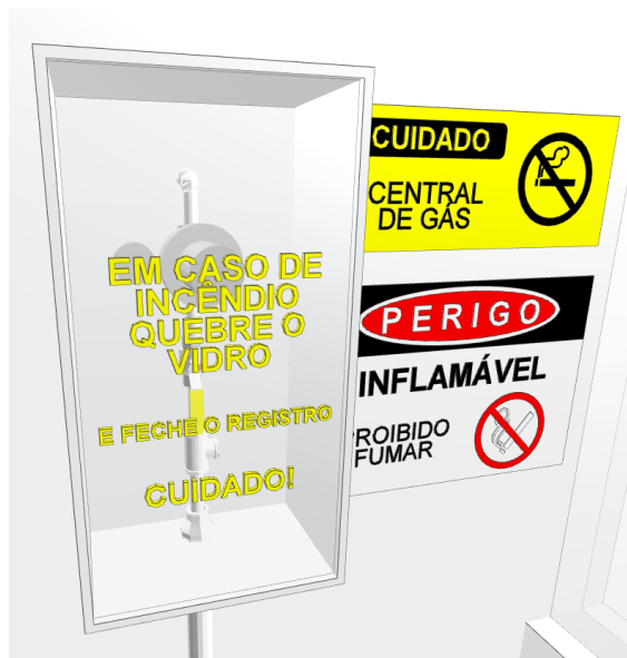
Figura 41 – Conjunto de controle e manobra e placas da central de gás
