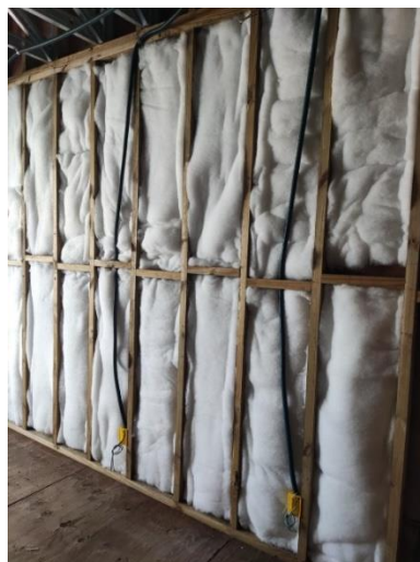
Figura 70 - Isolamento com lã de PET
