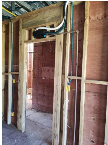
Figura 76 - Instalações de Climatização
