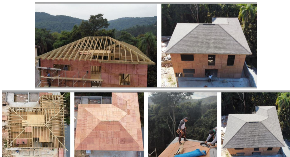
Figura 44 - Execução de telhado com telhas single pela Empresa B no município de Mairiporã
