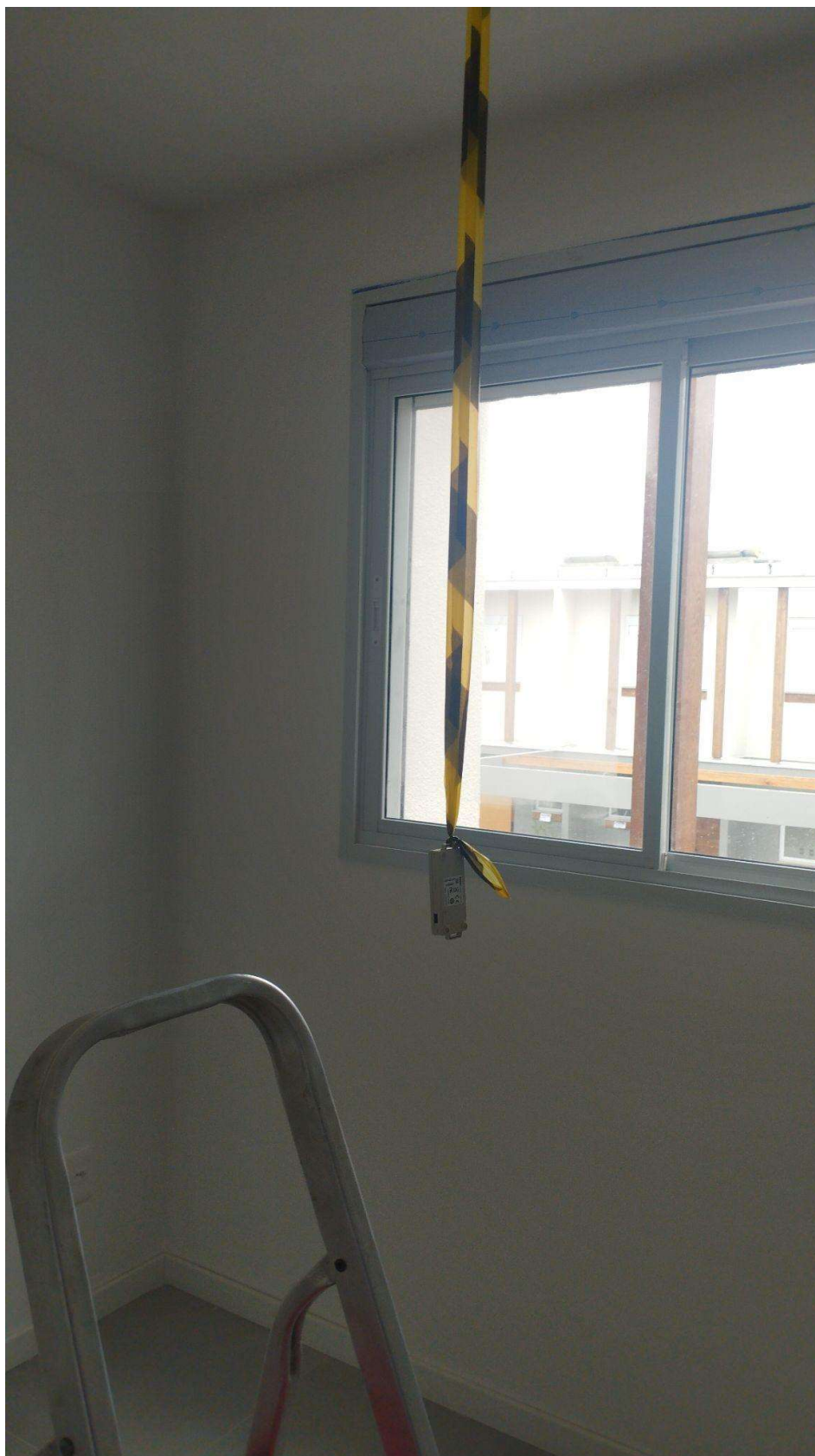
Figura 13 - Quarto norte casa em parede de concreto.
