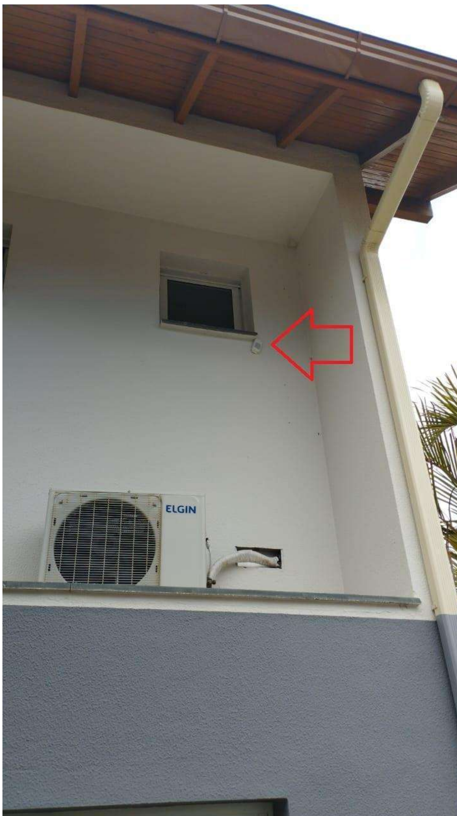
Figura 16 - Datalogger instalado parede sul casa em alvenaria.
