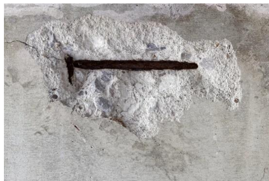
Figura 32. Porção externa da fundação – armadura exposta e corrosão.
