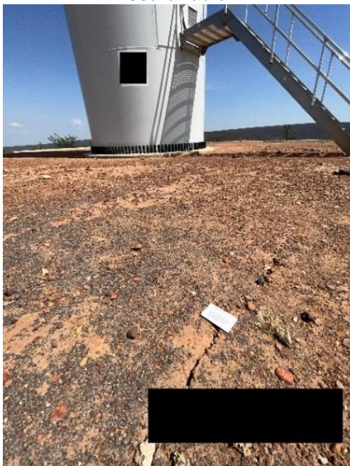
Figura 34. Pavimento de reaterro – fissura radial.
