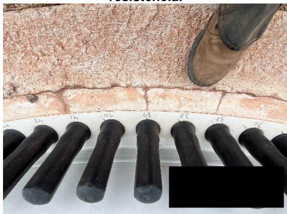
Figura 26. Porção externa da fundação de um aerogerador – fissuras no graute de alta resistência.
