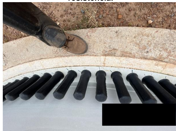
Figura 27. Porção externa da fundação de um aerogerador – fissuras no graute de alta resistência.
