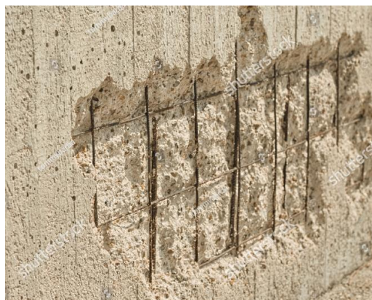
Figura 30. Porção externa da fundação – deslocamento.
