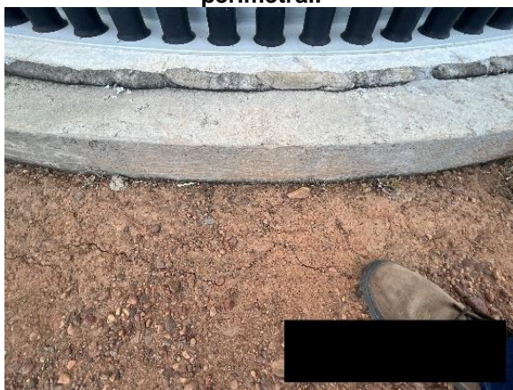
Figura 36. Pavimento de reaterro – fissura perimetral.
