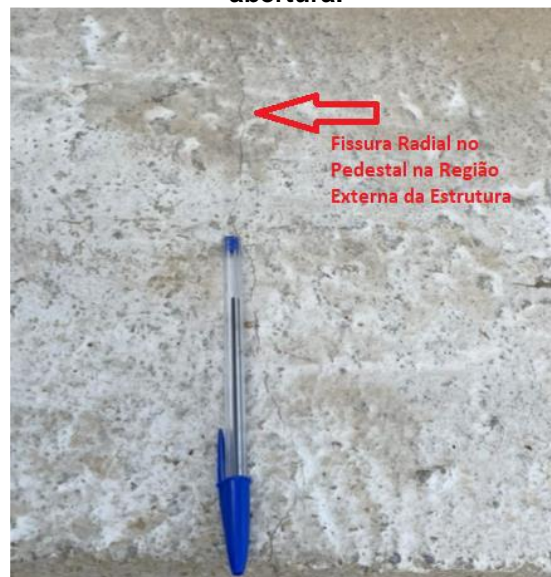
Figura 25. Porção externa da fundação de um aerogerador – fissura radial de pequena abertura.
