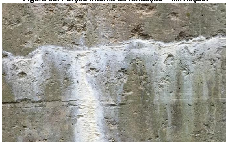
Figura 33. Porção interna da fundação – lixiviação.
