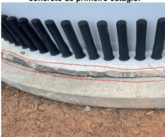
Figura 28. Porção externa da fundação de um aerogerador – desnível entre o graute e o concreto de primeiro estágio.
