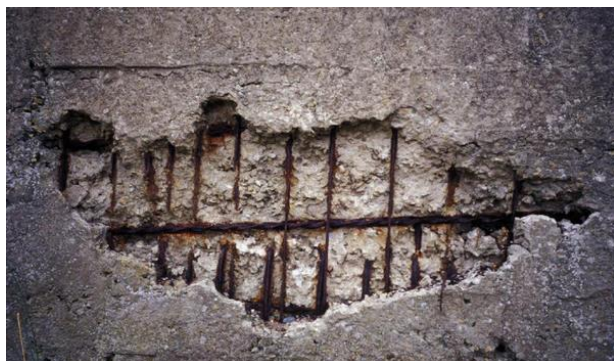
Figura 31. Porção externa da fundação – armadura exposta e corrosão.
