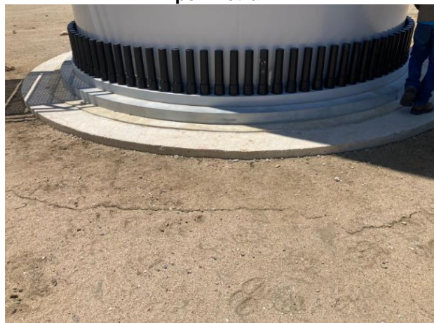
Figura 35. Pavimento de reaterro – fissura perimetral.
