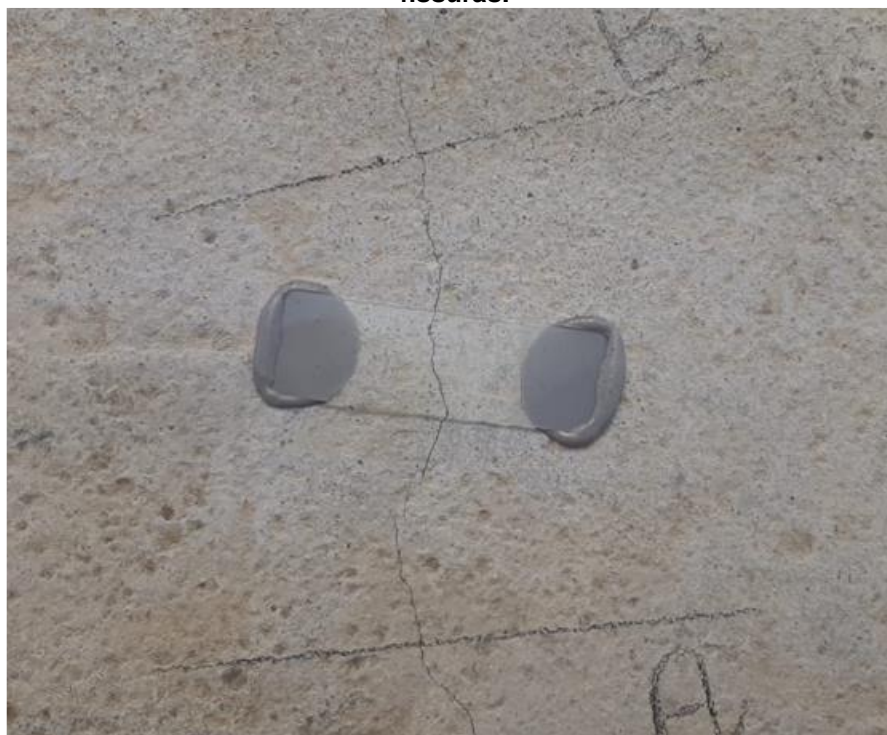
Figura 42. Instalação de lamínula de vidro para monitoramento da atividade ou passividade de fissuras.
