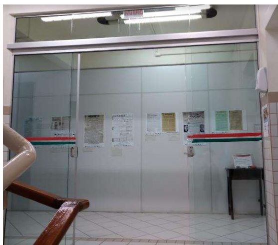
Figura 25 – Porta de correr que serve de acesso a escada da rota de fuga junto ao corredor de circulação
