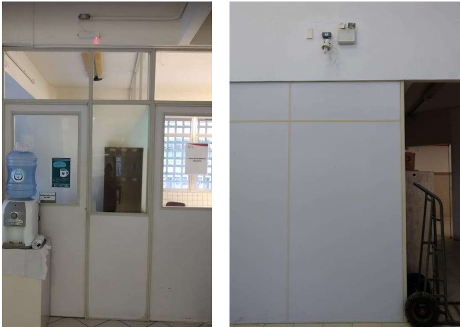
Figura 20 – Luminárias de emergência fixadas em viga aparente, imediatamente acima das aberturas
