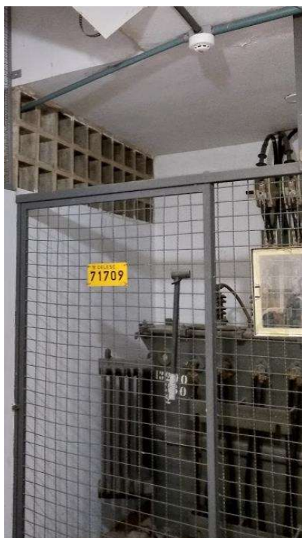
Figura 39 – Detector de fumaça na casa de força elétrica
