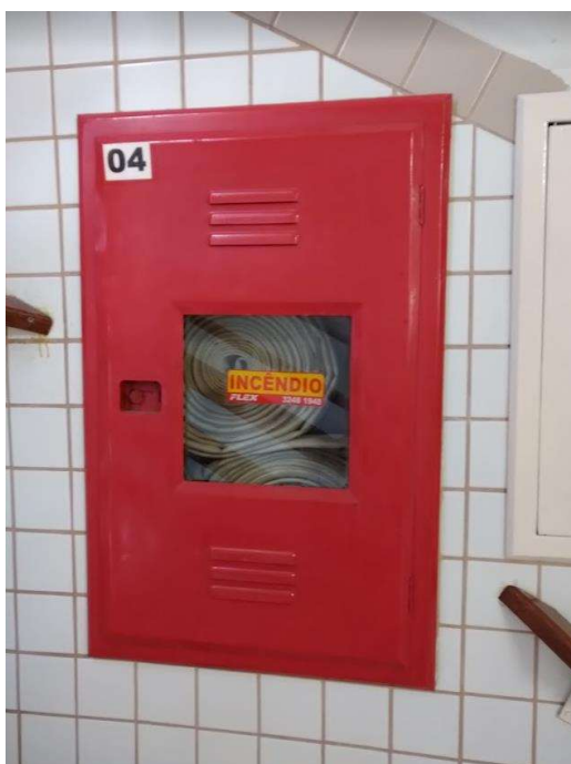
Figura 41 – Hidrante em abrigo instalado na parede do lanço da escada
