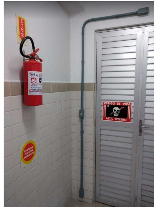
Figura 15 – Extintor próximo dos transformadores (ID 17)
