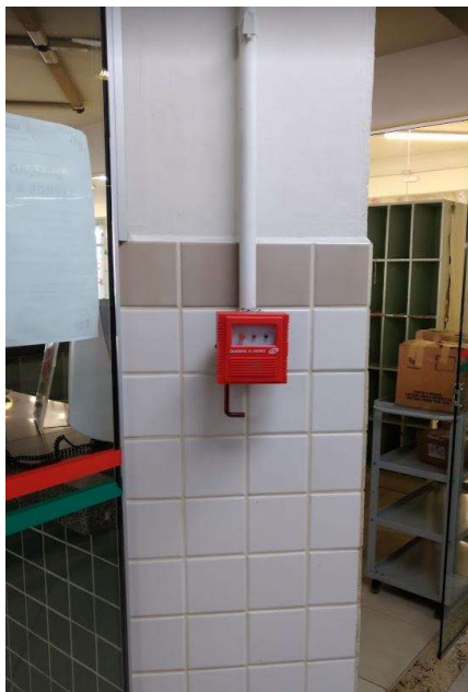
Figura 31 – Acionador manual na circulação do térreo
