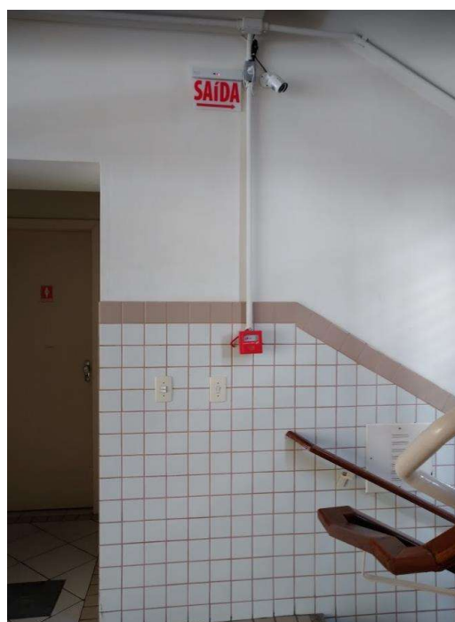
Figura 23 – Placa de sinalização de abandono na mudança de direção do corredor para a escada
