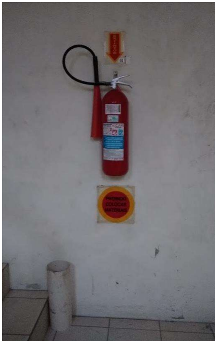
Figura 14 – Extintor próximo a casa de máquinas (ID 01)
