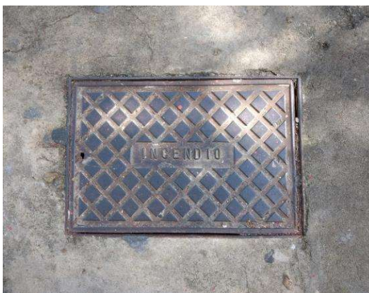
Figura 42 – Hidrante de recalque enterrado em passeio
