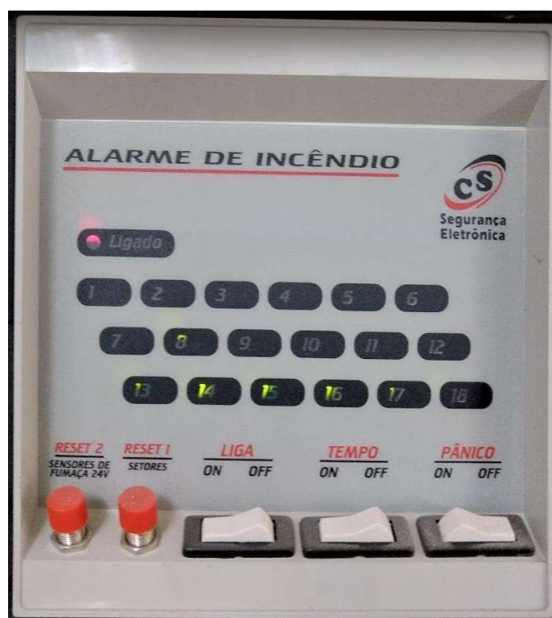
Figura 36 – Central de alarme de incêndio sem tampa protetora
