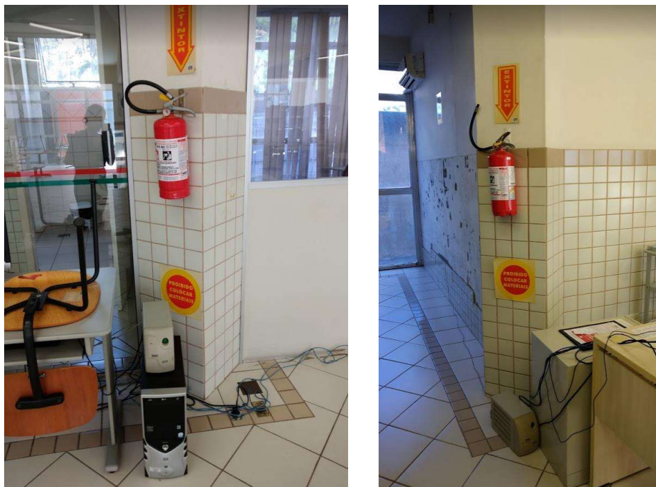
Figura 17 – Depósito de materiais abaixo de extintores no 1º Pavimento
