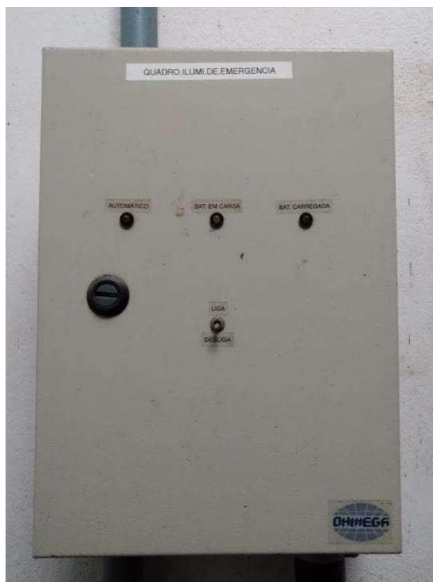
Figura 19 – Quadro de iluminação de emergência
