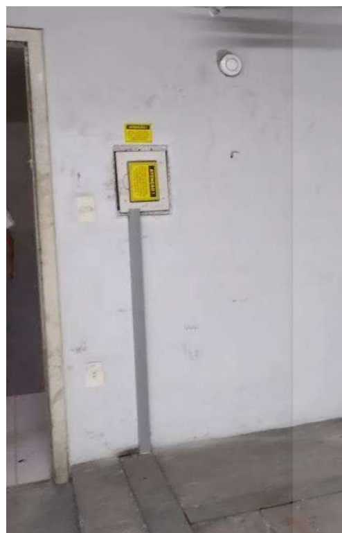
Figura 40 – Detector de fumaça na casa de máquinas
