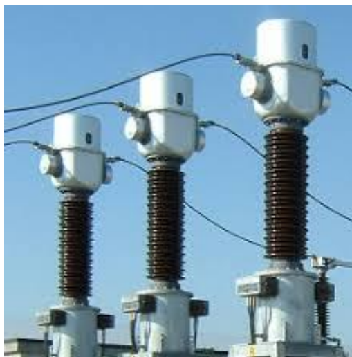
Figura 15 - Transformador de corrente de AT do tipo bucha
