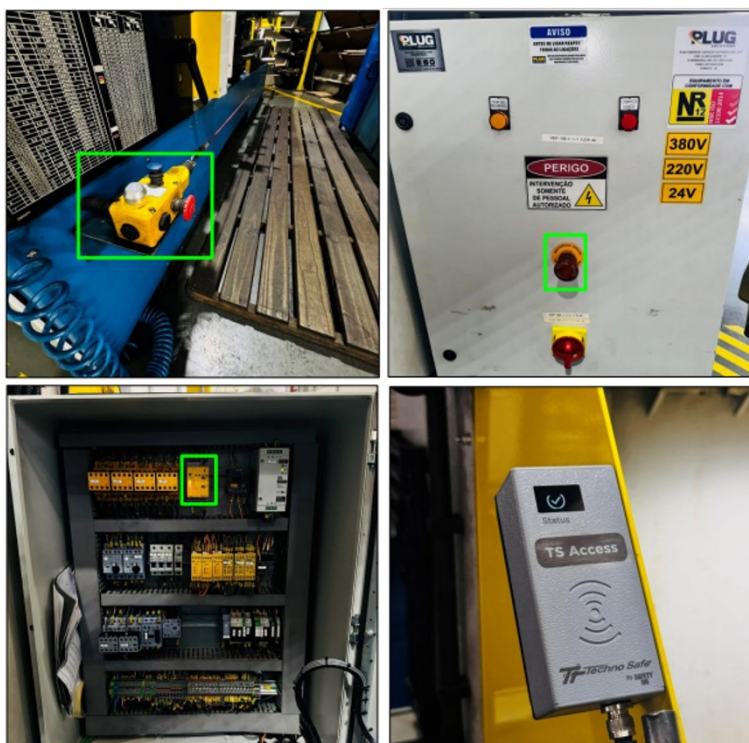
Imagem 3 – Principais melhorias instaladas.
