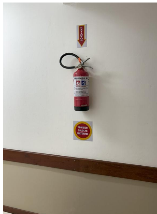
Figura 25 - Extintor corredor primeiro pavimento
