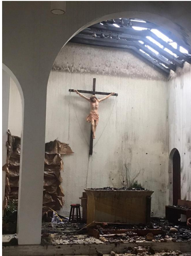
Figura 6 - Igreja de Nossa Senhora dos Navegantes após o incêndio
