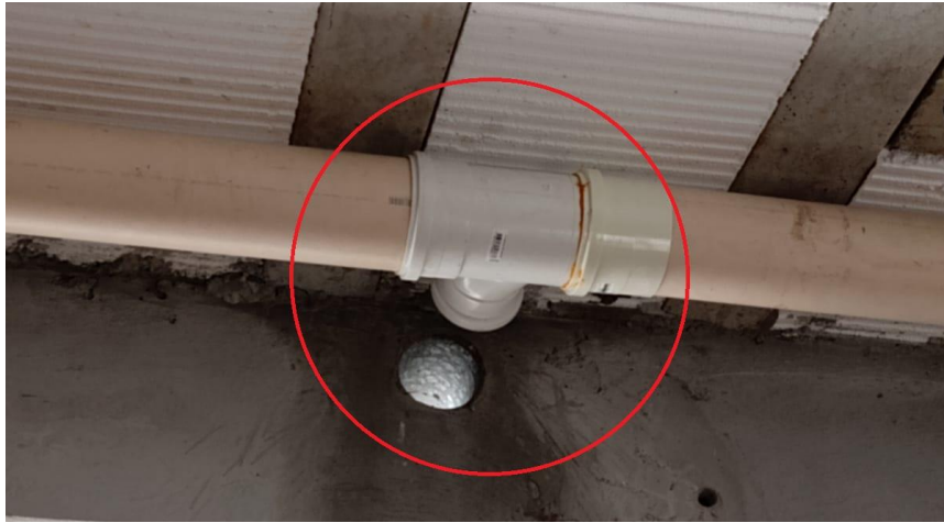
Figura 65 - Furo em viga para passagem de tubo de esgoto
