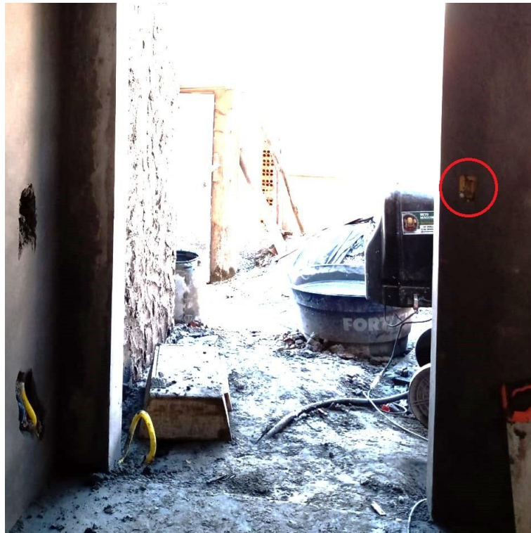
Figura 83 - Correção do interruptor posicionado no pilar da porta de entrada
