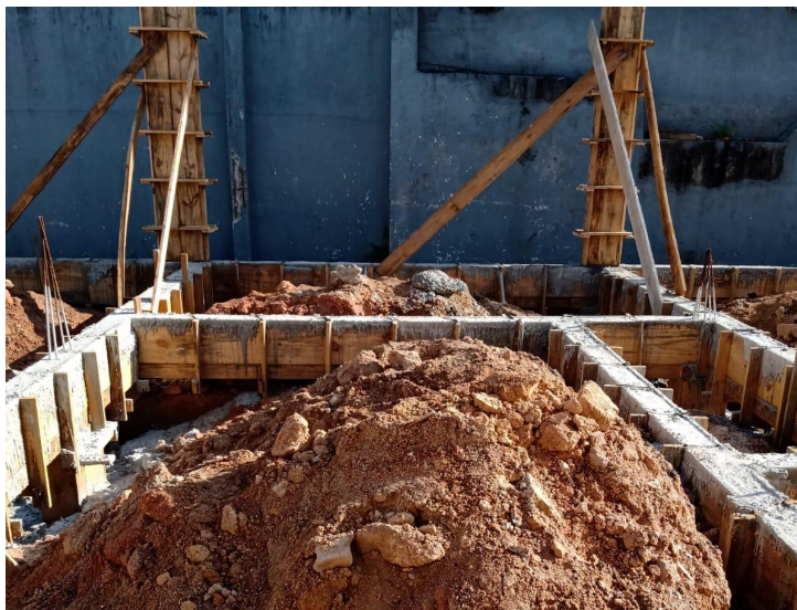
Figura 47 - Inconsistência: falta de viga baldrame
