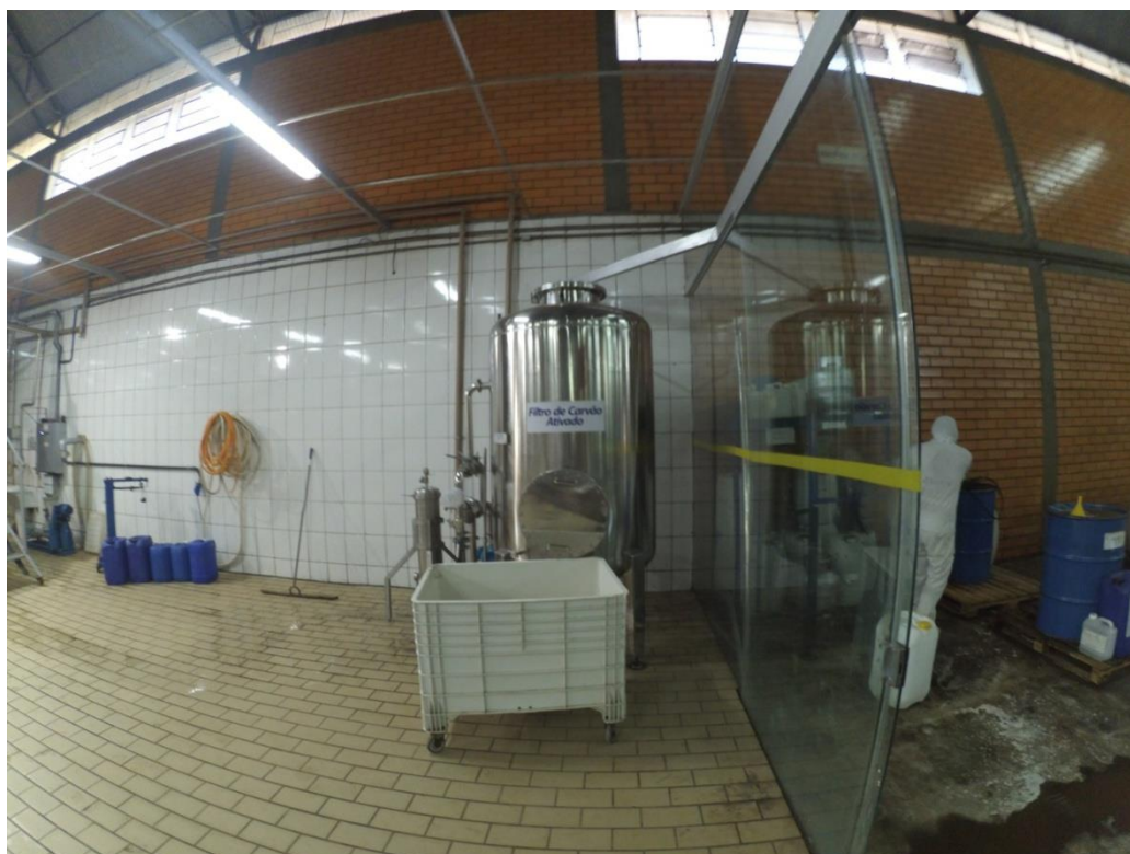
Figura 9: Sistema de purificação de água
