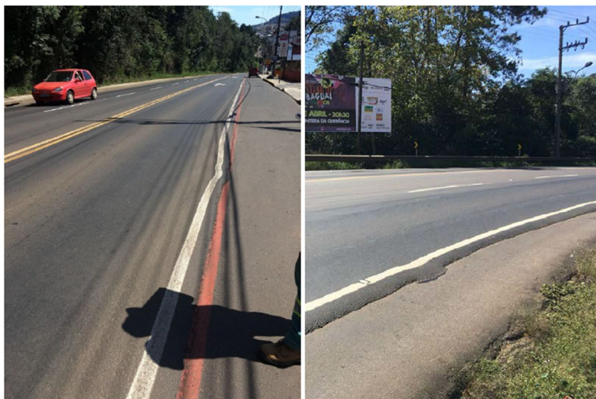
Figura 48 - Exsudação e Escorregamento
