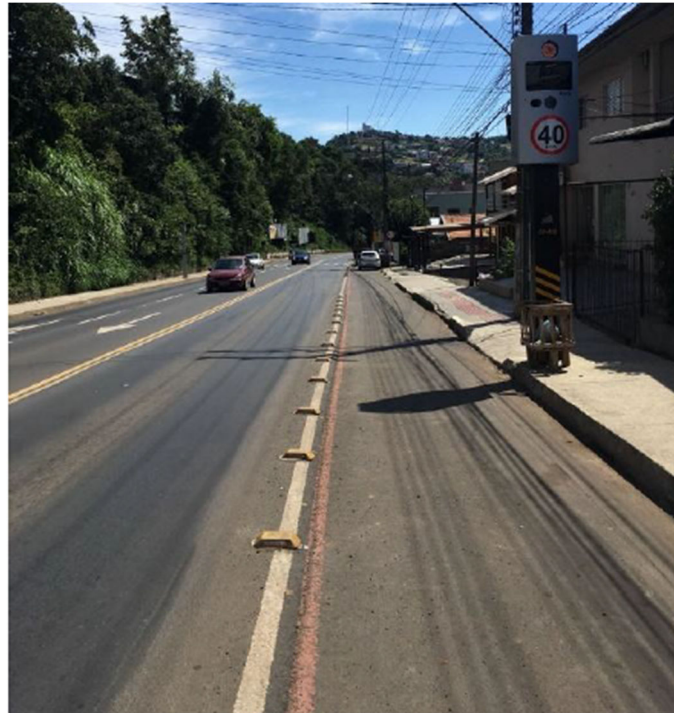
Figura 46 - Afundamento de trilha de roda
