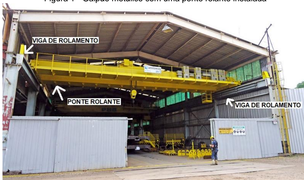
Figura 1 - Galpão metálico com uma ponte rolante instalada
