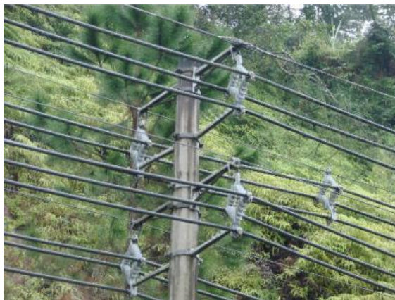
Figura 3 – Rede de distribuição aérea compacta
