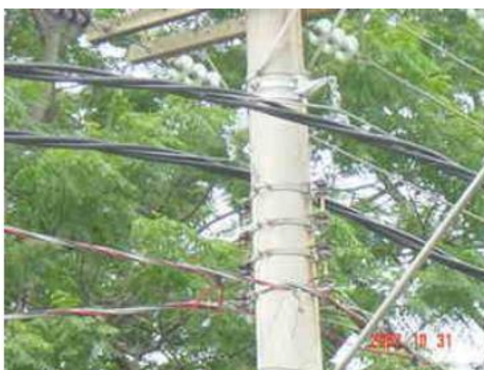
Figura 4 – Rede de distribuição aérea isolada
