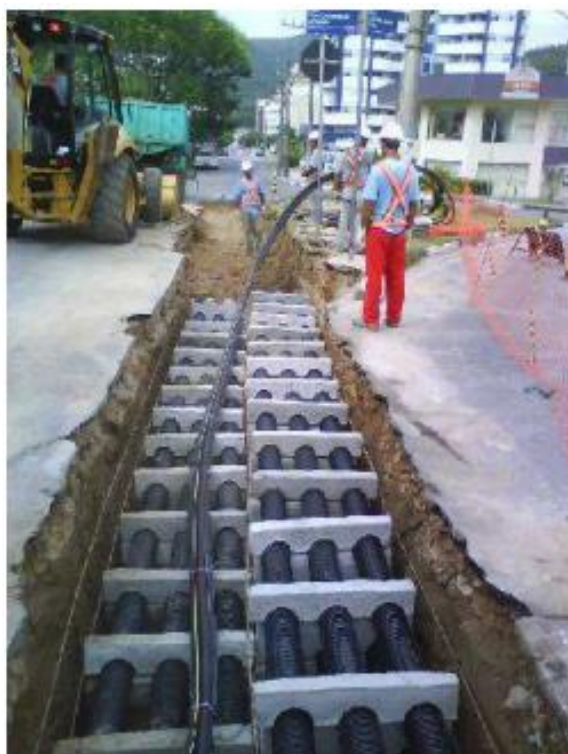
Figura 5 – Rede de distribuição subterrânea
