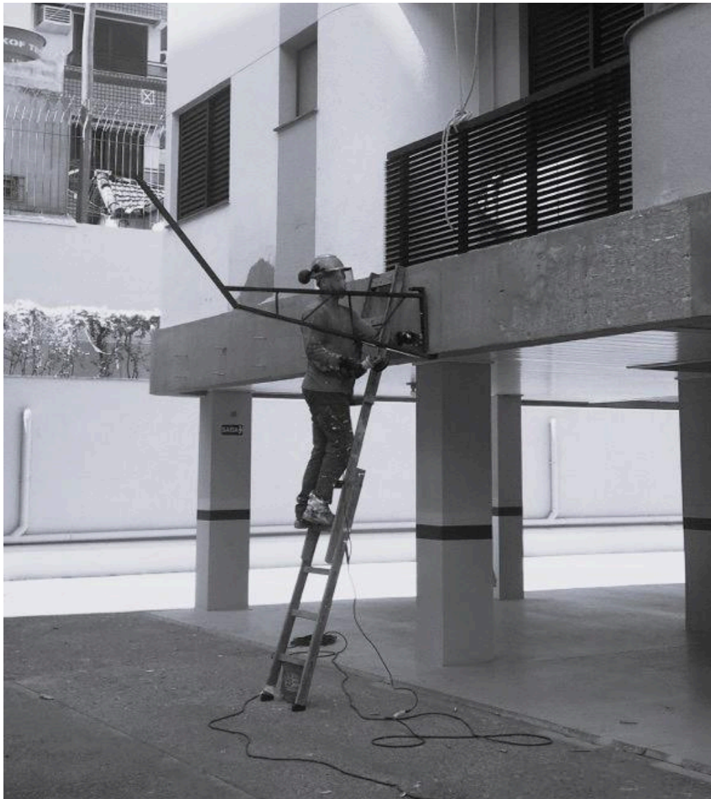
Figura 27 - Trabalhador em escada para instalação de bandeja de proteção em empreendimento situado no Centro de Florianópolis/SC
