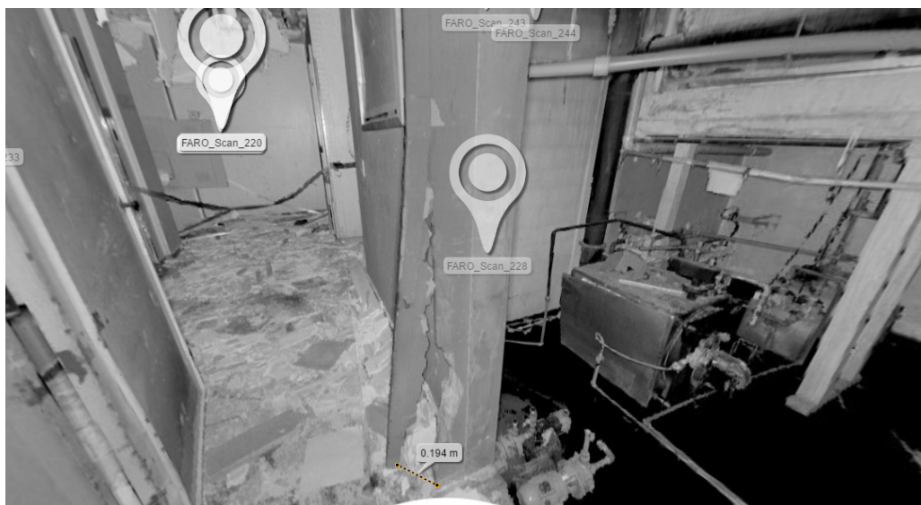
Figura 30 - Porta corta-fogo que antecede a zona de origem
