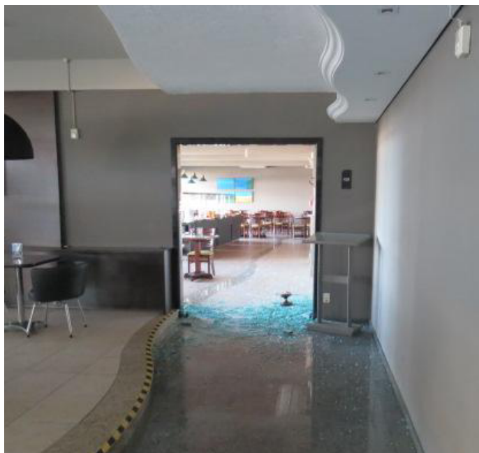
Figura 33 - Porta de vidro quebrada
