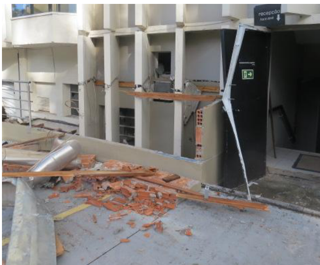
Figura 39 - Vista do guarda corpo colapsado
