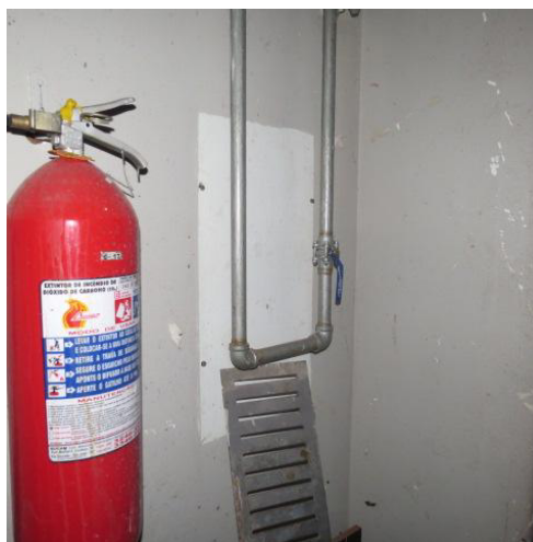
Figura 29 - Registro de corte do GLP do gerador de água quente
