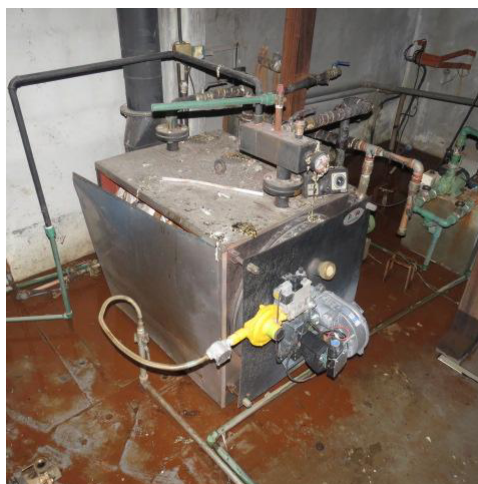
Figura 36 - Gerador de água quente
