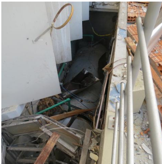
Figura 38 - Acumulador de água quente visto da laje da garagem externa
