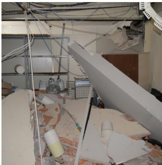
Figura 23 - Foto da parede colapsada
