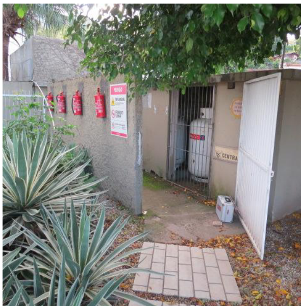
Figura 40 - Central de GLP
