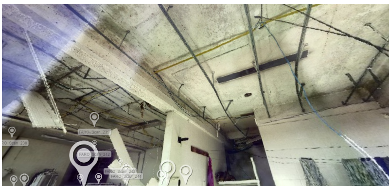
Figura 19 - Teto da lavanderia visto de costas para janela frontal
