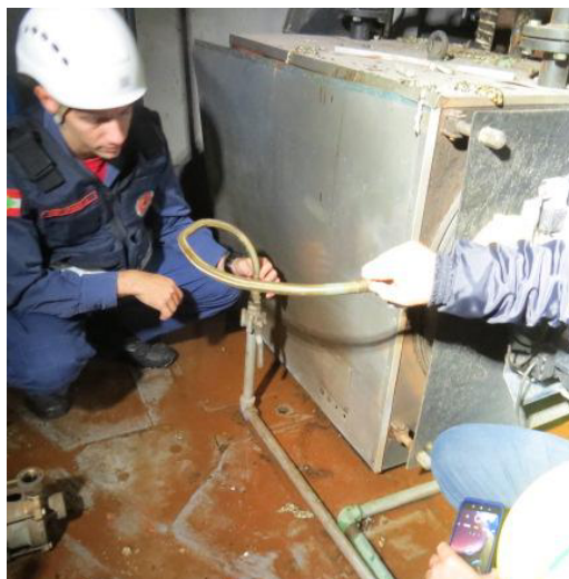
Figura 42 - Tubulação de GLP pelo piso do ambiente abaixo da cota do subsolo
