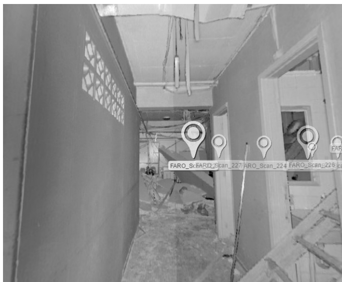
Figura 22 - Vista do corredor para a parede colapsada
