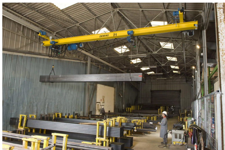
Figura 2 - Ponte Rolante Suspensa
