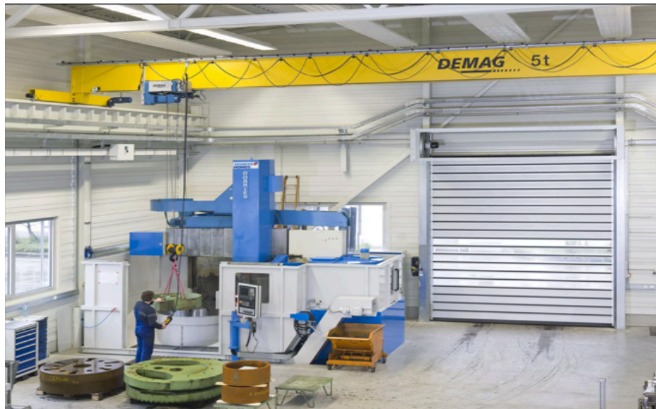
Figura 1 - Ponte rolante apoiada.
