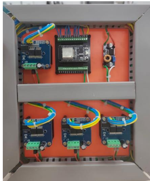
Fig. 13. Painel elétrico montado
