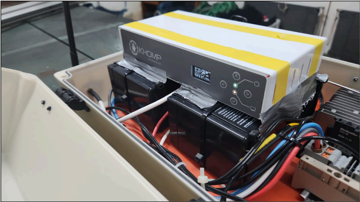
Imagem 71 – GW portátil posicionado no telhado da Secretaria de Pesca de Bombinhas
