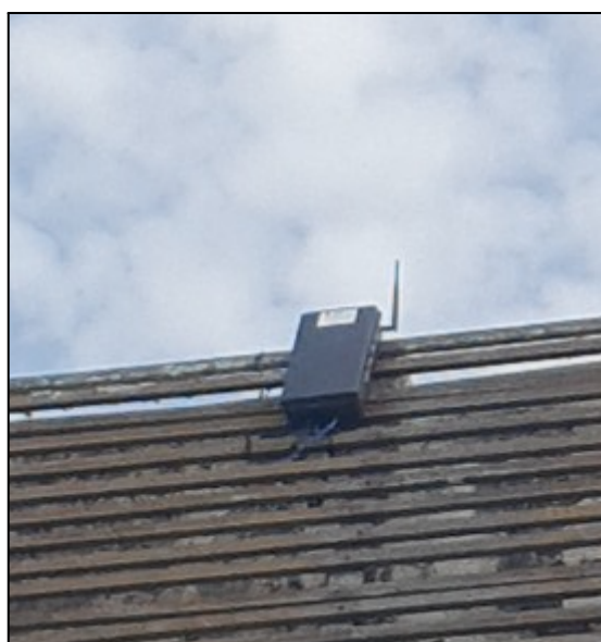
Imagem 36 – Gateway instalado no telhado da Rádio Costeira
