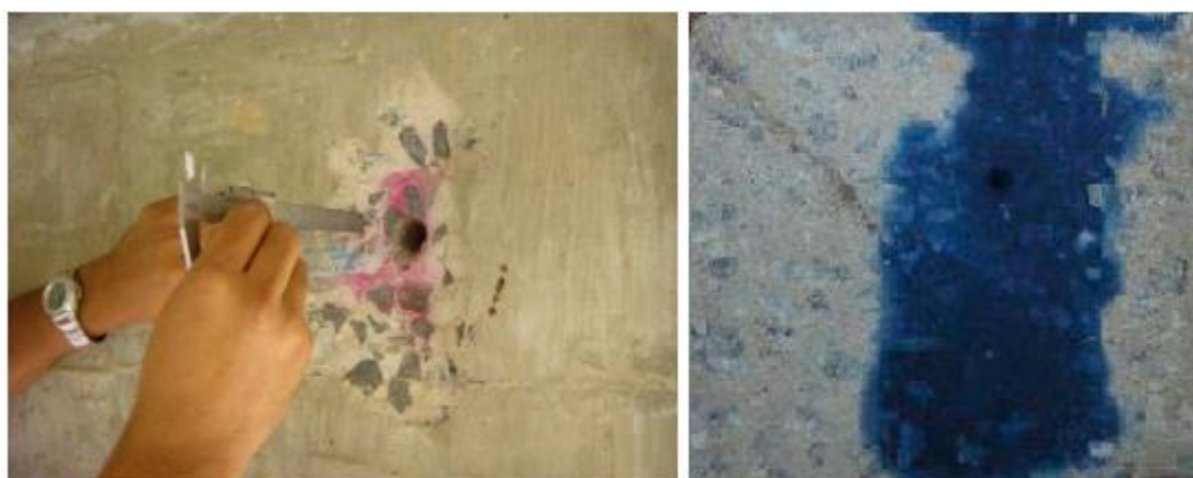
Figura 13 – Medidas de carbonatação com soluções de fenolftaleína e timolftaleína
