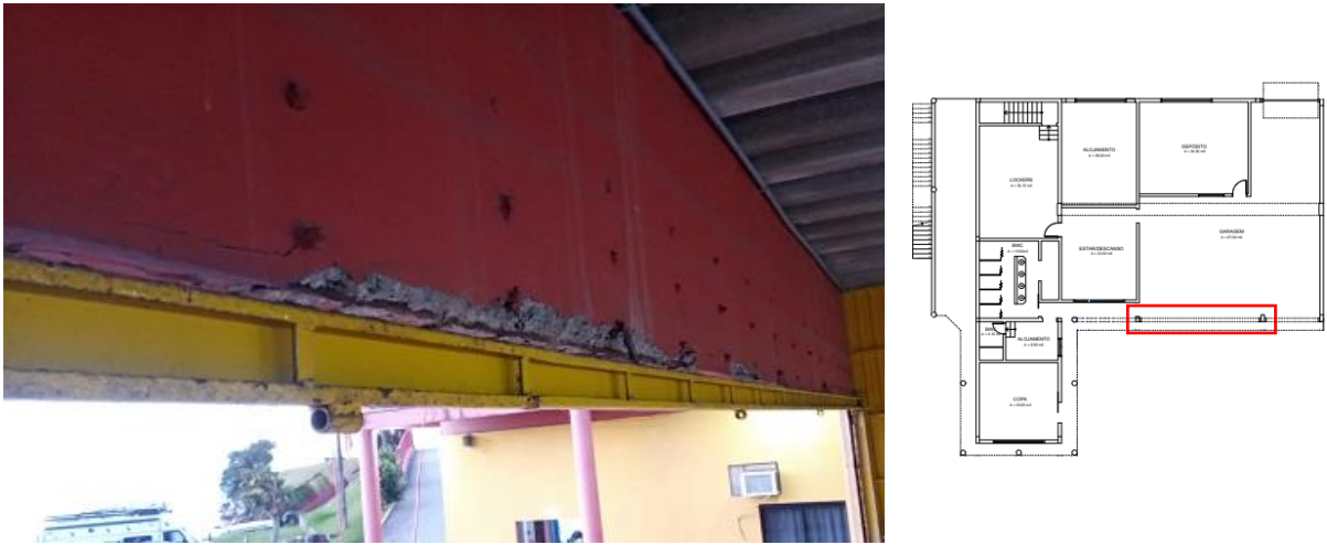
Figura 26 – Parte traseira da viga da fachada noroeste da edificação
