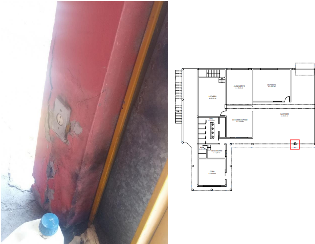
Figura 29 – Parte traseira do pilar central da fachada noroeste da edificação
