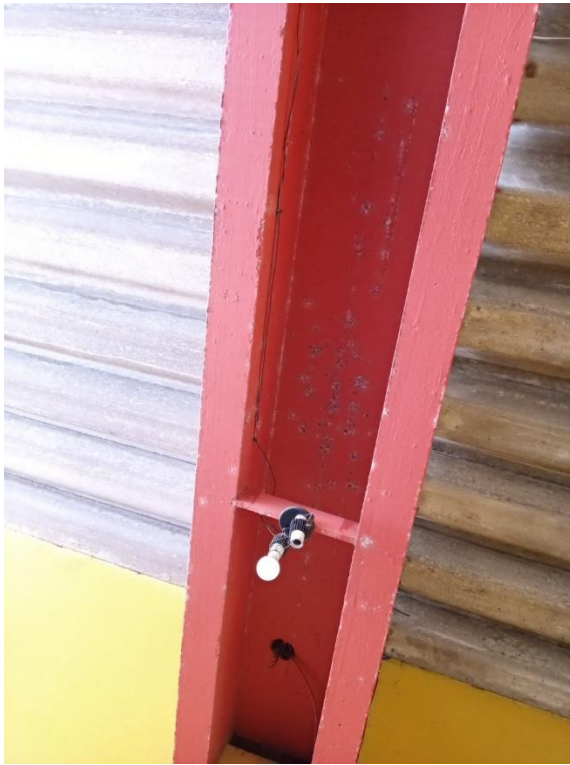
Figura 32 – Parte inferior da viga central da garagem
