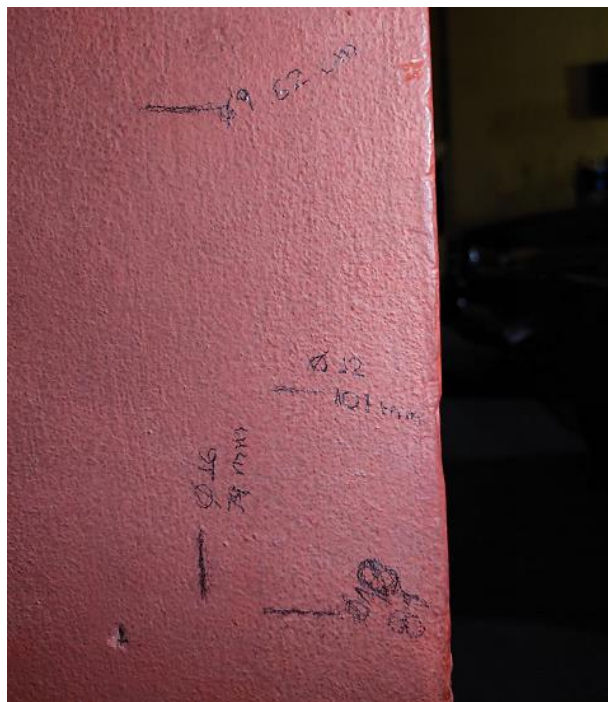
Figura 50 – Marcação da posição, profundidade e bitolas dos vergalhões e estribos do pilar
