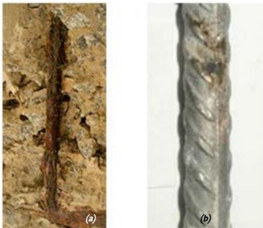
Figura 5 – Aparência superficial da corrosão generalizada pela carbonatação do concreto (a) e puntiforme pela ação de íons cloreto (b)
