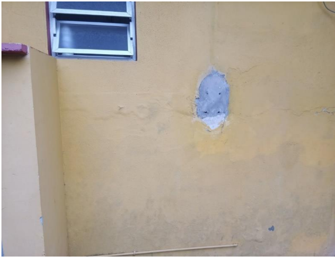
Figura 38 – Parede da lateral oeste da edificação
