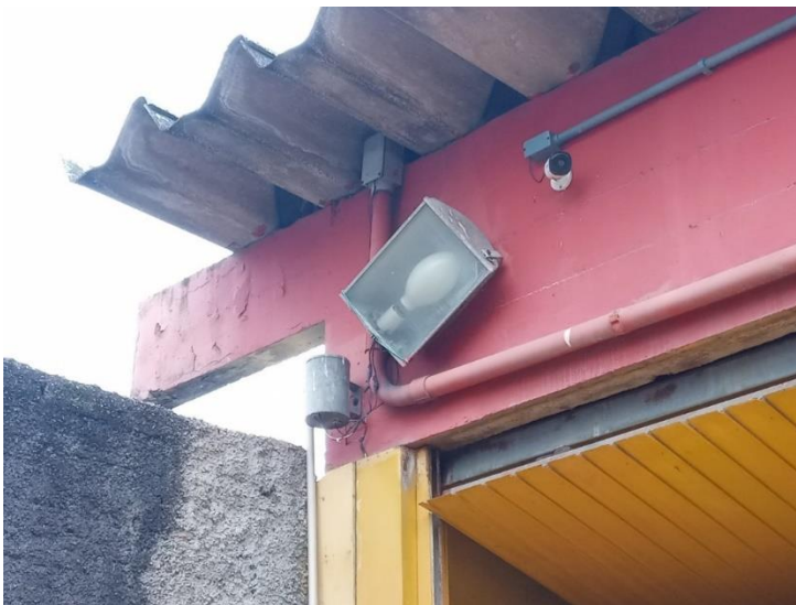
Figura 33 – Extremidade esquerda da viga da fachada sudeste (traseira) da edificação
