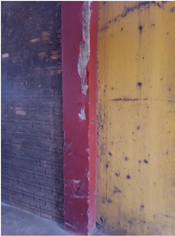
Figura 34 – Pilar da lateral oeste da edificação
