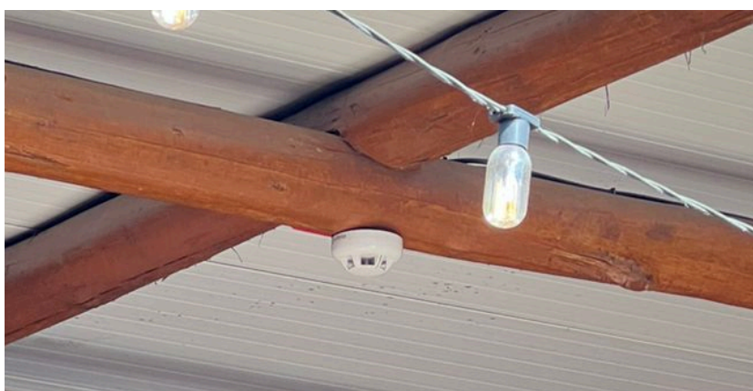
Figura 14– Dispositivo de detecção de fumaça dispostos na edificação
