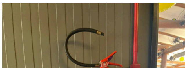
Figura 12 – Um dos extintores dispostos na edificação
