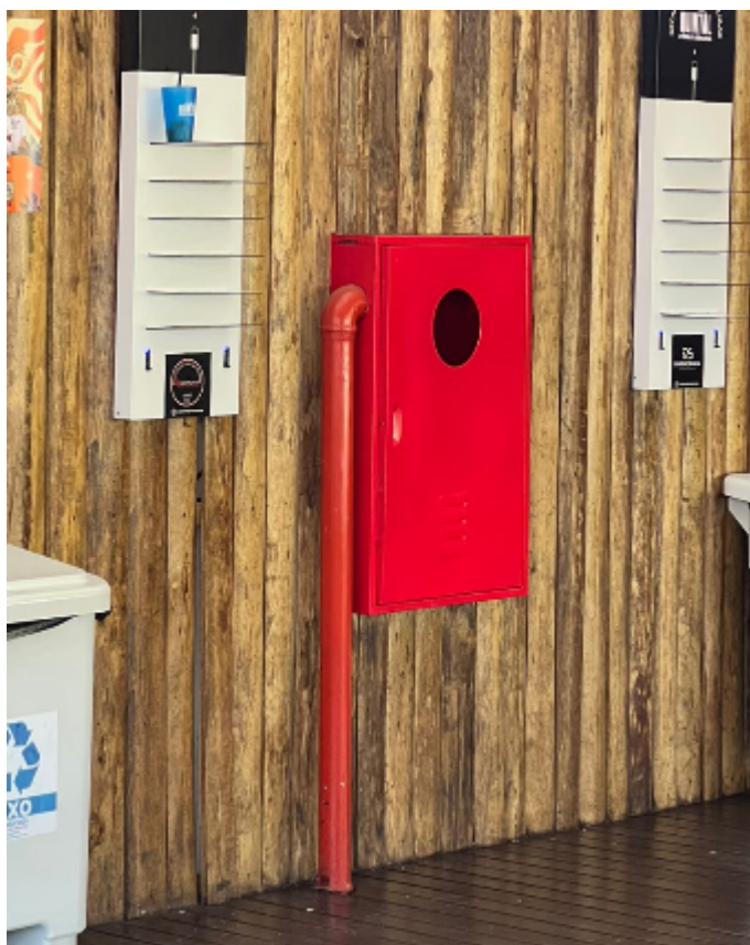
Figura 13 - Um dos hidrantes dispostos na edificação
