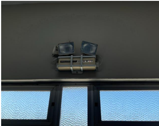
Figura 33 - Bloco autônomo área da escada
