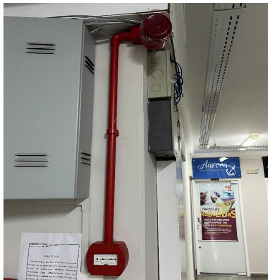
Figura 26 - Alarme de incêndio, sonoro e luminoso
