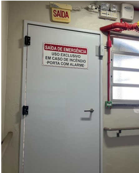
Figura 29 - Saída de emergência 9º Andar
