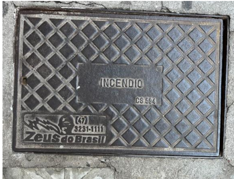
Figura 37 - Hidrante de recalque na entrada do edifício
