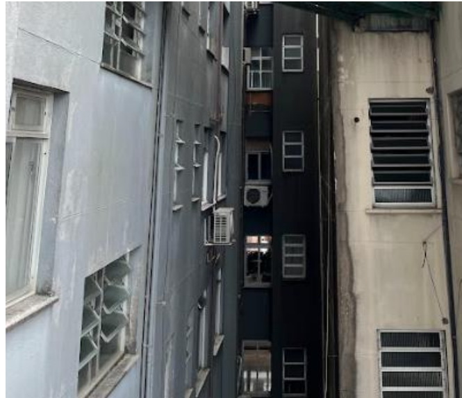
Figura 27 - Afastamento da fachada lateral
