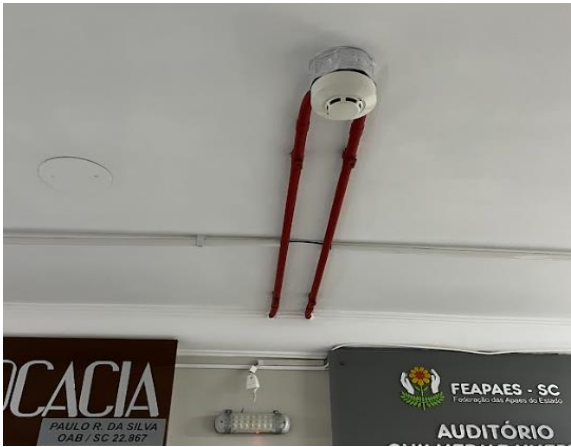
Figura 24 - Detector automático de incêndio
