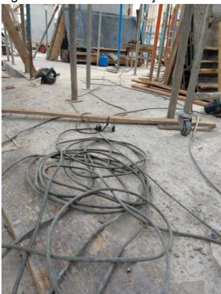
Figura 13: Acúmulo de fiação elétrica
