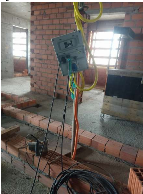
Figura 14: Quadro de tomadas
