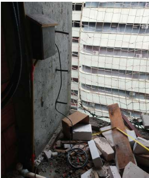
Figura 17: Acúmulo de materiais
