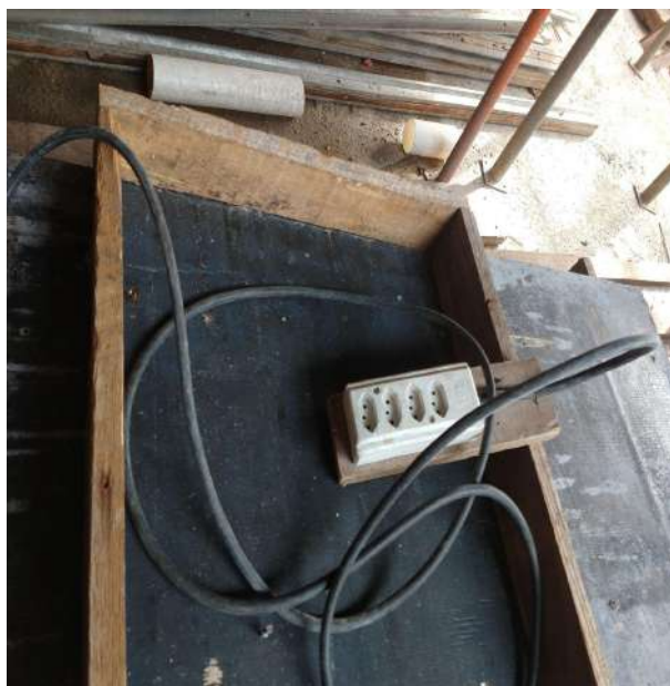
Figura 21: Acúmulo de materiais junto com fiação
