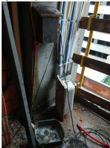
Figura 18: Água ao redor da fiação
