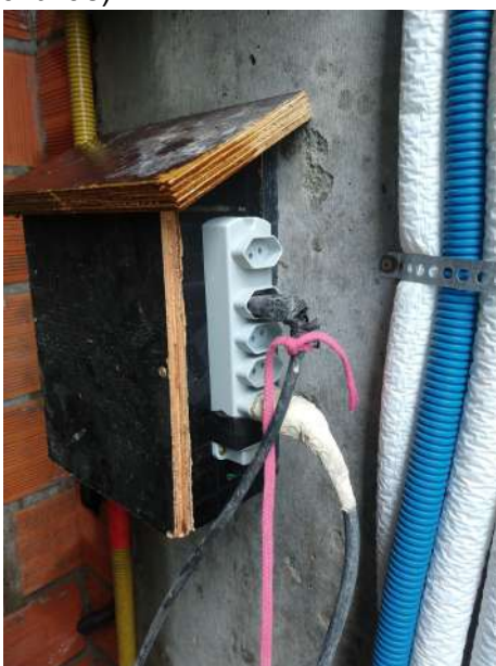
Figura 16: Exemplo de quadro de tomadas exposto às intempéries ( no caso da imagem, chuvas).
