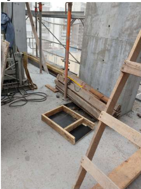
Figura 20: Acúmulo de materiais
