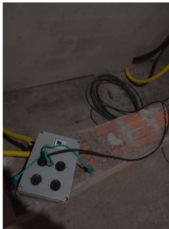
Figura 15: Quadro de tomadas jogado
