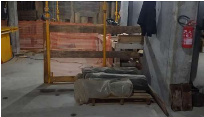
Figura 11: Material abaixo do extintor
