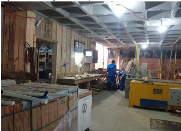
Figura 10: Posição inadequada do extintor
