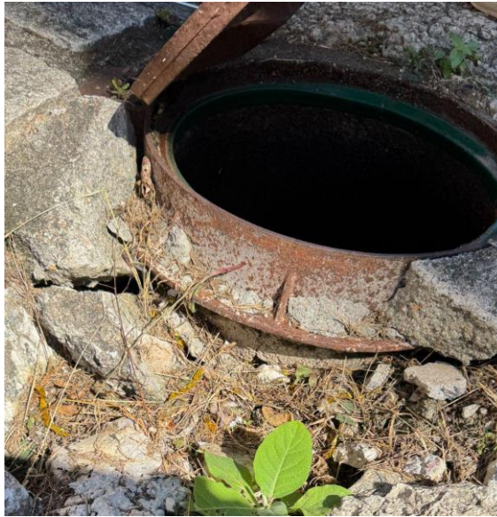
Figura 31 - CI-8 no Centro com erosão no entorno da tampa.
