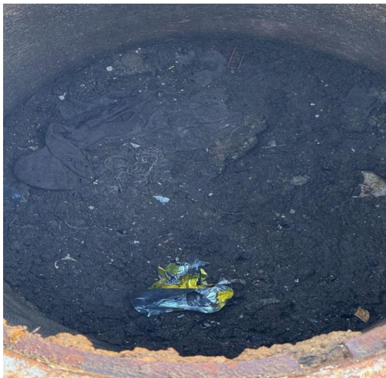
Figura 33 - Cl-2 em Canasvieiras com acúmulo de sujeira e obstrução de passagem.
