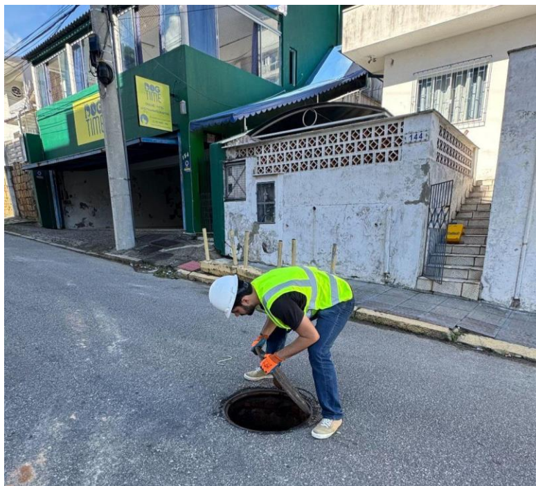
Figura 29 - PV-2 localizado no Centro apresenta desgaste no encaixe da tampa.
