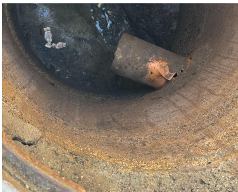
Figura 30 - PV-2 localizado nos Ingleses apresenta fissuras na tubulação e nas laterais.
