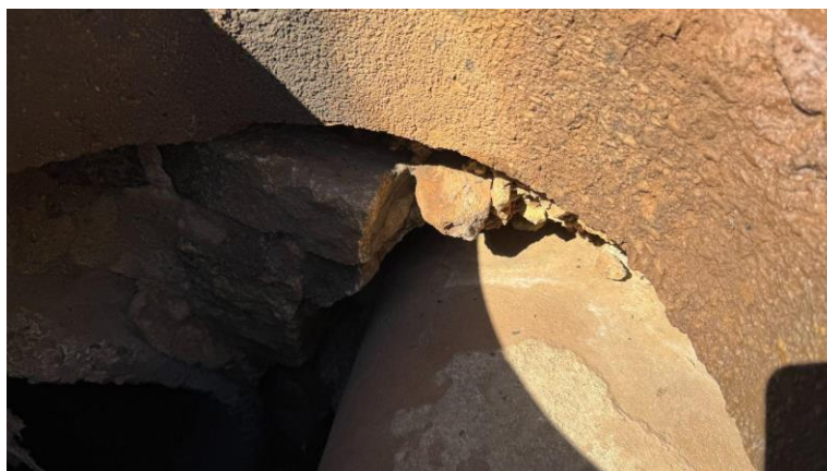
Figura 28 - PV-3 inspecionado no Centro com falha de vedação interna.
