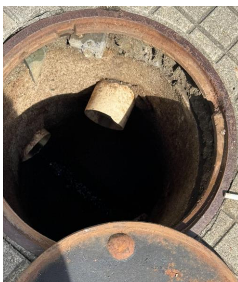
Figura 35 - CI no Centro apresentando danos nas laterais.
