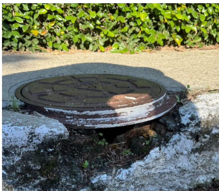
Figura 34 - CI em Canasvieiras com erosão ao redor da tampa.
