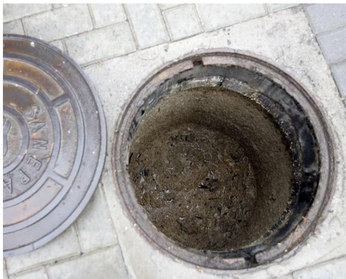
Figura 6 - Caixa de inspeção (CI) com patologia funcional do tipo sedimentação e obstrução.
