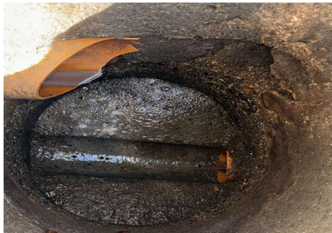
Figura 32 - CI-6 no Centro com alvenaria desgastada.
