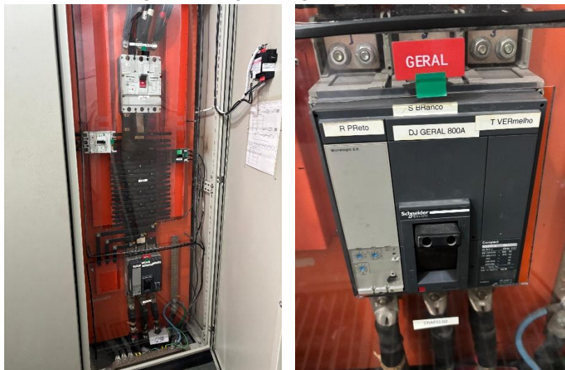
Figura 20 – Quadro geral de baixa tensão 2
