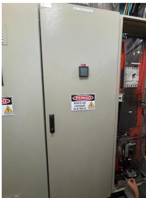
Figura 19 – Quadro geral de baixa tensão 1
