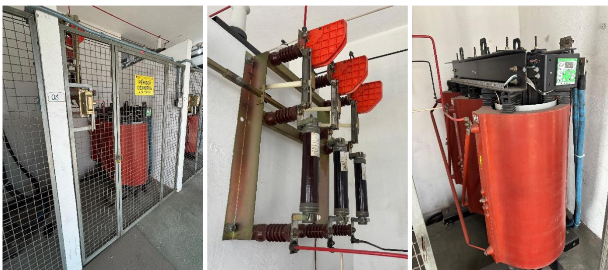
Figura 16 – Cubículo do transformador 3
