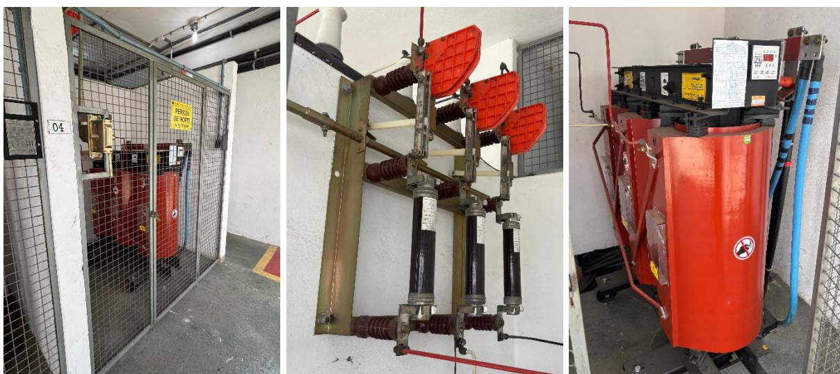
Figura 17 – Cubículo do transformador 4
