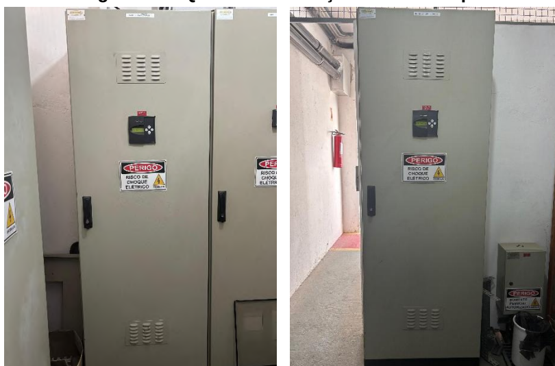
Figura 23 – Quadro de correção do fator de potência
