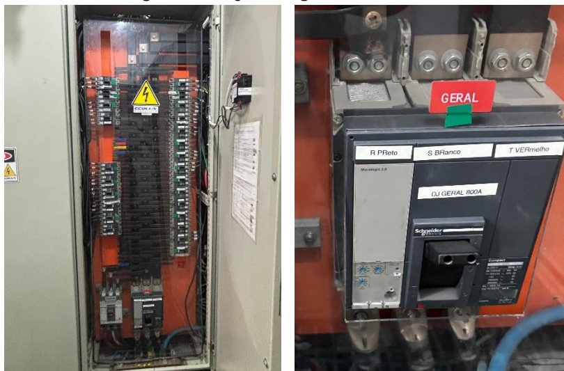
Figura 22 – Quadro geral de baixa tensão 4
