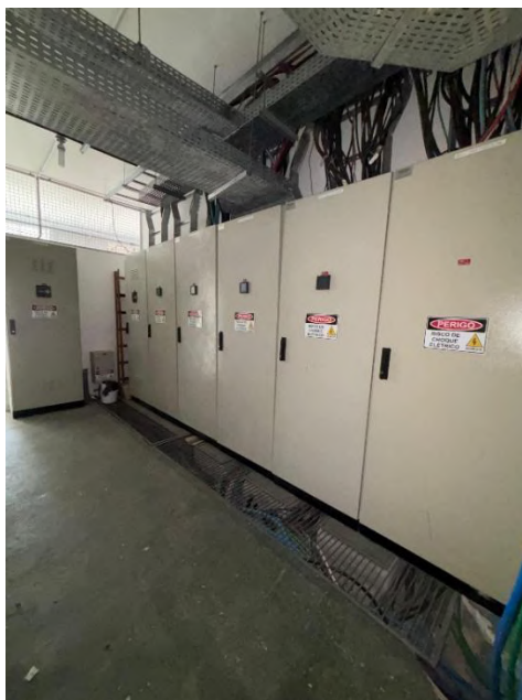
Figura 18 – Visão interna da sala de quadros elétricos
