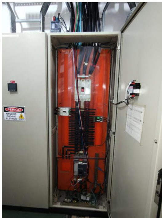
Figura 27 – Analisador instalado junto ao disjuntor geral do QGBT 4
