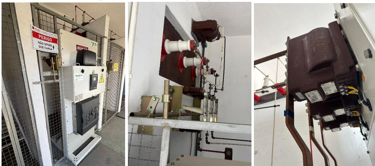
Figura 13 – Cubículo de proteção de média tensão
