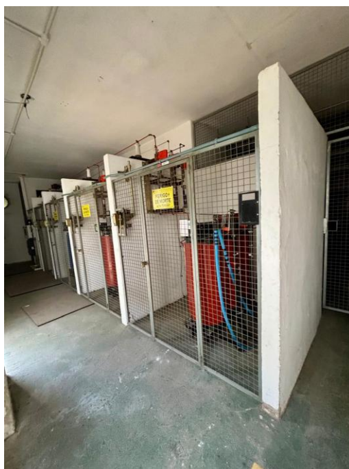
Figura 10 – Visão interna da subestação
