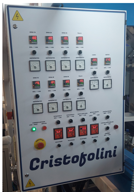
Figura 3 – Painel com módulos básicos de controladores de temperatura
