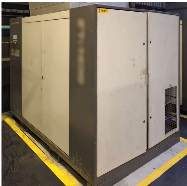
Figura 18 - Compressor rotativo de parafuso.
