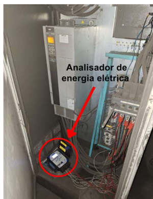
Figura 25- Conexão do analisador de energia no ponto de conexão comum
