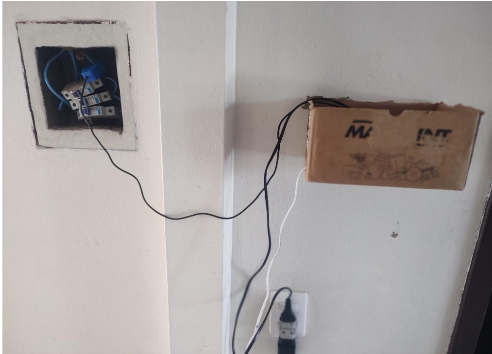
Figura 12 - Sistema EnergyCheck instalado na residência
