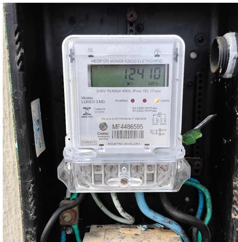
Figura 16 - Medidor de energia após o teste de duas semanas
