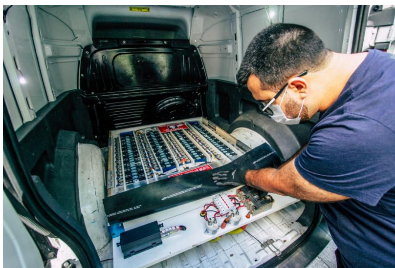
Figura 23 - Instalação do Pack de baterias
