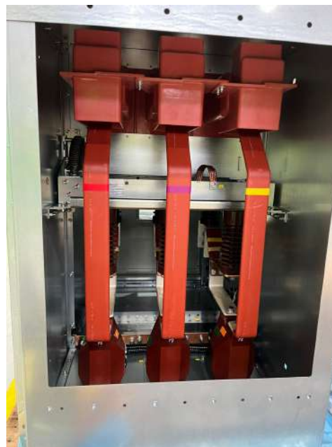
Fig. 2. Polos do disjuntor de média tensão de uma das colunas
