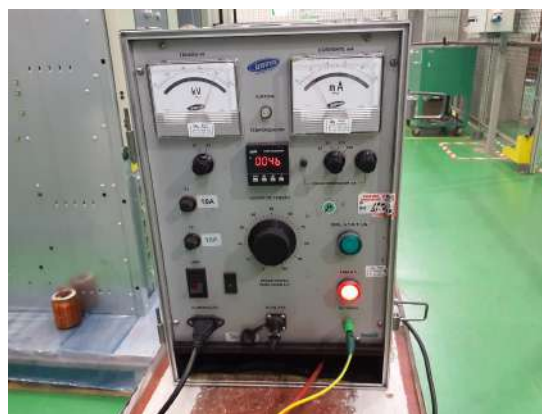
Fig. 6. Equipamento utilizado no ensaio de tensão suportável à frequência industrial
