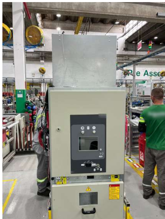
Fig. 3. Montagem sem caixa BT
