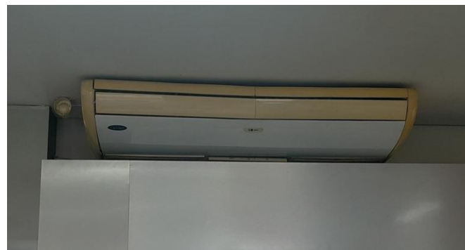
Fig.3. Ar-condicionado da loja.
