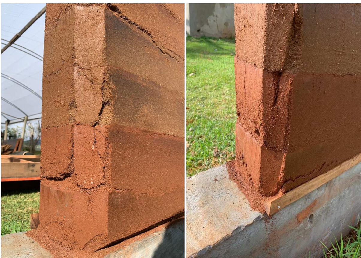
Figura 60: Trincas verticais e horizontais
