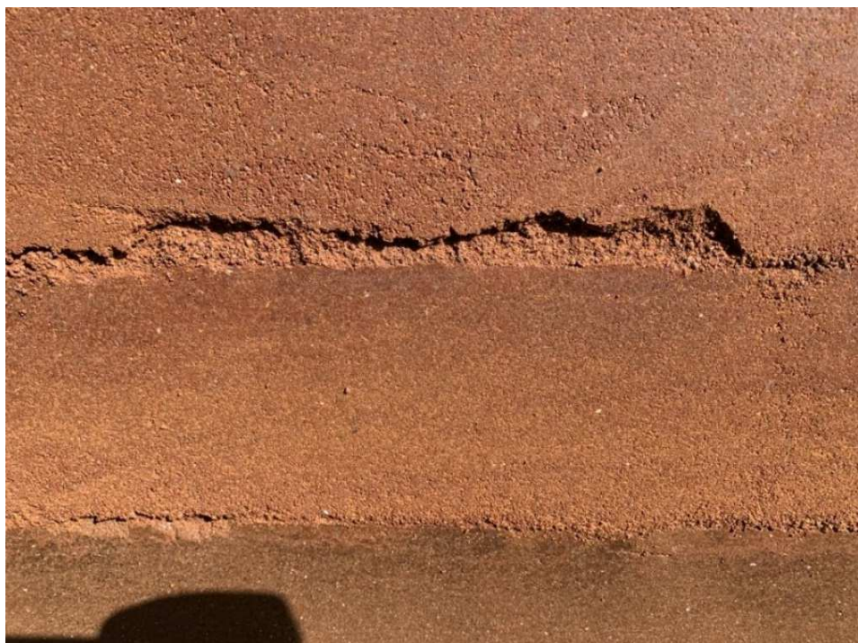
Figura 62: Falta de aderência
