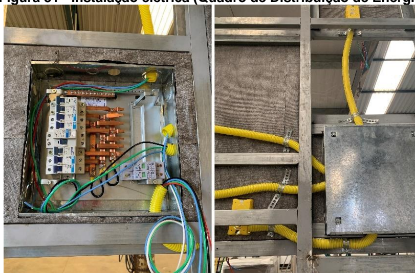
Figura 31 - Instalação elétrica (Quadro de Distribuição de Energia)
