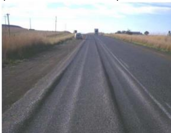
Figura 5- Defeito no pavimento asfáltico causado por afundamento por trilha de roda
