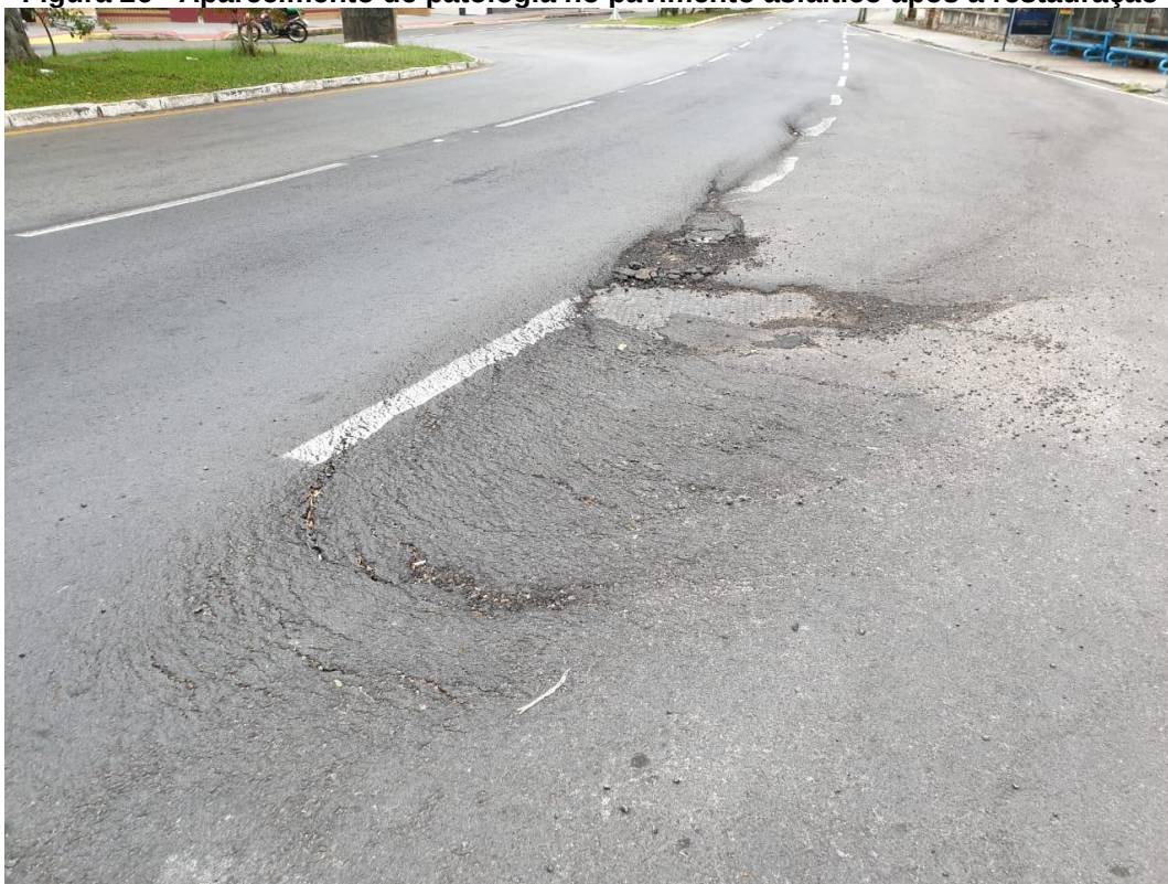
Figura 26 - Aparecimento de patologia no pavimento asfáltico após a restauração
