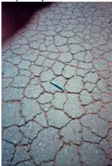
Figura 6 - Deterioração do pavimento causada pelo trincamento por fadiga
