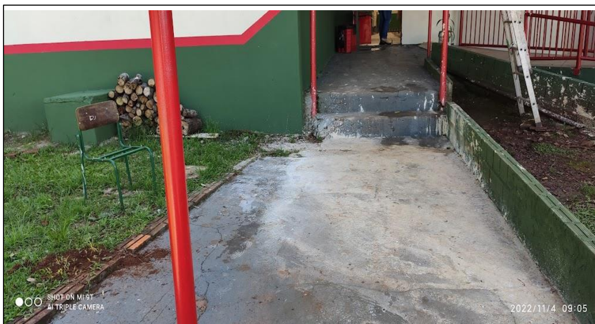
Figura 41 - Degraus isolados na área de circulação sem corrimão e guarda corpo.
