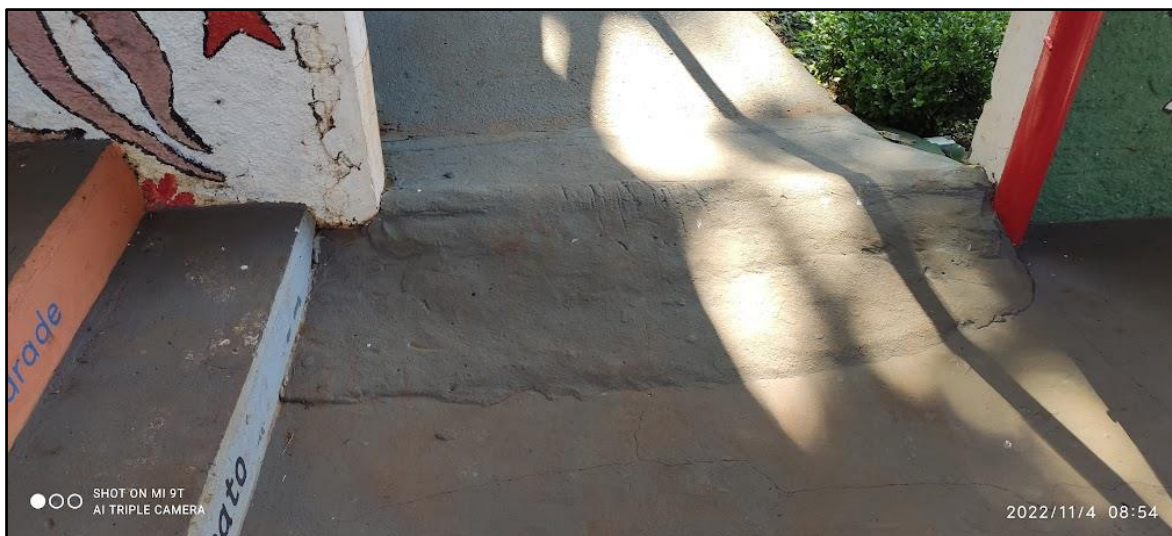
Figura 34- Desnível corrigido com uma lombada.
