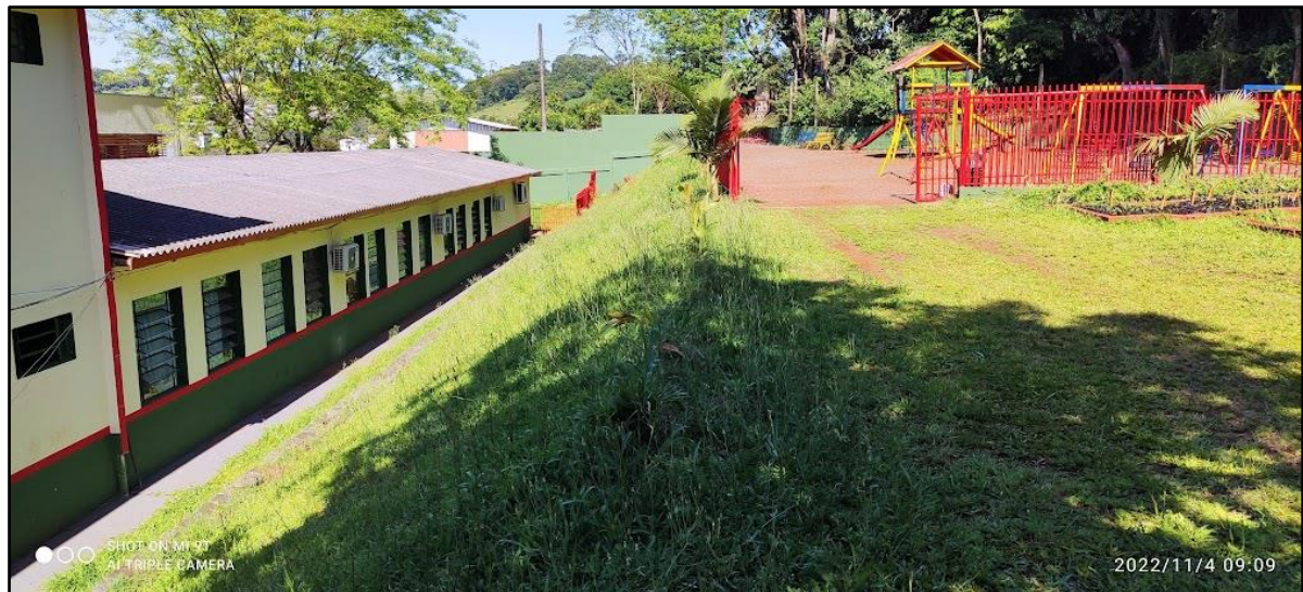
Figura 49 - Talude sem proteção na parte superior.
