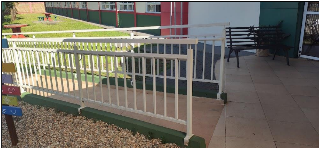
Figura 24 - Rampa - ausência da extensão de 0.30 cm do corrimão.
