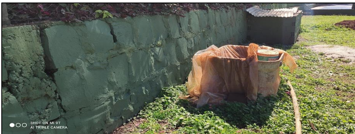
Figura 50 - Área com entulhos de obras.
