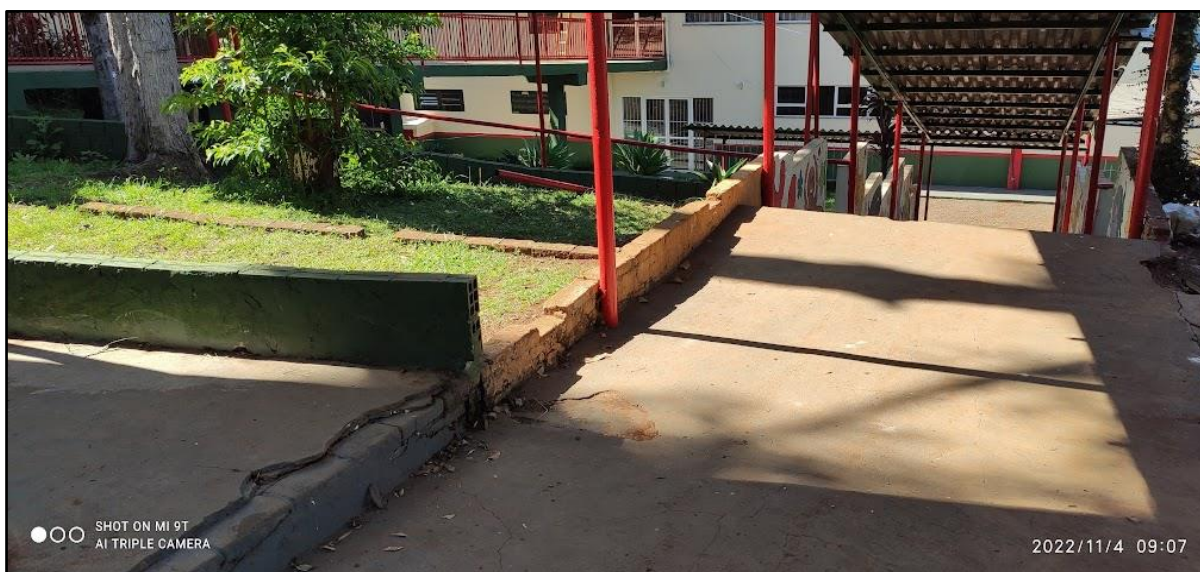
Figura 31- Ausência de corrimãos, parede ou grade de proteção nas laterais da escada.
