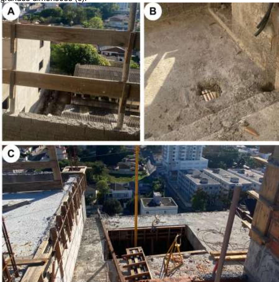
Figura 07: Qualidade da madeira do guarda-corpo (a), buraco pequeno exposto na laje (b), buraco de grandes dimensões (c).
