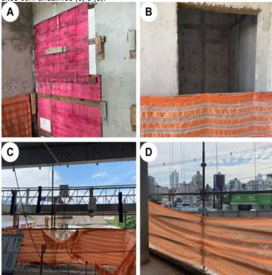
Figura 04: Vedação do fosso do elevador (a), guarda-corpo com tela de proteção (b), guarda-corpo feitos com andaimes (c) e (d).
