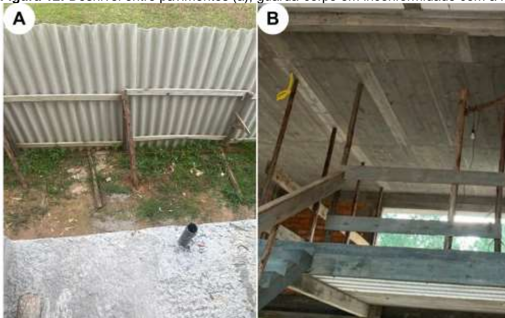
Figura 12: Desnível entre pavimentos (a), guarda-corpo em inconformidade com a norma (b).
