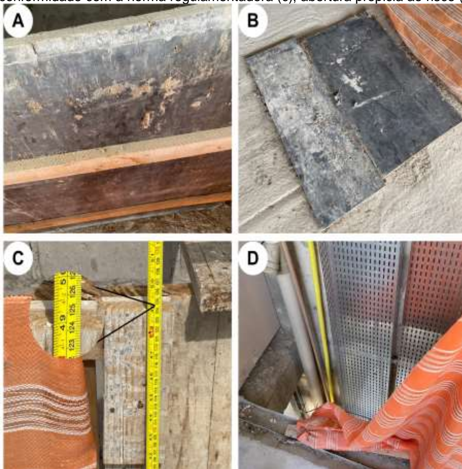
Figura 03: Qualidade da madeira (a), abertura coberta não travada (b), guarda-corpo em conformidade com a norma regulamentadora (c), abertura propicia ao risco (d).
