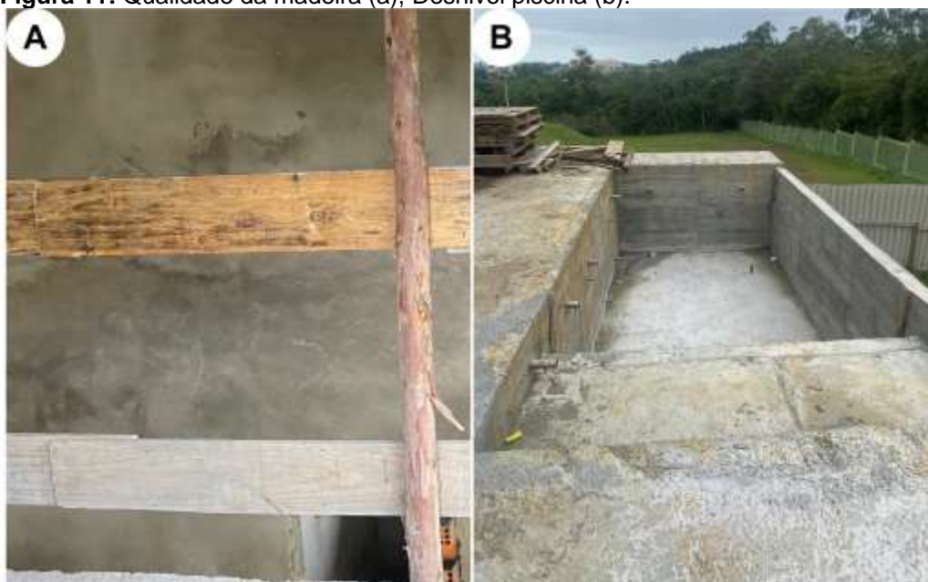
Figura 11: Qualidade da madeira (a), Desnível piscina (b).
