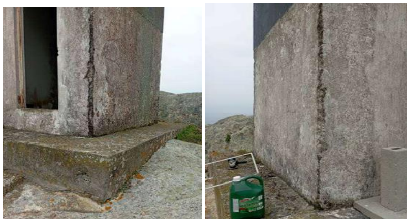
Figura 32 - Detalhes da base e laterais da estrutura com fissura vertical, perda de cobrimento e biodeterioração superficial
