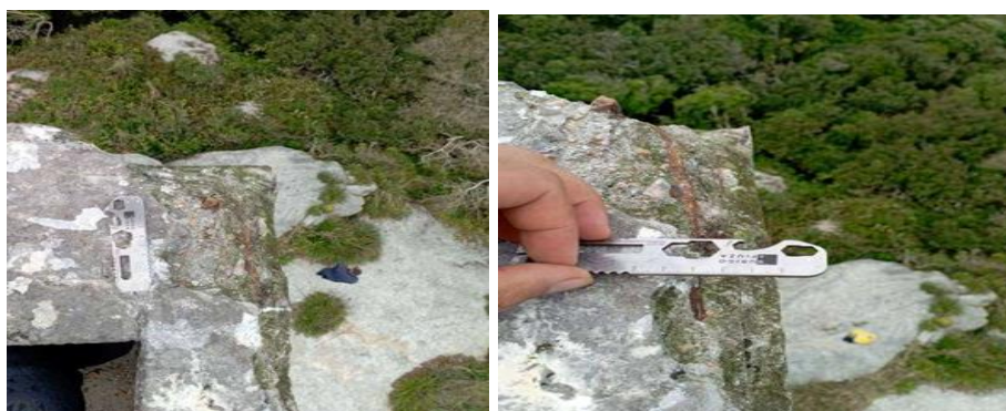
Figura 21 - Deslocamento do concreto com exposição e corrosão acentuada das armaduras
