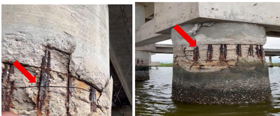
Figura 12 - Corrosão de armaduras em estrutura de concreto armado exposta ao ambiente marinho
