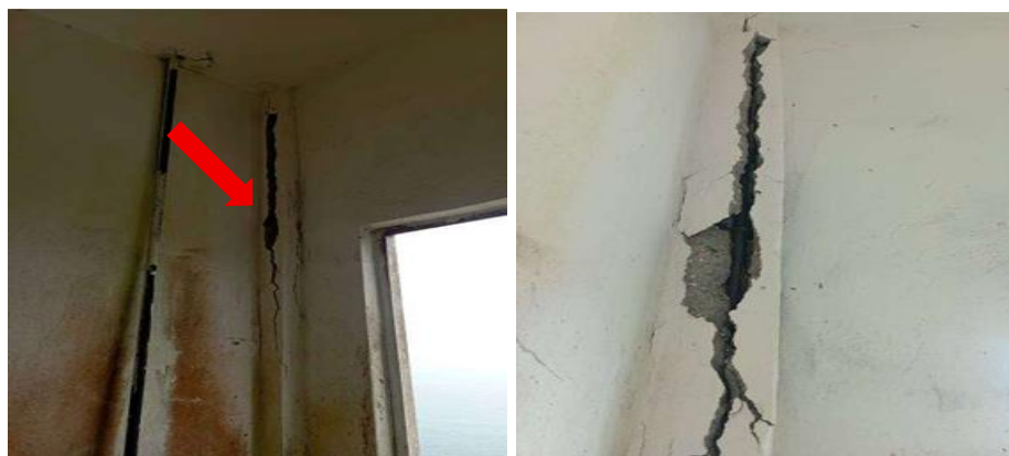
Figura 20 - Fissura vertical associada à infiltração e à degradação do revestimento
