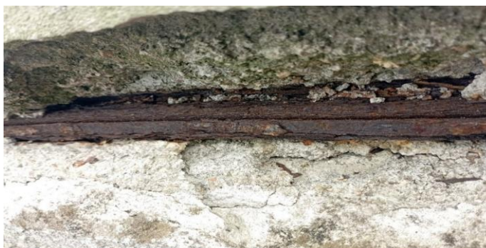
Figura 19 - Exposição das armaduras e sinais de corrosão em elemento de concreto armado
