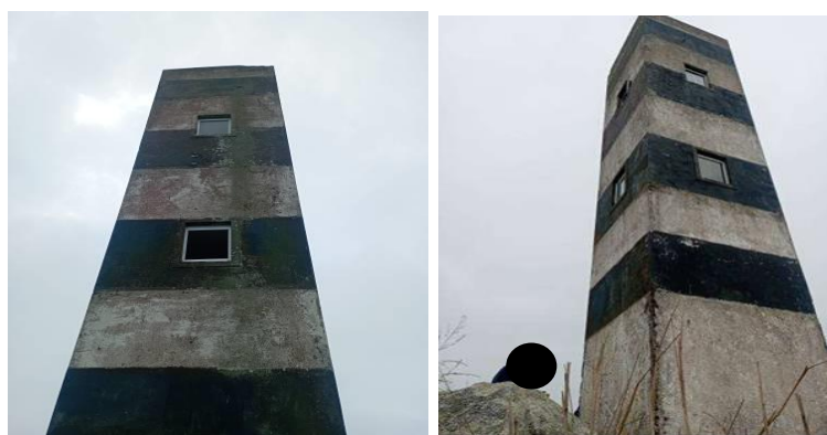
Figura 31 - Estrutura vertical de concreto com degradação em faixas, perda de revestimento e exposição das armaduras
