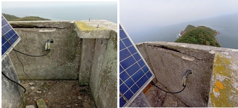
Figura 23 - Fissura horizontal no topo de guarda-corpo exposta diretamente ao ambiente marinho
