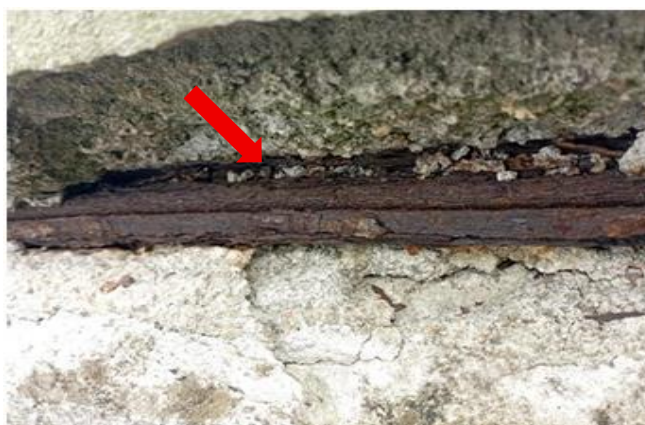
Figura 8 - Corrosão de Armadura
