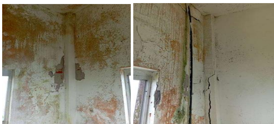
Figura 29 - Deslocamento do revestimento, fissuras verticais profundas e alterações superficiais associadas à biodeterioração
