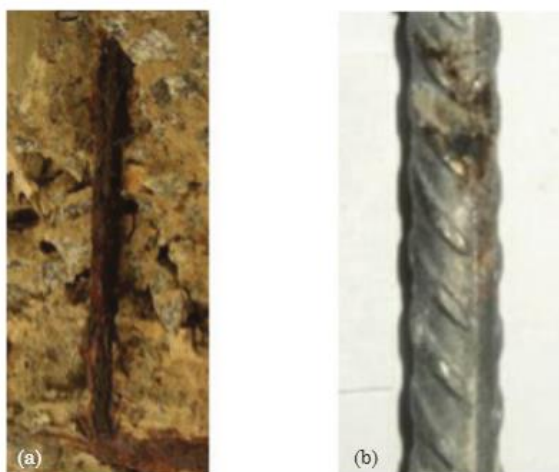
Figura 7 - Aparência superficial da corrosão generalizada desencadeada pela carbonatação (a) e da corrosão puntiforme desencadeada pela ação dos íons cloreto(b)
