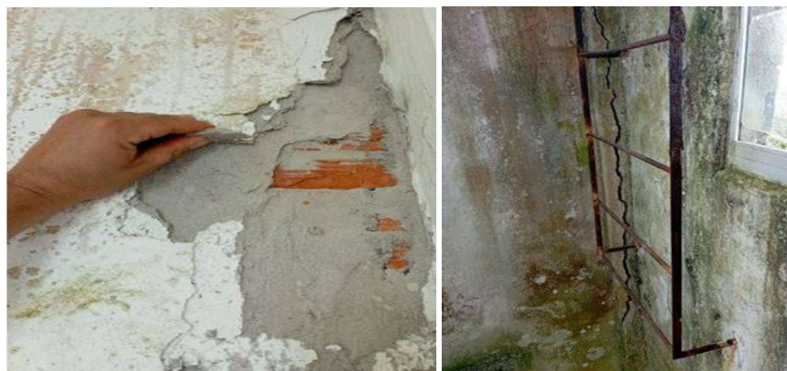
Figura 27 - Fissura vertical em parede interna próxima a escada metálica com sinais de oxidação
