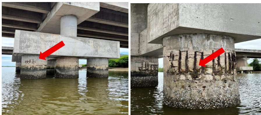
Figura 14 - Corrosão de armaduras em estrutura de concreto armado exposta ao ambiente marinho
