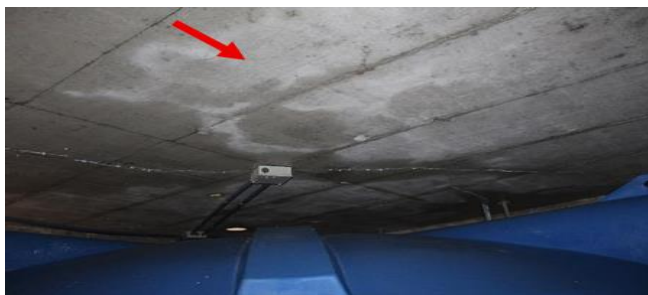
Figura 3 - Eflorescência em ambiente destinado à instalação de caixa d'água
