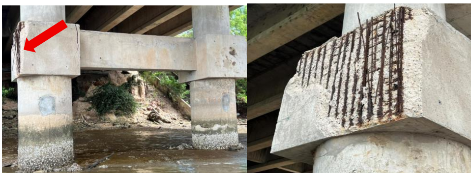
Figura 13 - Corrosão de armaduras em estrutura de concreto armado exposta ao ambiente marinho
