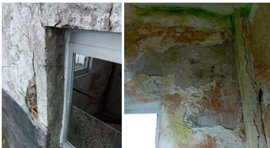
Figura 26 - Deterioração próxima a abertura com fissuras, perda de revestimento e biodeterioração superficial
