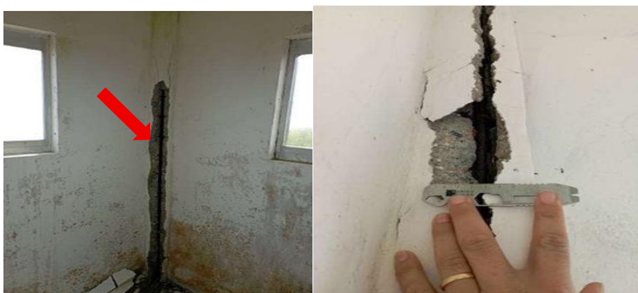
Figura 22 - Fissura vertical profunda com deslocamento acentuado do concreto em elemento estrutural
