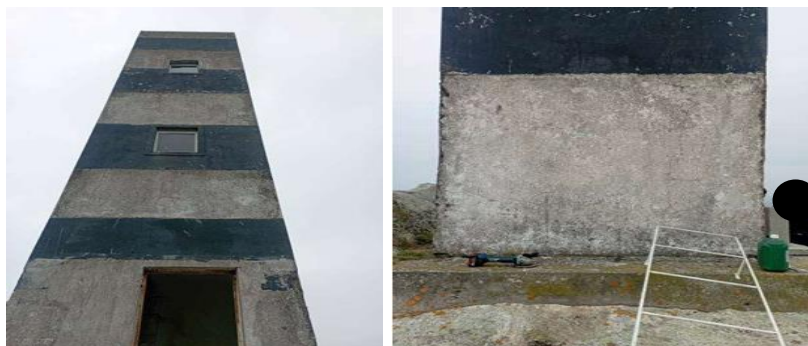
Figura 35 – Fachada com manifestações patológicas associadas à exposição à umidade e à maresia
