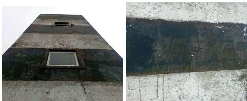
Figura 34 - Fachada externa com presença de umidade, fissuração superficial e degradação do revestimento
