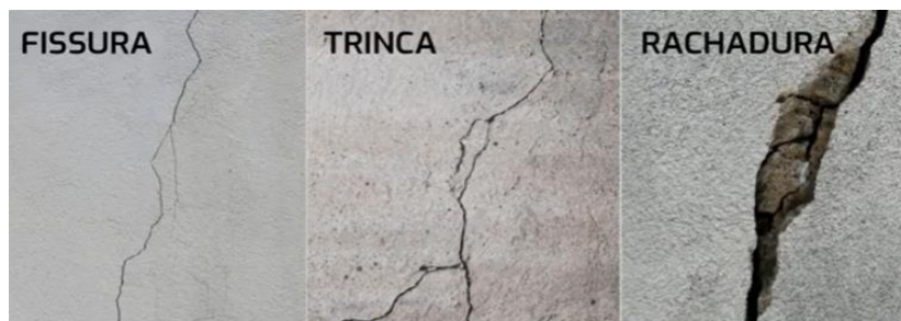
Figura 4 - Variações de Fissuras/Trincas/Rachaduras
