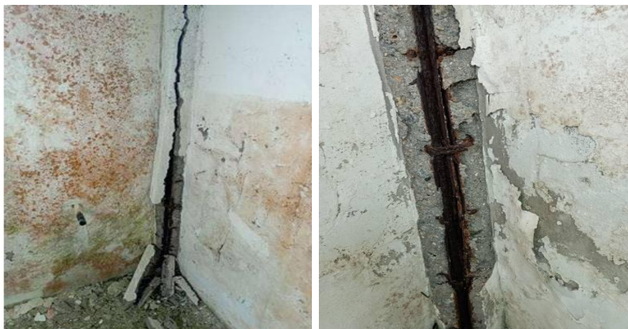
Figura 18 – Fissuração e perda de cobrimento do concreto com exposição das armaduras
