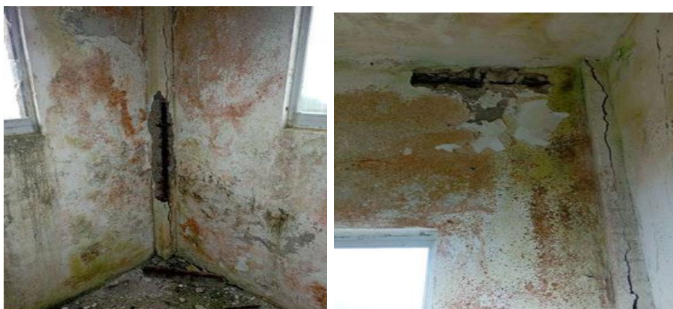
Figura 25 - Fissura vertical profunda com exposição da armadura e sinais de umidade e biodeterioração superficial
