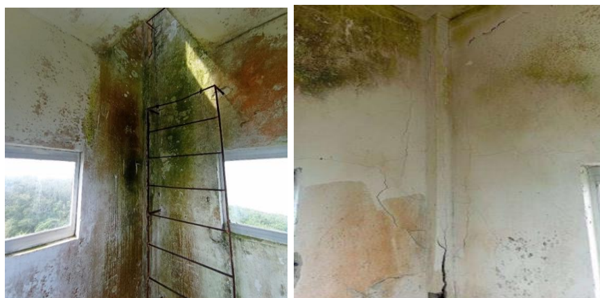
Figura 28 – Biodeterioração superficial com presença de musgo e mofo, fissuras verticais e deslocamento do revestimento
