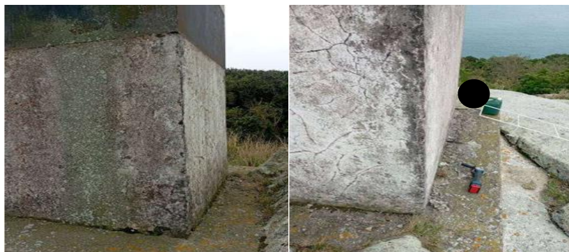
Figura 33 - Base de elemento estrutural com fissuras, perda de material e biodeterioração superficial
