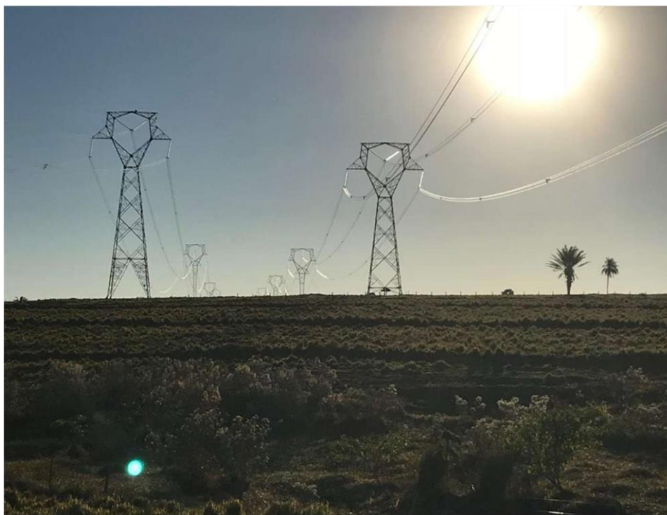
Figura 5 - Linha de transmissão energizada
