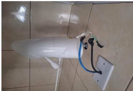
Imagem 29 – Sem condutor terra na instalação
