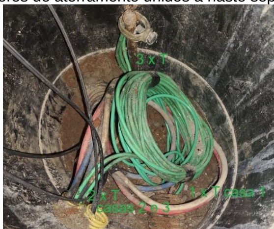
Imagem 43 – Condutores de aterramento unidos à haste separado do neutro
