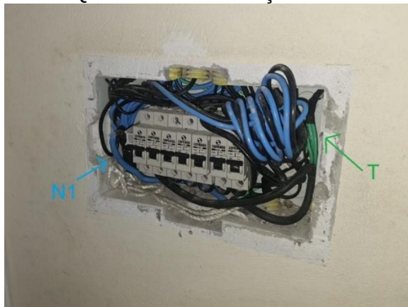
Imagem 44 – Quadro de distribuição de circuitos
