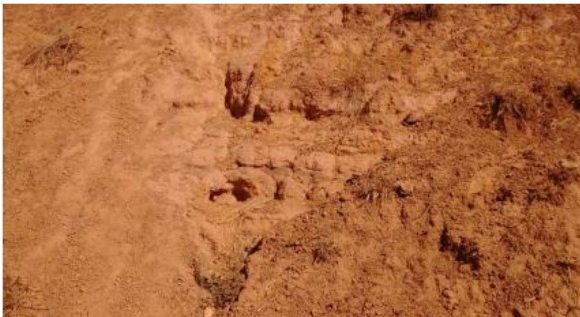
Figura 17 - Talude de jusante da barragem de terra com erosão.
