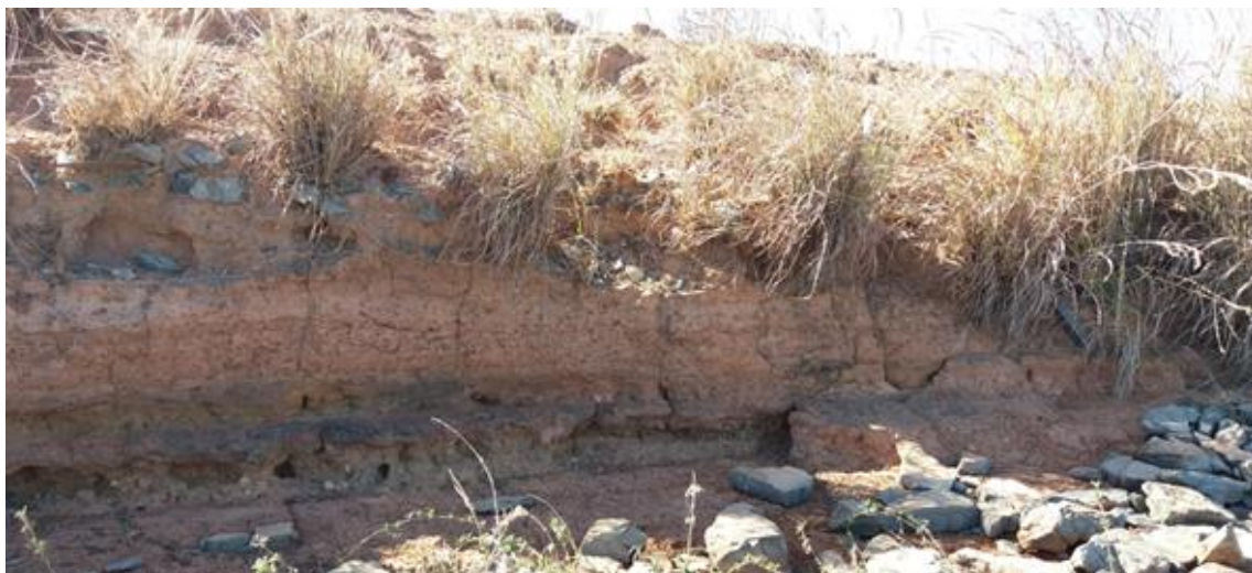
Figura 15 - Talude de montante da barragem de terra com erosão.
