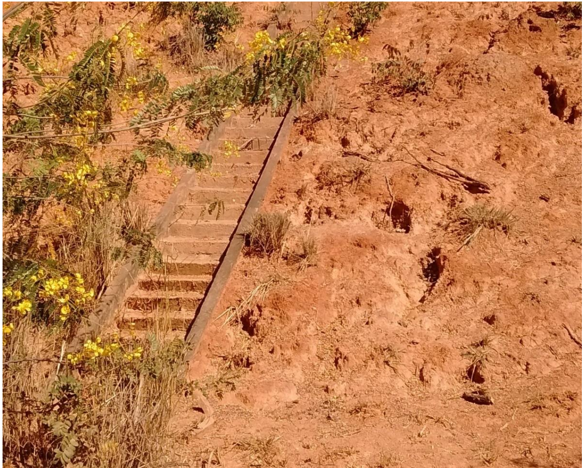
Figura 7 - Incidência de vegetação próxima a saída da drenagem superficial.
