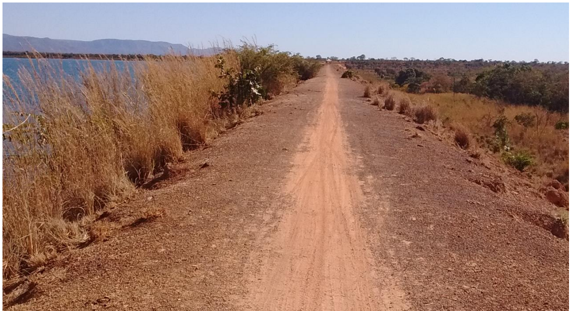
Figura 10 - Crista e talude de montante com vegetação excessiva.
