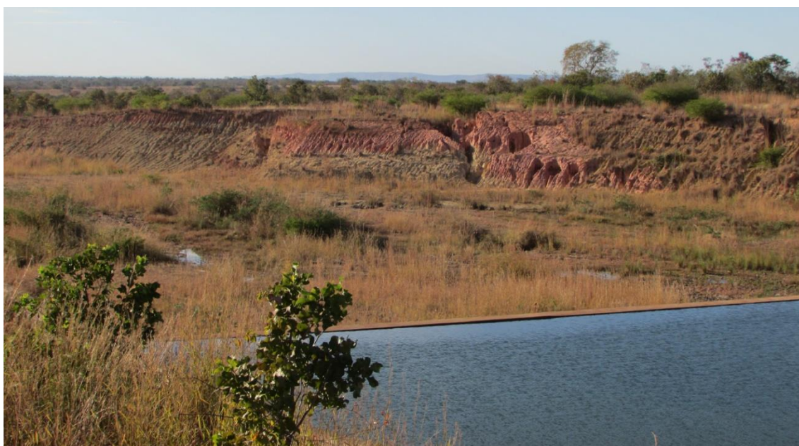
Figura 14 - Talude do canal de restituição do vertedouro labirinto.
