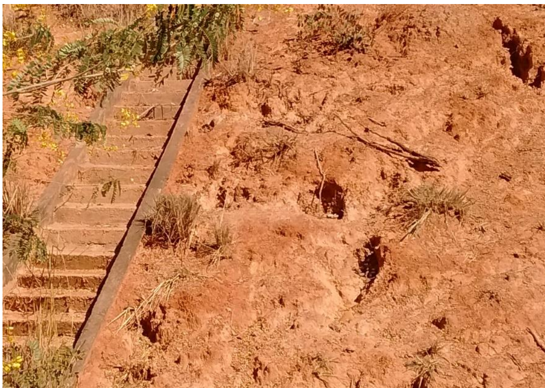
Figura 16 - Talude de jusante da barragem de terra com início de erosão.
