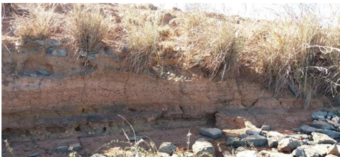
Figura 12 - Talude de montante da barragem de terra desprotegido.
