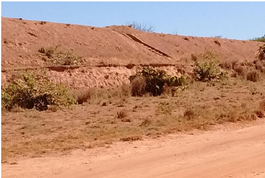
Figura 22 - Dreno de pé erodido.
