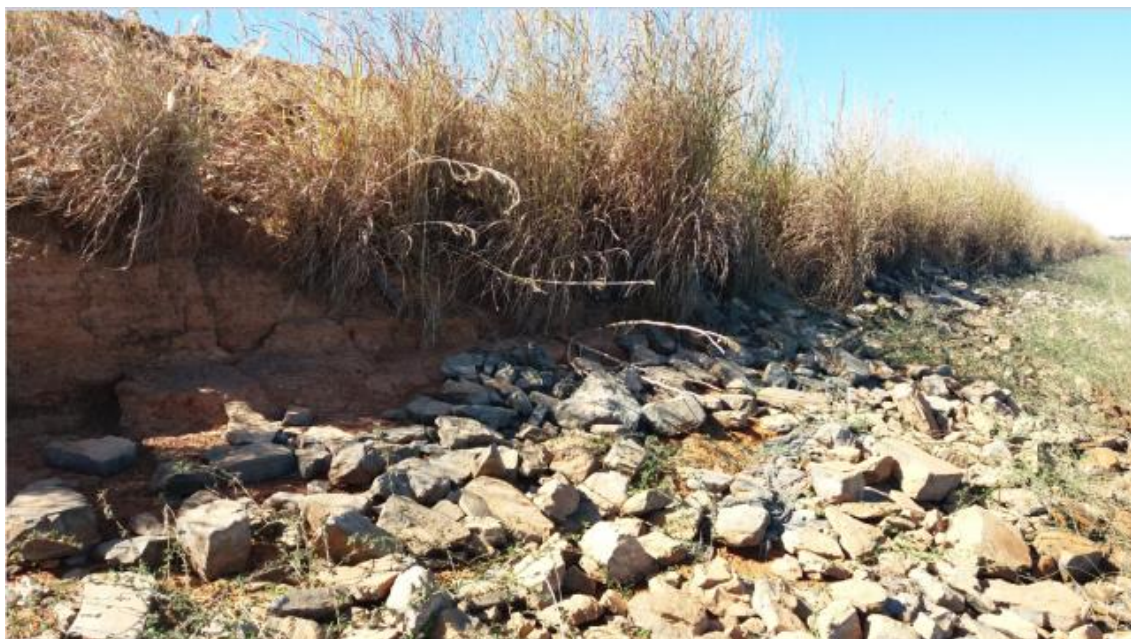
Figura 11 - Talude de montante da barragem de terra desprotegido.
