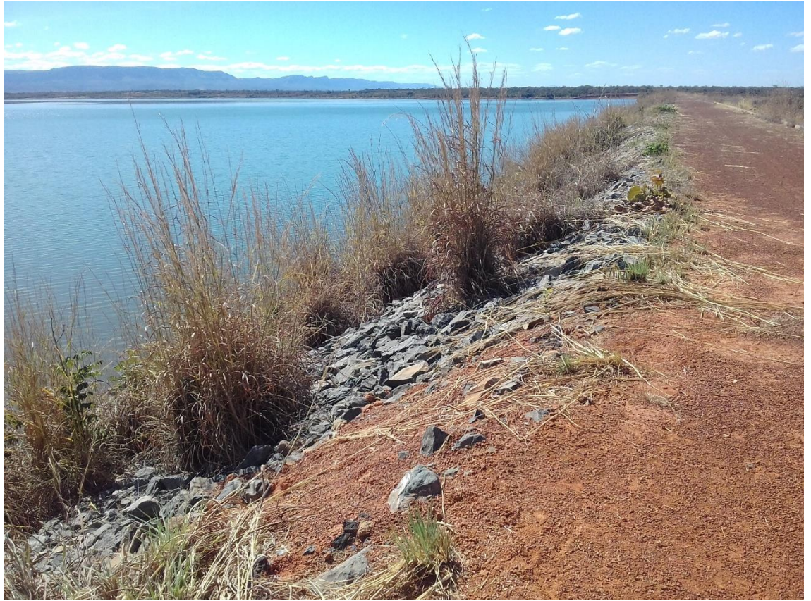
Figura 9 - Talude de montante com vegetação excessiva.
