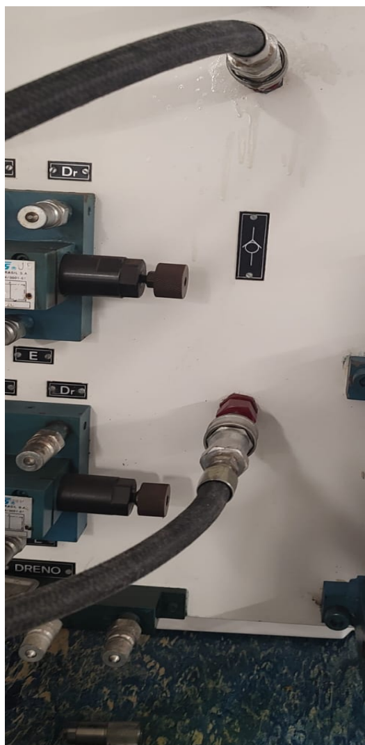
Figura 7 - Conexão válvula de retenção vista frontal
