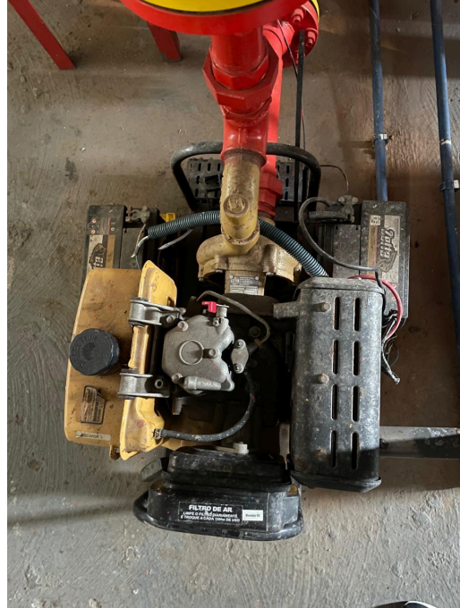
Figura 18 - Bomba Reserva (bomba de combustão)
