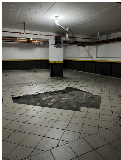
Figura 142 - Pisos danificados e ausentes na garagem subsolo
