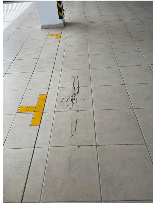
Figura 141 - Pisos quebrados G1.
