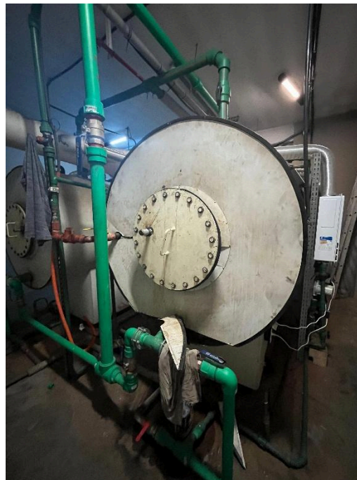
Figura 57 - Corpos do Boiler
