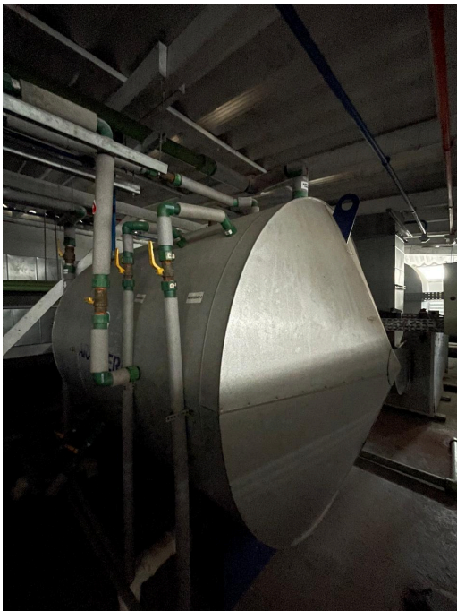
Figura 52 - Corpos do Boiler Torre 01
