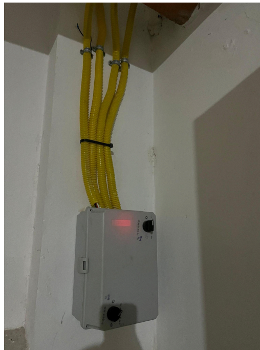
Figura 41 - Controlador bomba de recalque
