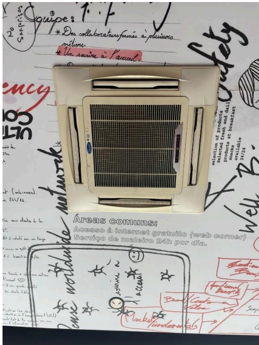
Figura 107 - Cassete área lobby
