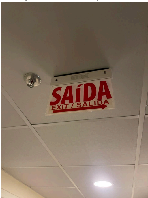
Figura 32 - Placa de sinalização de saída
