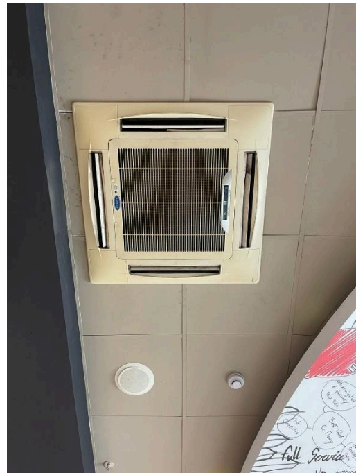
Figura 108 - Cassete área lobby
