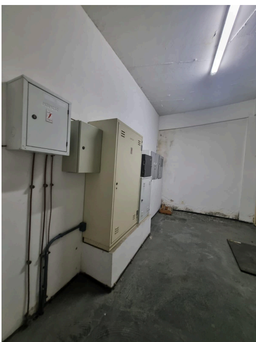
Figura 19 - Quadro e controladores
