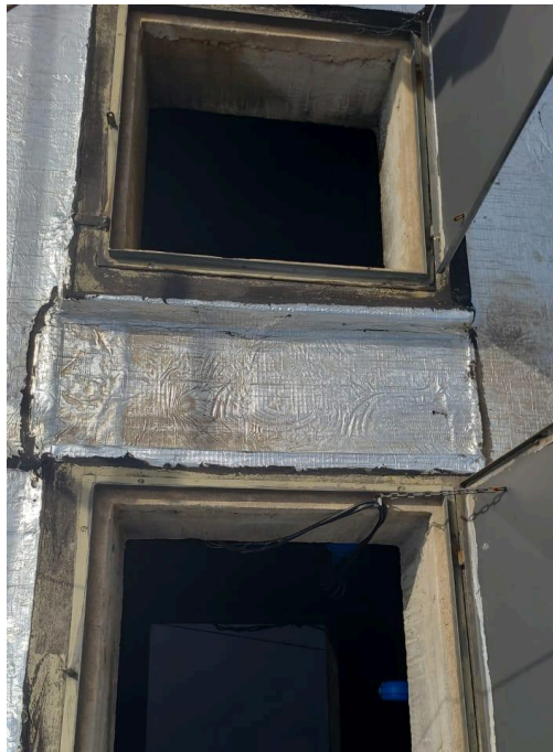
Figura 38 - Caixas 01 e 02 Torre 2
