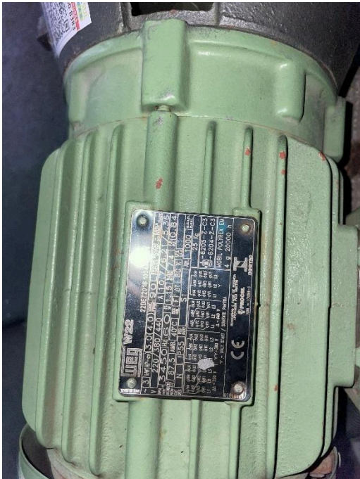
Figura 43 - Etiqueta Bomba de recalque 01.
