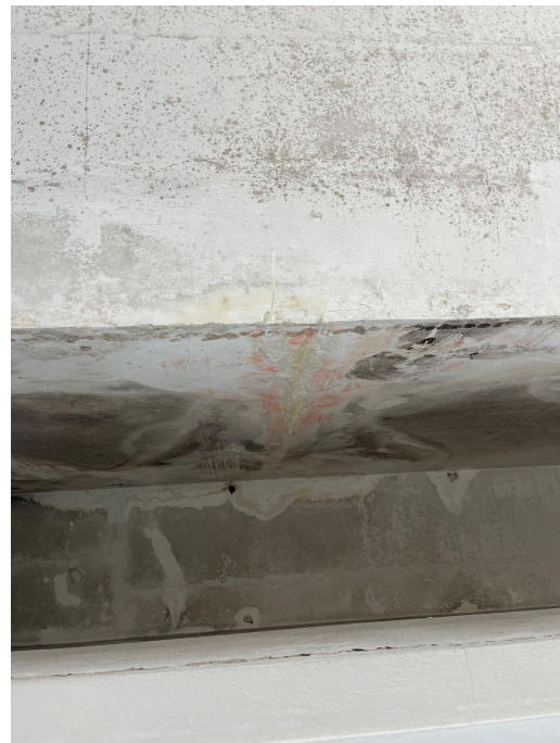
Figura 48 - Mofos e manchas nas paredes e teto
