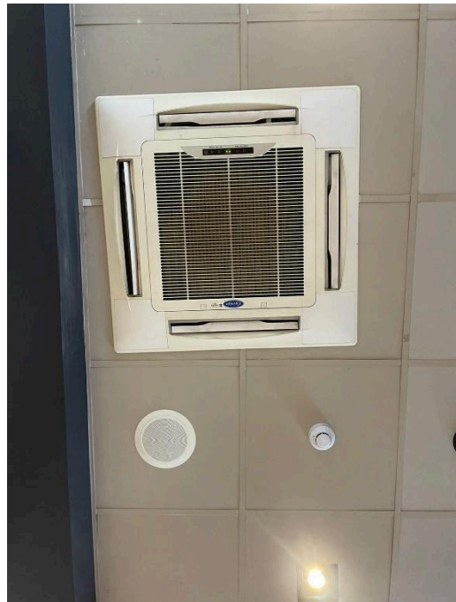
Figura 112 - Cassete área lobby
