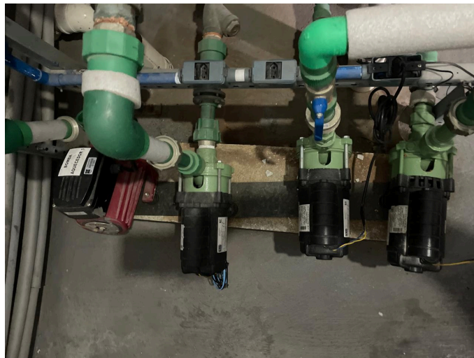
Figura 75 - Bombas de circulação
