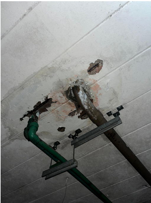
Figura 159 - Pontos de gotejamento teto SS1
