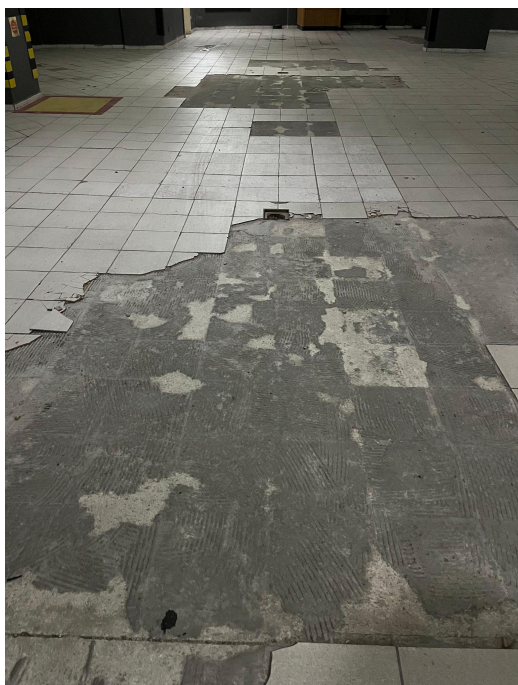
Figura 143 - Pisos danificados e ausentes na garagem subsolo
