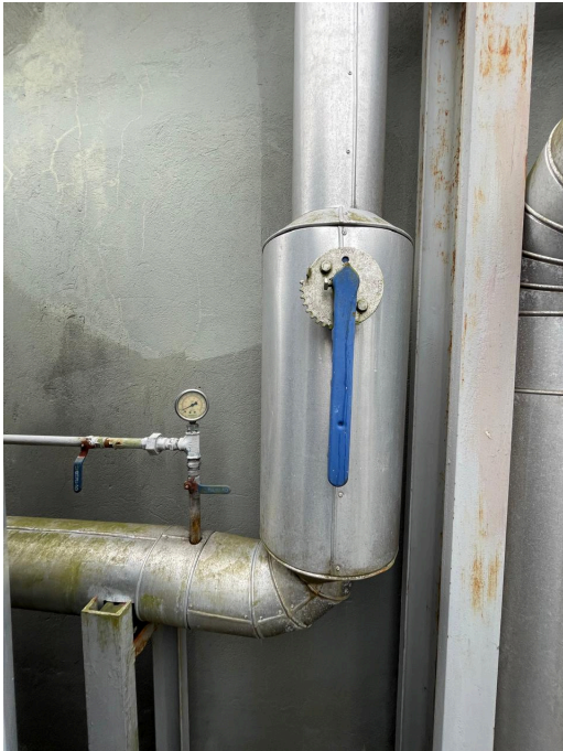
Figura 105 - Trocador de calor chiller 01.
