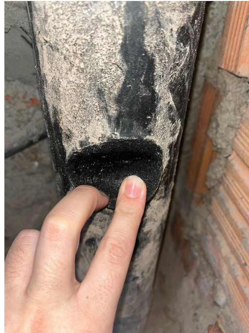
Figura 108 - Isolamento encharcado (G1)
