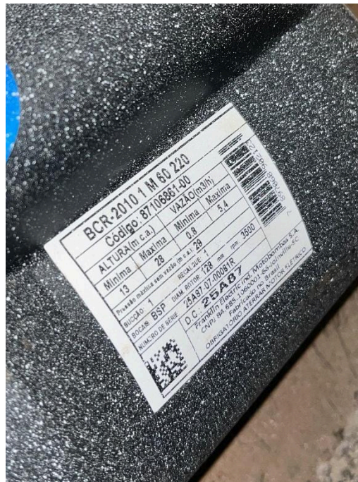
Figura 89 - Etiqueta de identificação bomba 1
