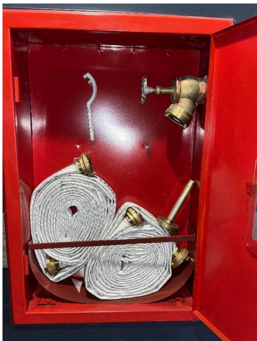
Figura 25 – Caixa de hidrante térreo
