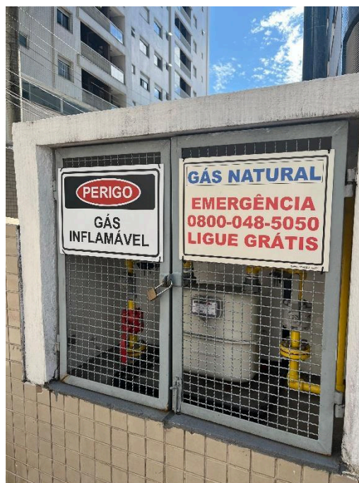
Figura 122 - Casa de gás externa
