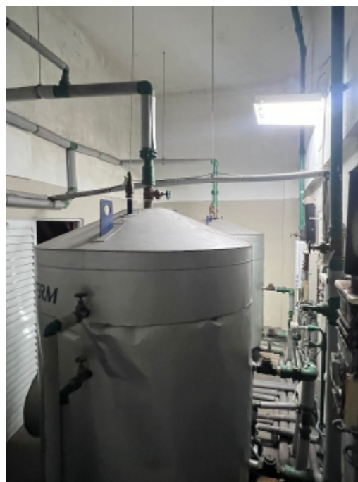
Figura 08 - Área dos Boilers
