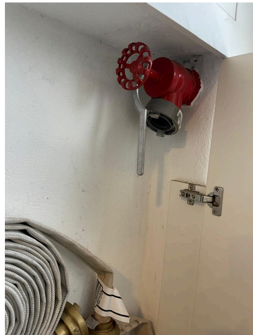
Figura 30 - Hidrante 11º andar Torre 01.
