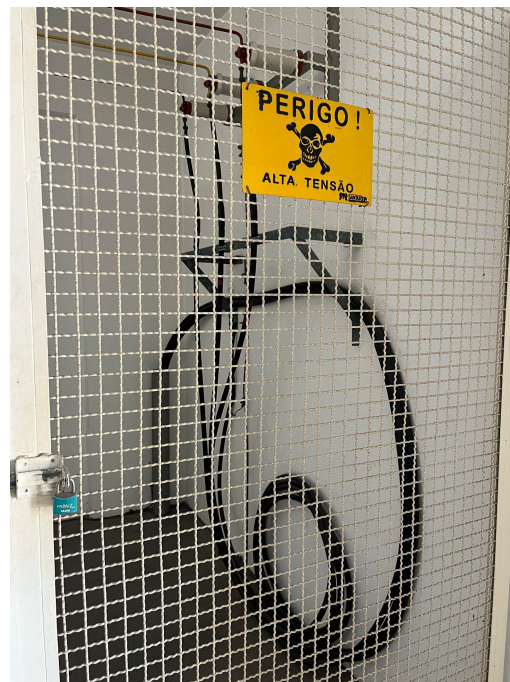
Figura 98 - Área do trafo
