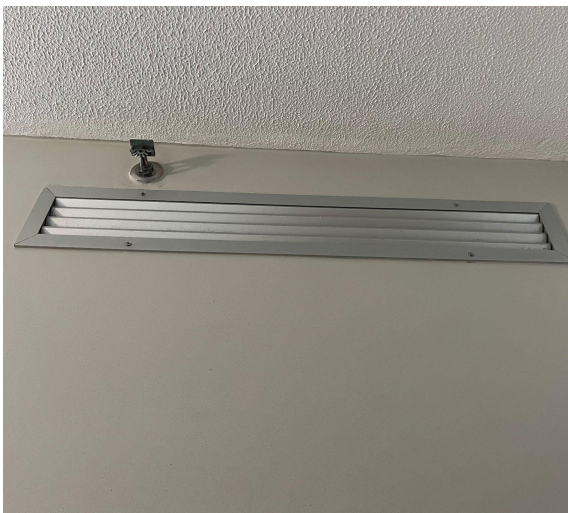
Figura 115 - Grelha de saída de ar
