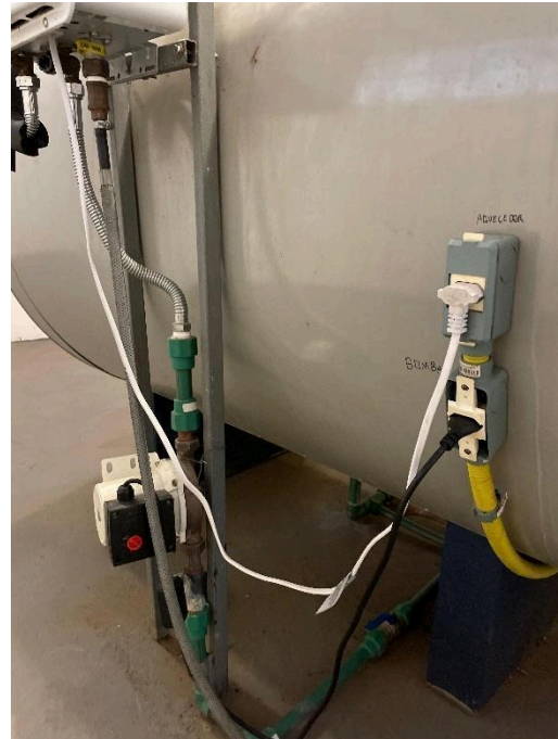
Figura 72 - Bomba e Tomadas Aquecedor 01
