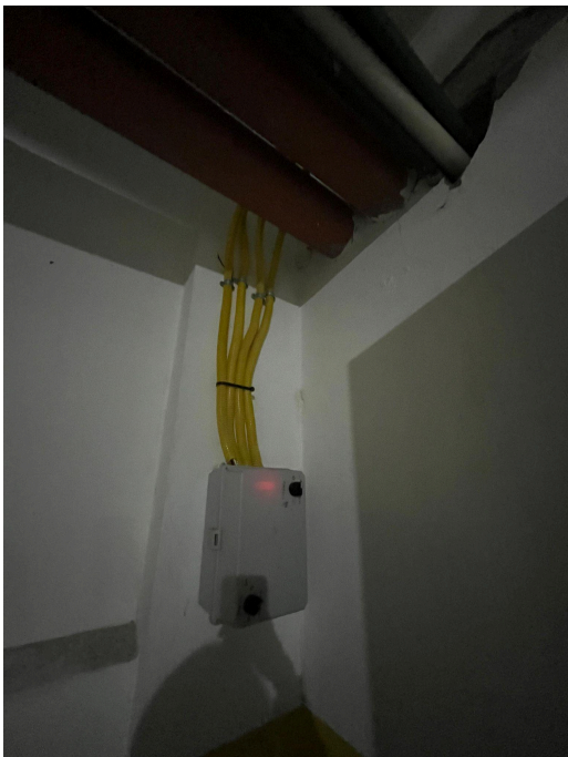
Figura 40 - Controlador bomba de recalque
