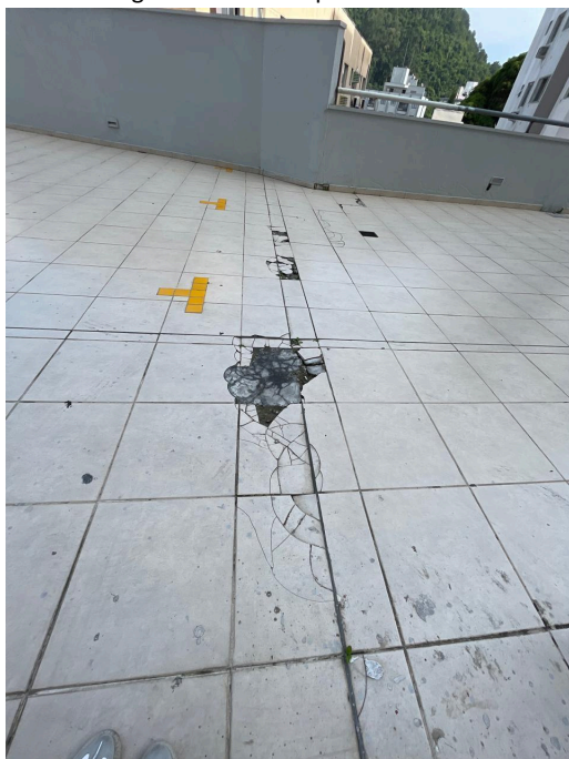
Figura 138 - Pisos quebrados G2.
