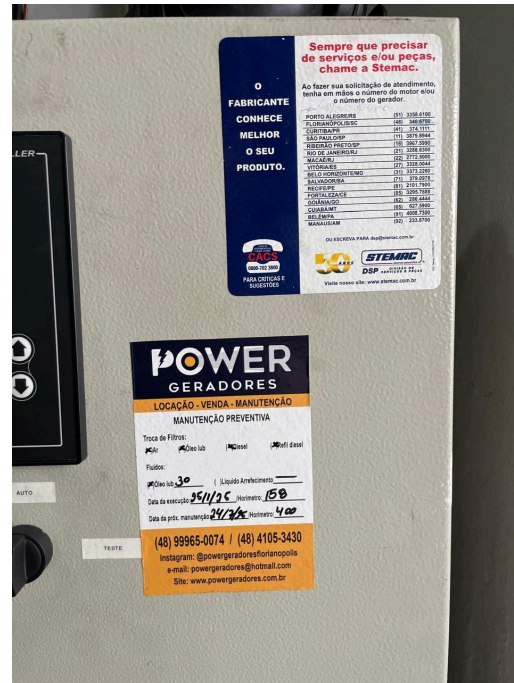
Figura 94 - Etiqueta de manutenção preventiva.
