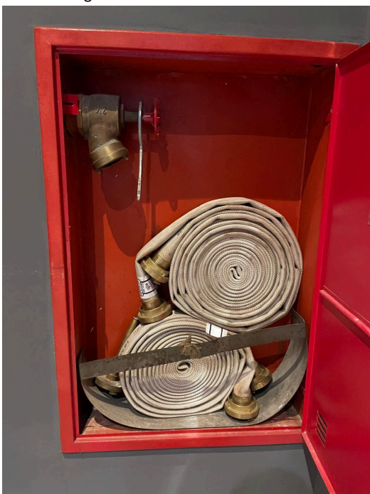
Figura 25 - Caixa de hidrante Térreo.
