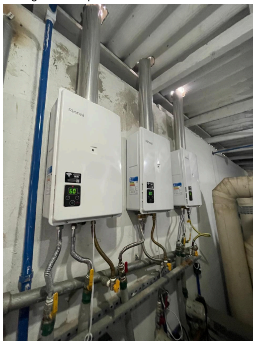
Figura 58 - Aquecedores e bombas Torre 01.
