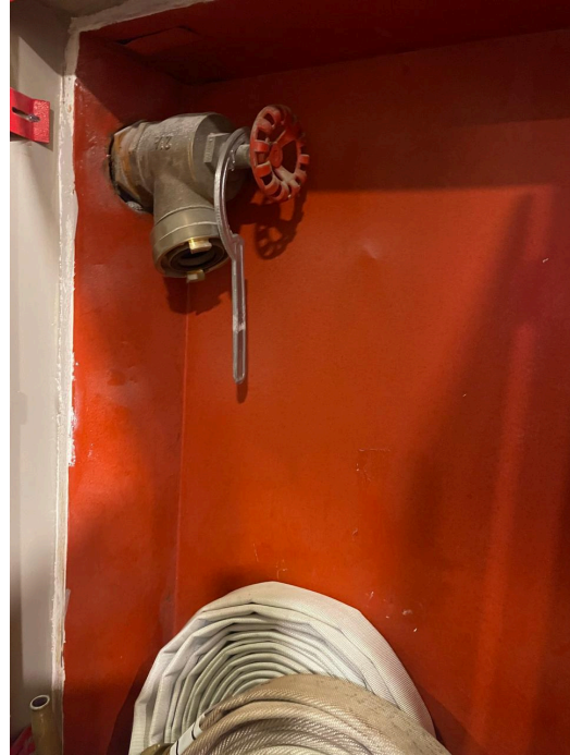
Figura 28- Hidrante 5º andar Torre 02.
