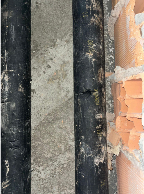
Figura 105 - Isolamento encharcado (G1)
