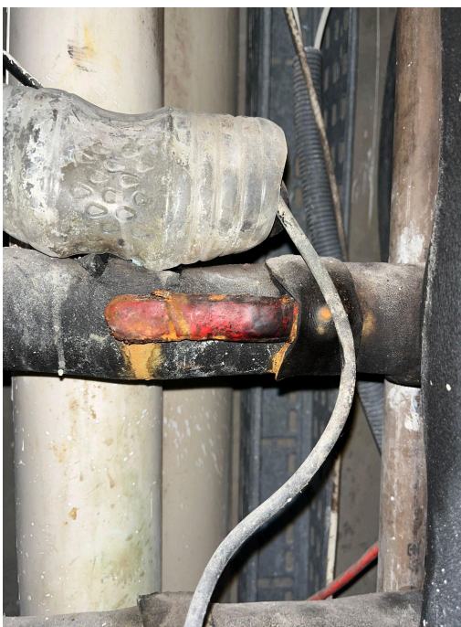
Figura 30 - Registros em estado avançado de corrosão
