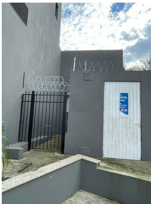
Figura 114 - Casa de gás externa
