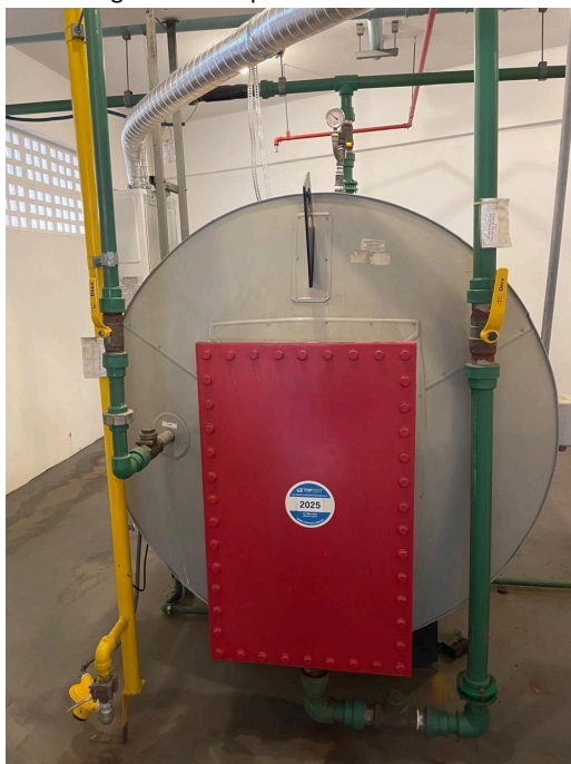
Figura 56 - Corpos do Boiler Torre 02
