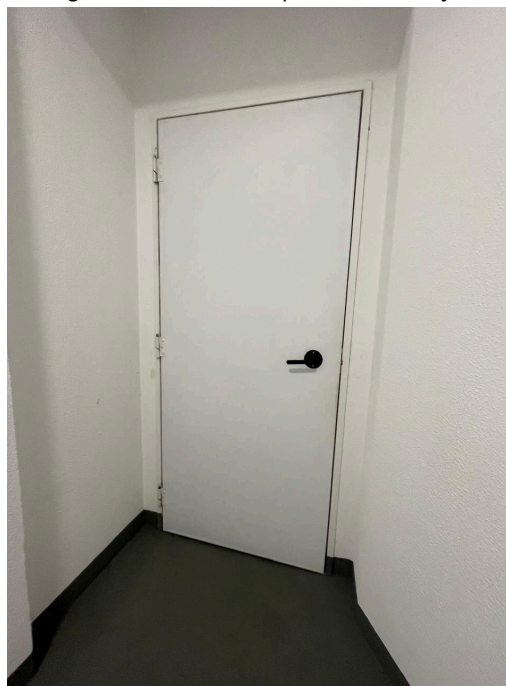
Figura 33 - Ausência de placa de sinalização
