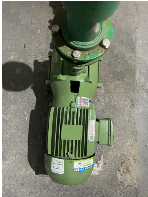
Figura 51 - Bomba de recalque 02 - Cisternas 02 e 03.
