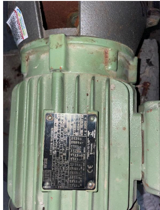
Figura 44 - Etiqueta Bomba de recalque 02.
