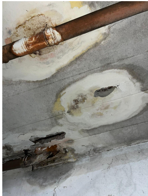
Figura 160 - Pontos de gotejamento teto SS1
