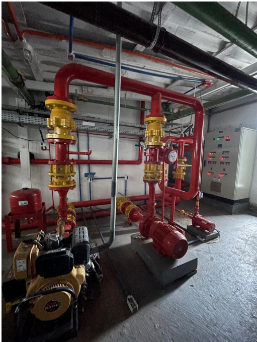
Figura 15 - Sistema de bombas.
