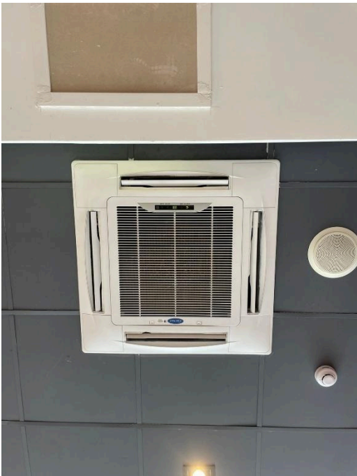
Figura 111 - Cassete área lobby
