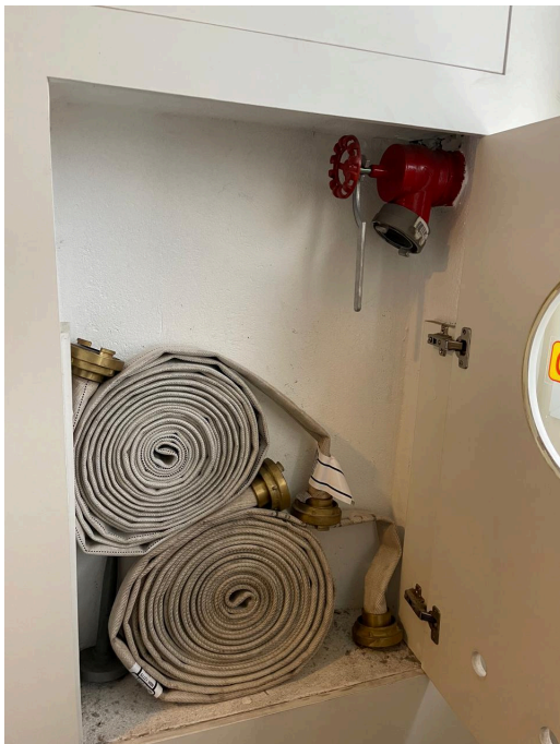
Figura 29 - Caixa de hidrante 11º andar Torre 01.
