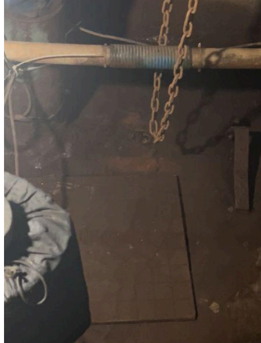
Figura 162 - Ponto de água no fundo do poço do elevador social esquerdo
