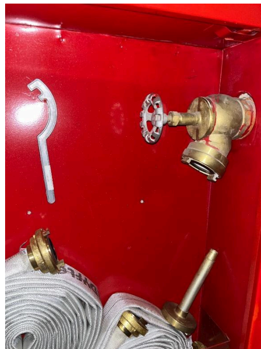
Figura 26 - Caixa de hidrante térreo
