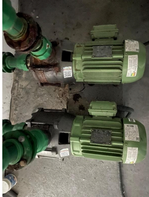
Figura 42 - Bombas de recalque.
