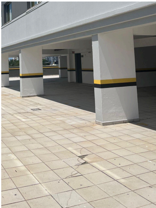
Figura 45 - Pisos danificados G2
