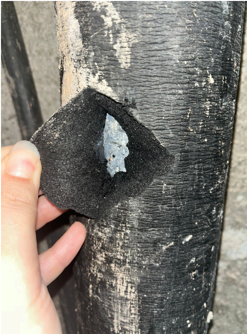
Figura 111 - Tubulações com isolamento encharcadas prumada G1
