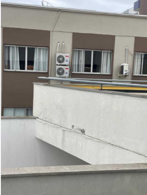
Figura 129 - Laje pavimento G2.
