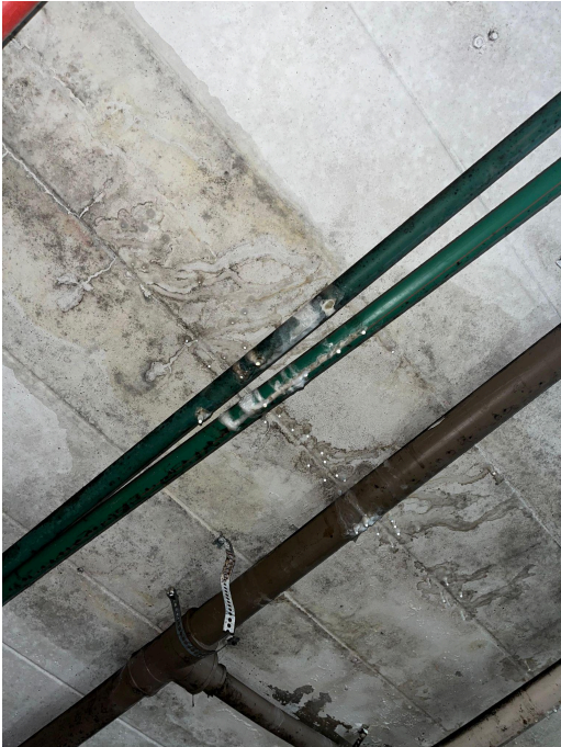
Figura 157 - Pontos de gotejamento teto SS1
