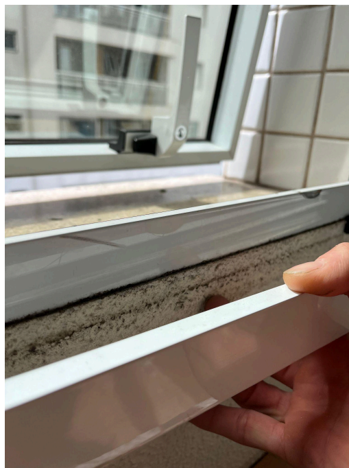
Figura 126 - Estrutura das esquadrias
