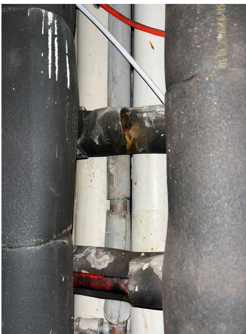
Figura 32 - Registros em estado avançado de corrosão
