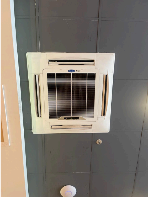
Figura 109 - Cassete área lobby
