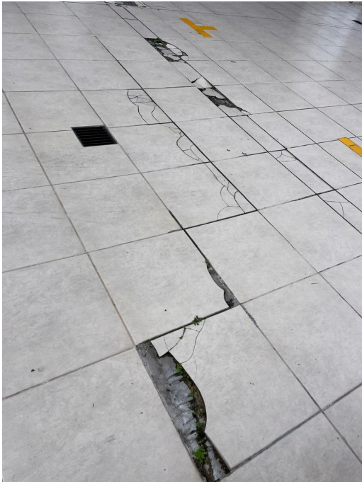
Figura 140- Pisos quebrados G1.
