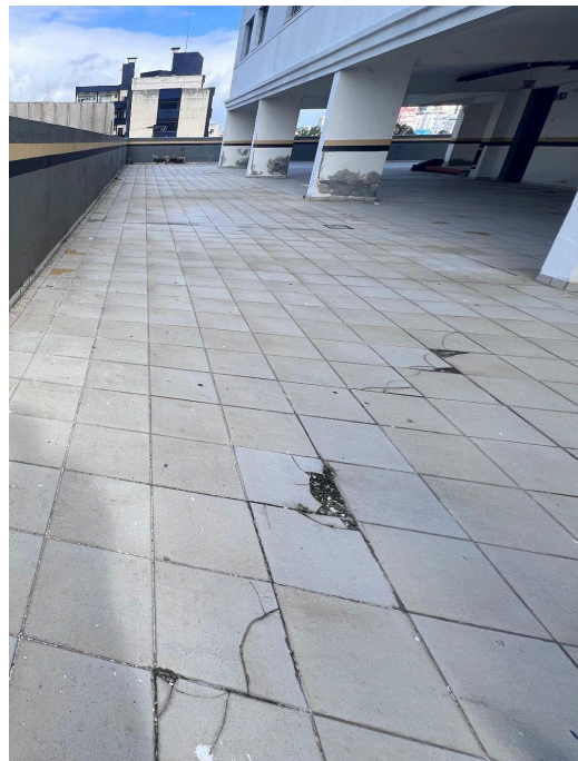
Figura 46 - Pisos danificados G2
