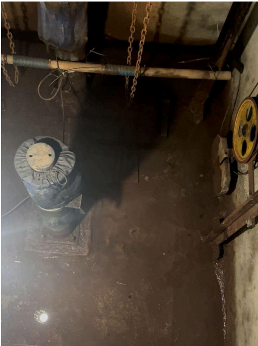
Figura 161 - Acúmulo de água no fundo do poço do elevador social esquerdo
