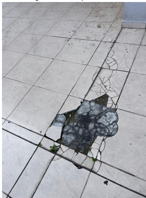
Figura 139- Pisos quebrados G2.
