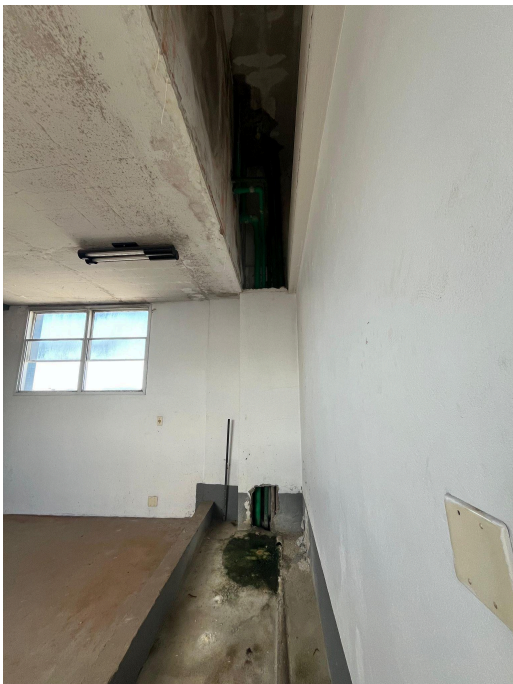
Figura 47 - Mofos e manchas nas paredes e teto
