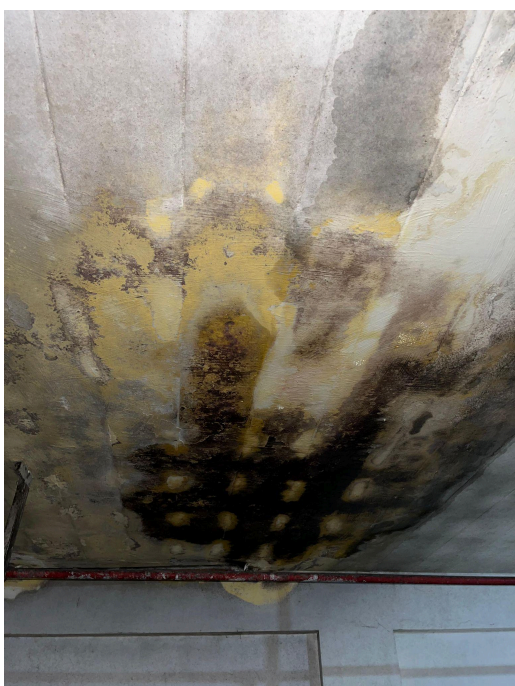
Figura 155 - Infiltração Teto SS1
