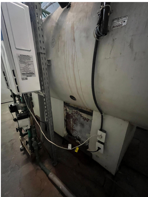
Figura 84 - Aquecedor e tomadas de alimentação
