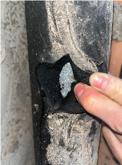
Figura 107 - Isolamento encharcado (G2)
