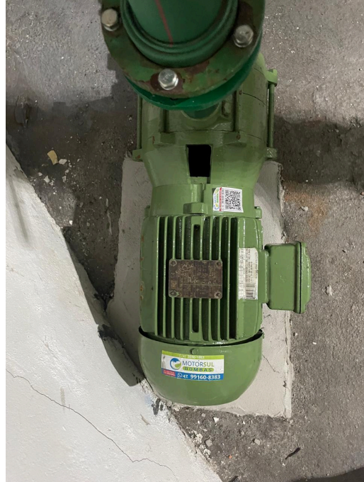
Figura 50 - Bomba de recalque 01 – Cisternas 02 e 03.
