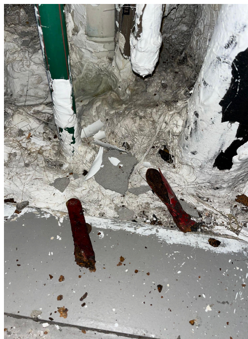
Figura 31 - Registros em estado avançado de corrosão
