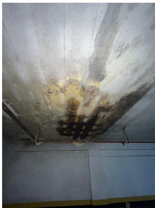
Figura 156 - Infiltração Teto SS1
