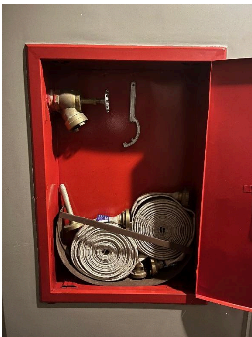
Figura 23 – Caixa de hidrante 11° andar
