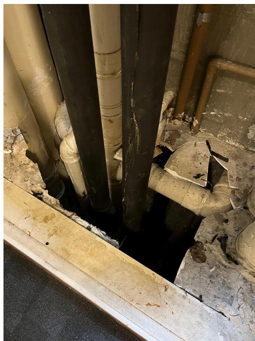
Figura 42 - Isolamento de shaft danificado
