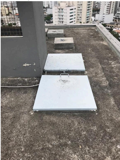
Figura 34 - Caixas 01 e 02 Torre 1
