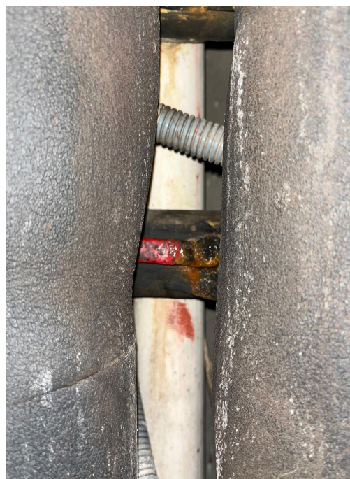
Figura 33 - Registros em estado avançado de corrosão
