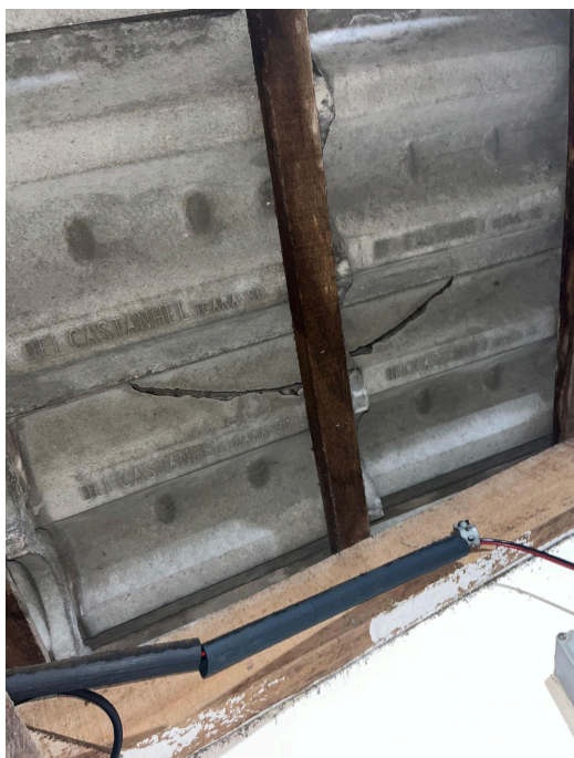
Figura 149 - Pisos danificados e ausentes na garagem subsolo
