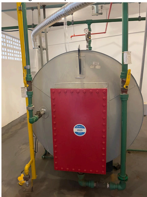
Figura 54 - Corpos do Boiler Torre 02
