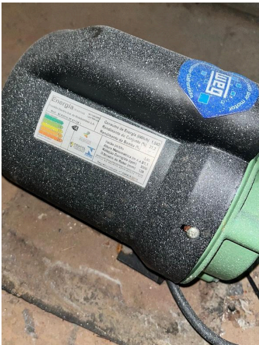
Figura 88 - Etiqueta de identificação bomba 1
