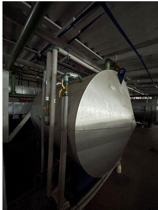
Figura 53 - Corpos do Boiler Torre 01.
