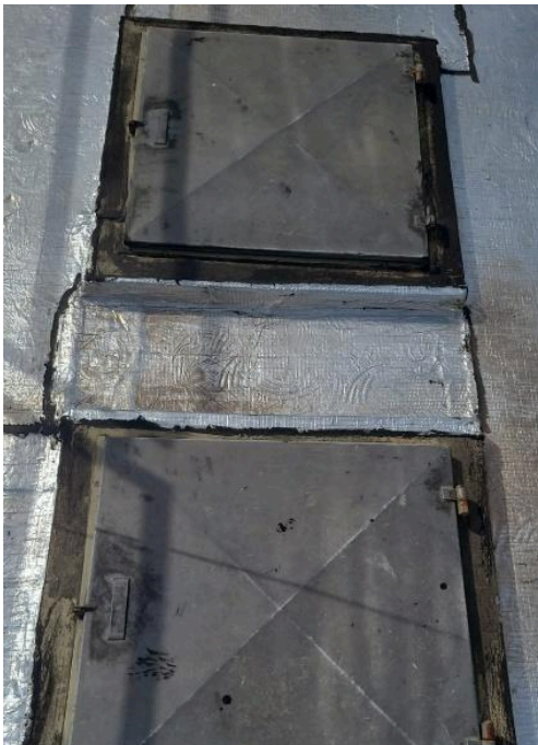
Figura 37 - Caixas 01 e 02 Torre 02
