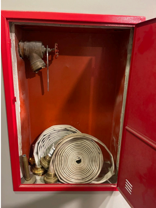
Figura 27 - Caixa de hidrante 5º andar Torre 02.
