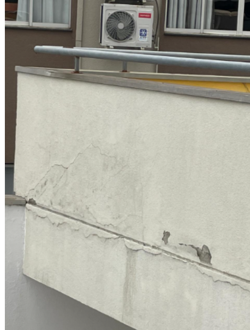
Figura 130 - Laje pavimento G2.
