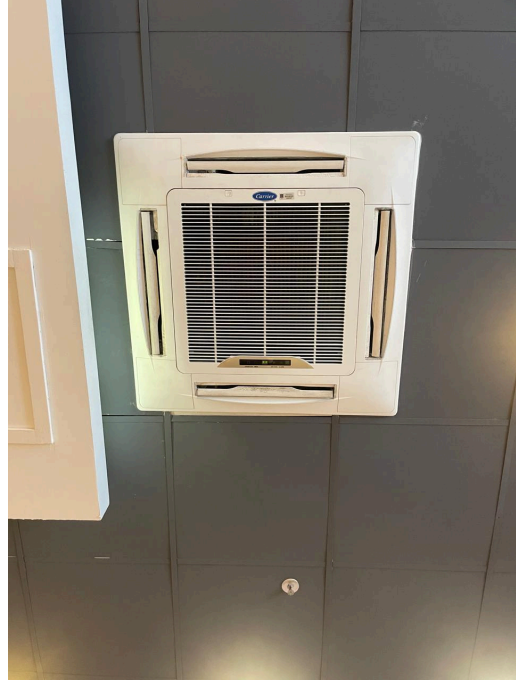
Figura 110 - Cassete área lobby
