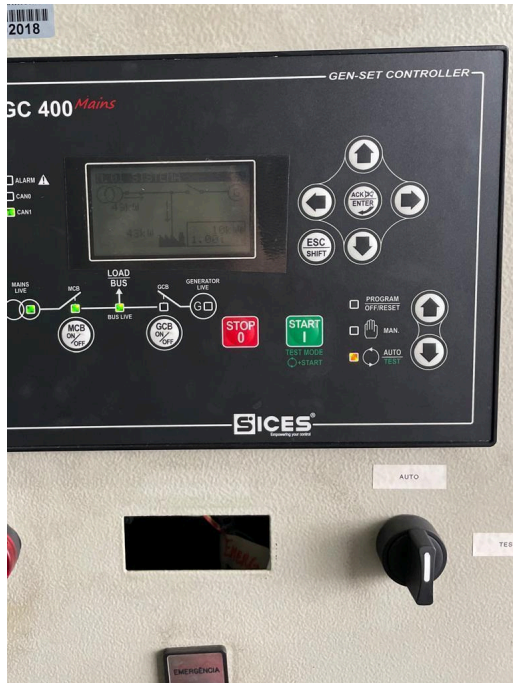
Figura 93 - Painel de controle do gerador.
