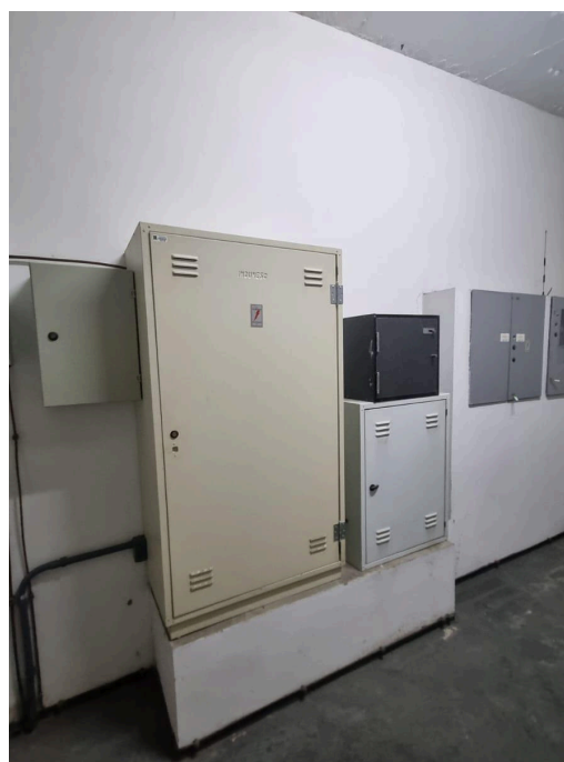
Figura 20 - Quadro e controladores
