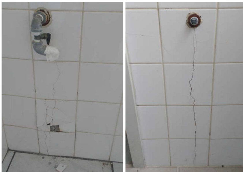
Figura 42– Problemas ocasionados nos revestimentos em função da corrosão
