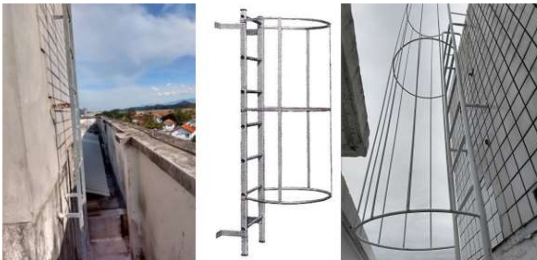
Figura 68 – Escada existente, modelo correto e escada marinheiro executada
