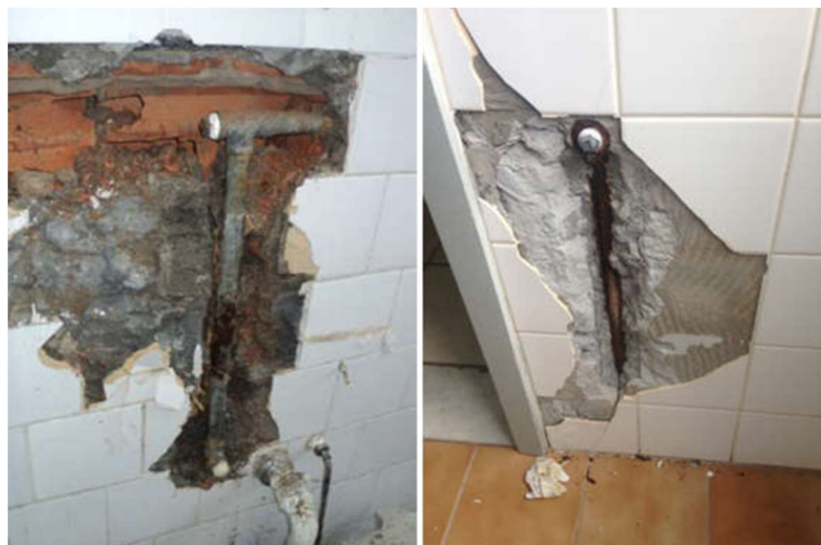
Figura 41 – Tubulações de gás em avançado estado de corrosão
