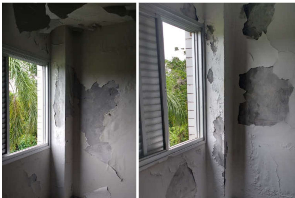
Figura 43 – Mais fotos dos problemas ocasionados nos revestimentos
