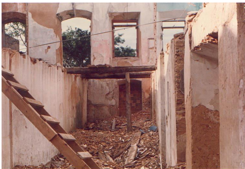
Figura 5 - Parte interna do Casarão Ferreira de Mello durante a reforma (década de 1980)
