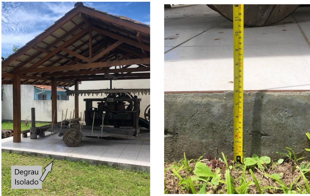
Figura 57 – Degrau isolado entre o Pátio Externo 02 e o Engenho
