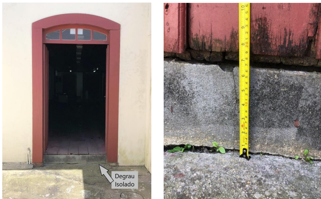
Figura 54 – Degrau isolado no acesso entre a Sala 01 e o Pátio Externo 03
