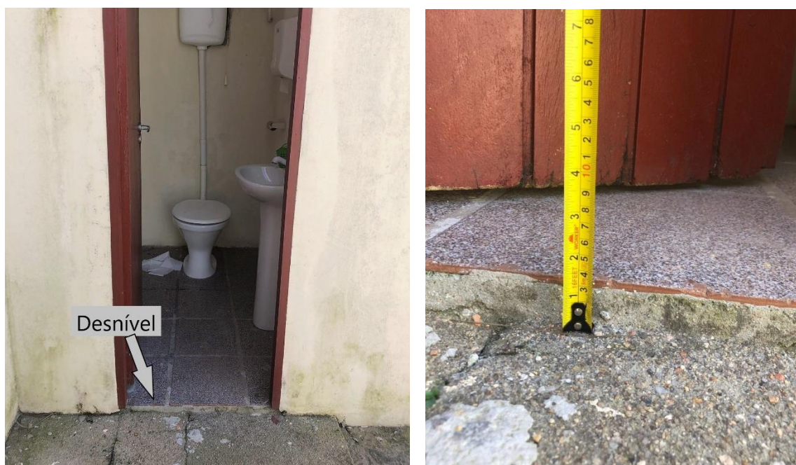
Figura 56 – Desnível na entrada do Lavabo 03
