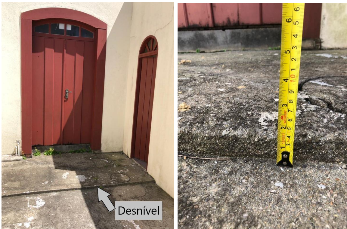
Figura 55 – Desnível no Pátio Externo 03
