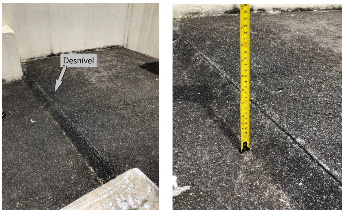
Figura 58 – Desnível no Pátio Externo 01
