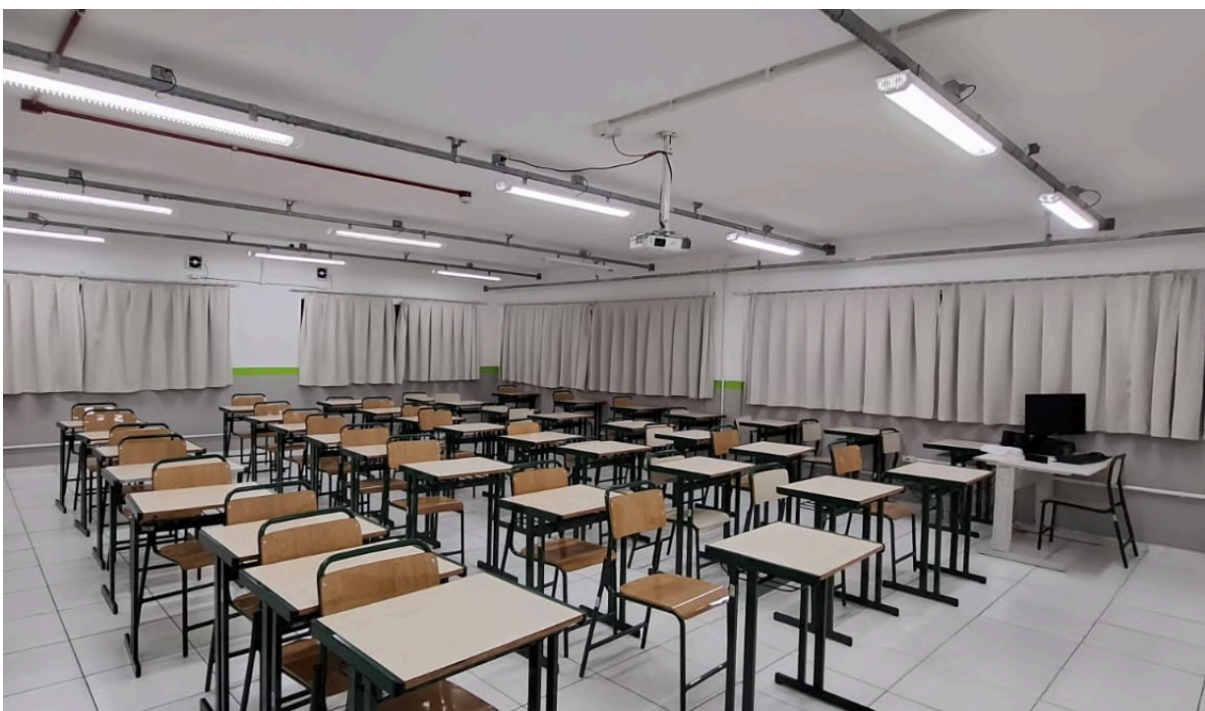
Figura 32 – Iluminação existente - Sala 620
