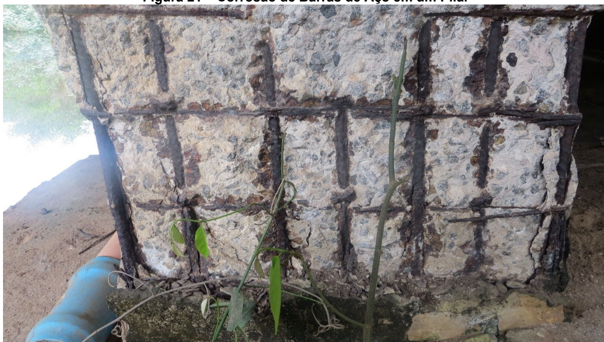
Figura 21 – Corrosão de Barras de Aço em um Pilar
