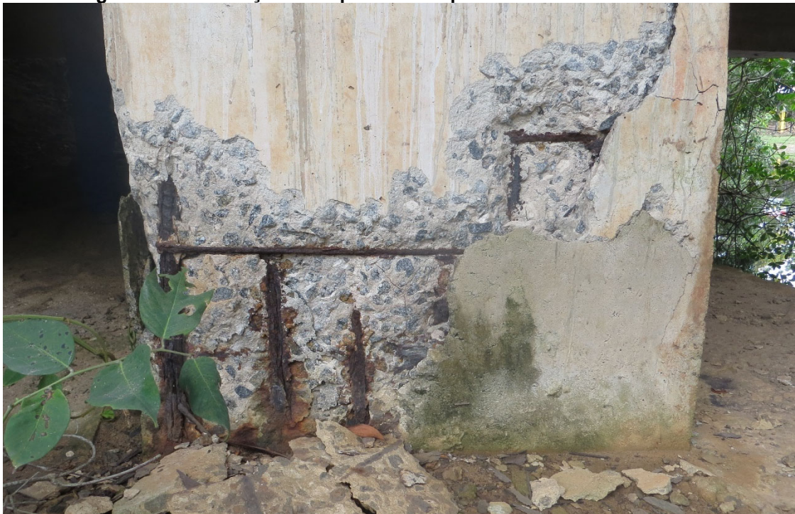
Figura 20 – Fissuração e Deslocamento por Falta de Ganchos no Pilar
