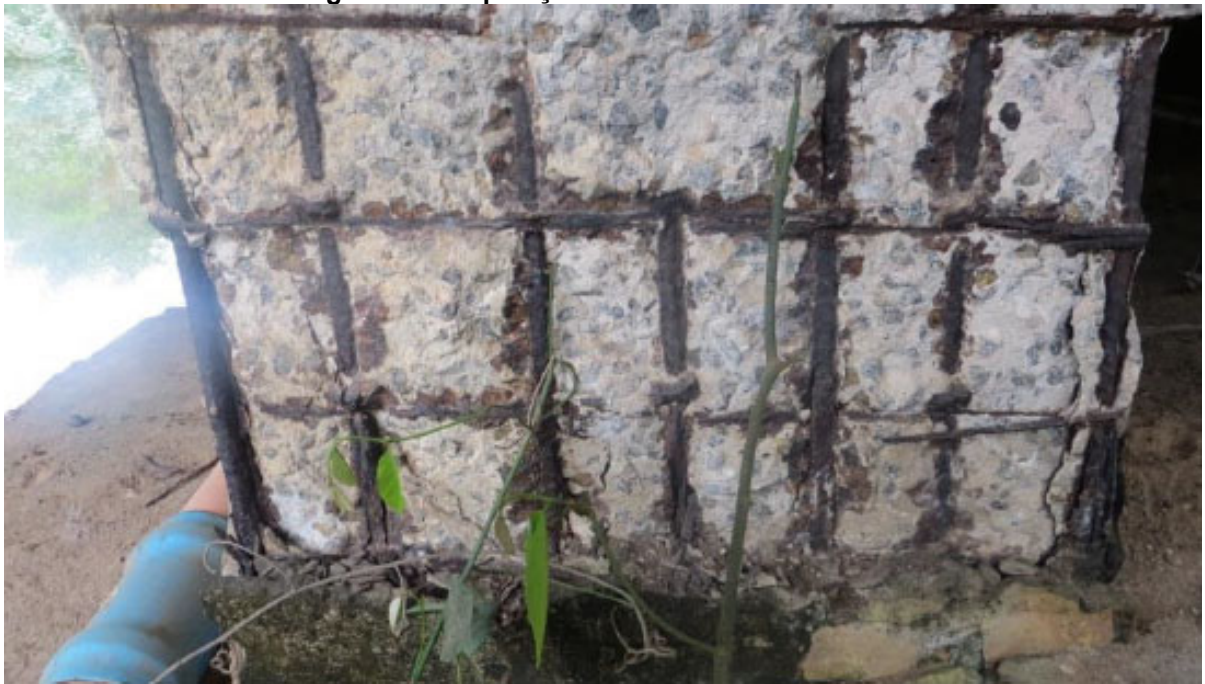
Figura 38 – Exposição e Corrosão da Armadura
