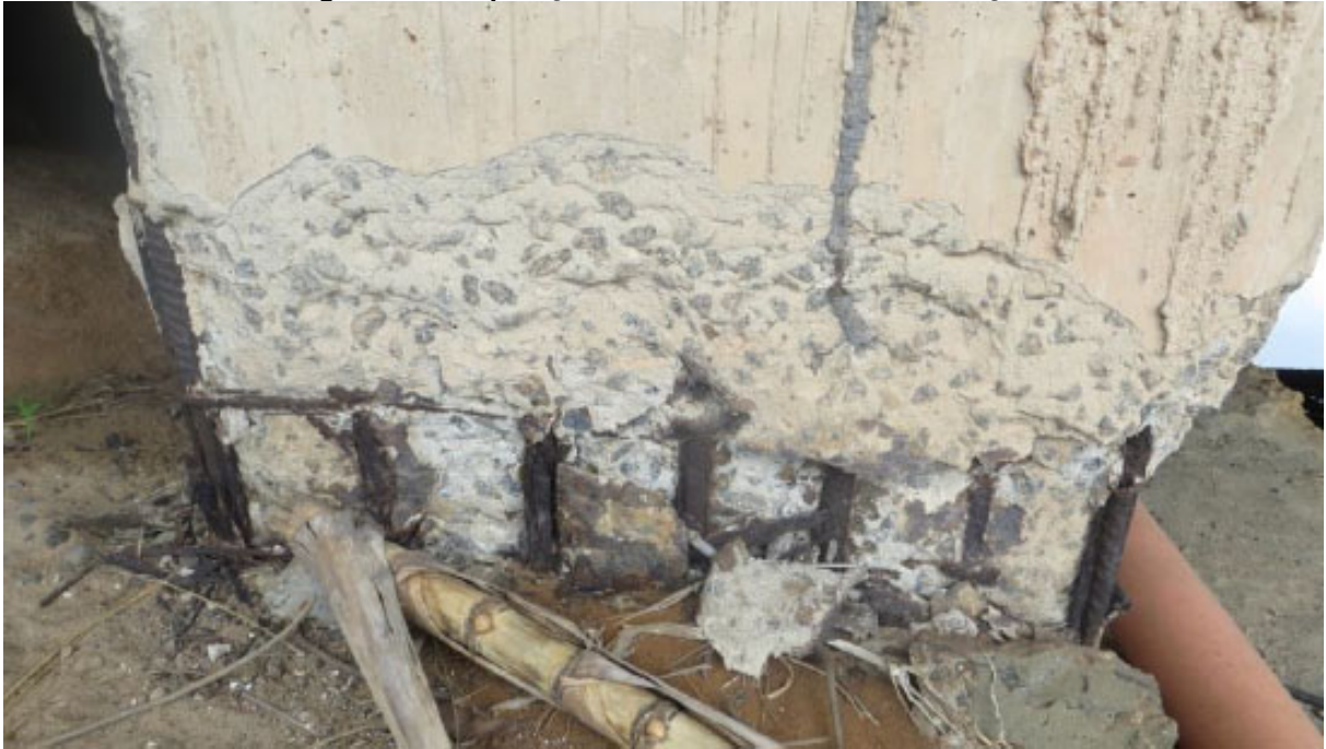
Figura 37 – Exposição da Armadura e Perda de Seção
